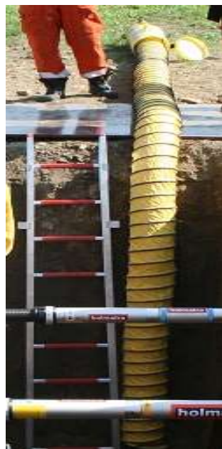
Fot. 12. Wentylator nawiewno – wywiewny
