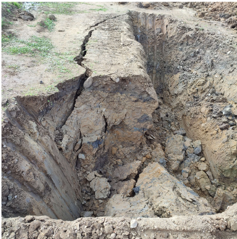
Fot. 6. Odpadnięcie fragmentu ściany wykopu
