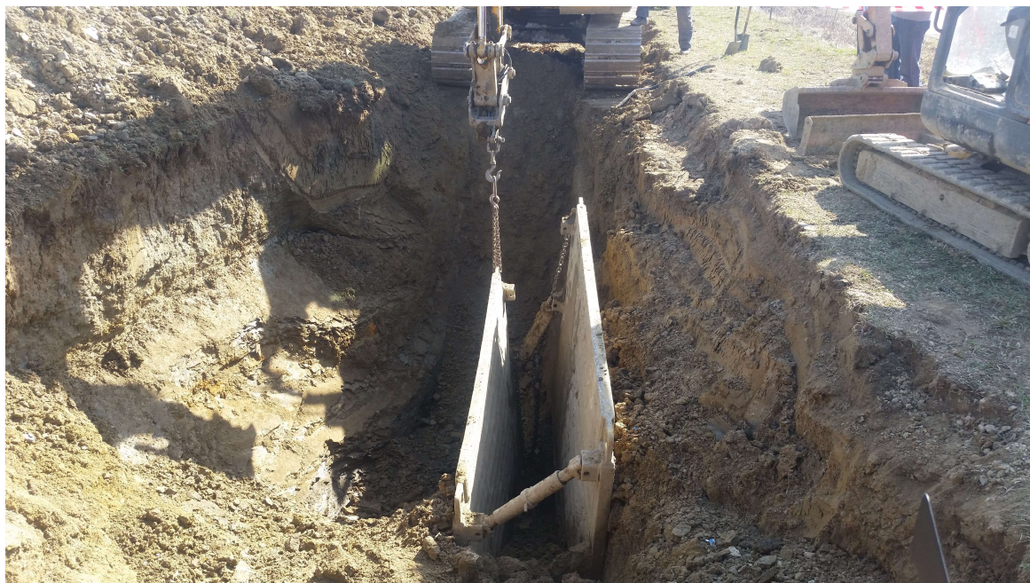
Fot. 9. Osunięcie stosu urobku
