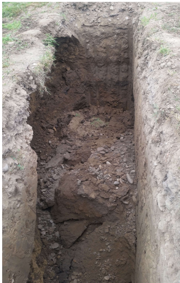
Fot. 8. Osunięcie brzucha wykopu
