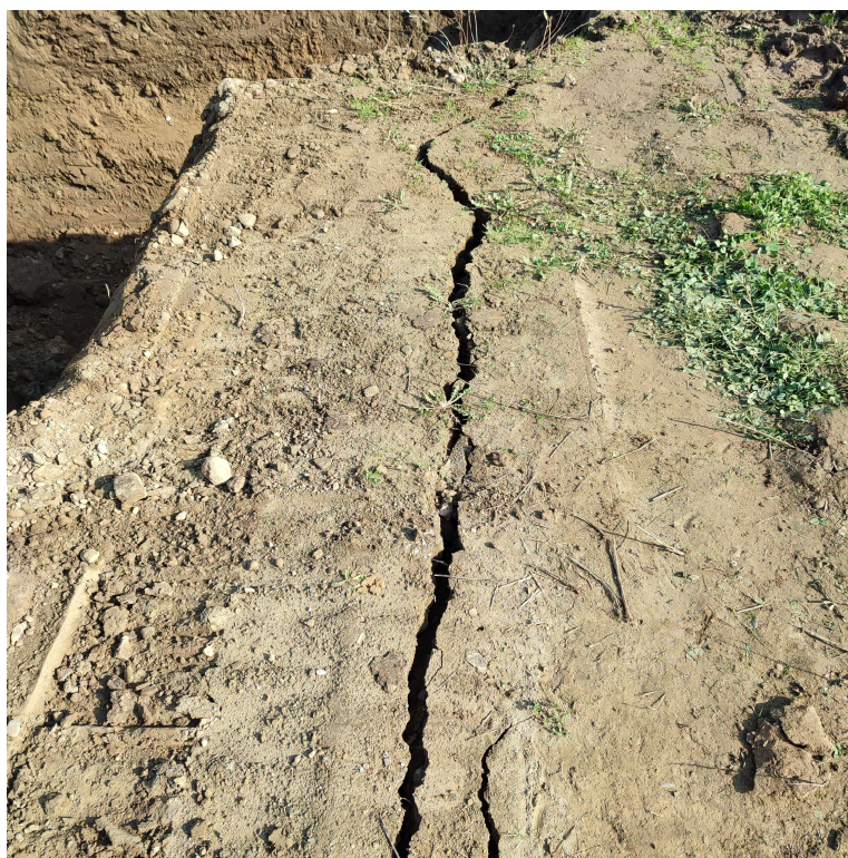
Fot. 5. Pęknięcia podstałe wzdłuż brzożu wykopu
