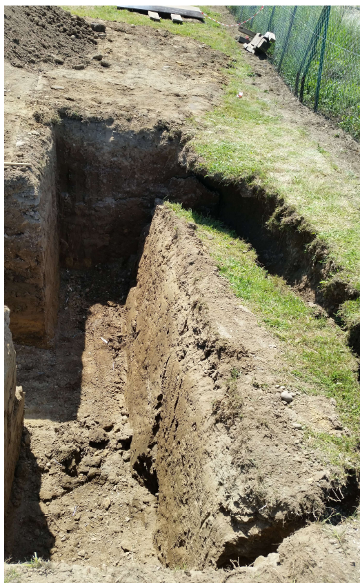
Fot. 7. Odpadnięcie ściany wykopu
