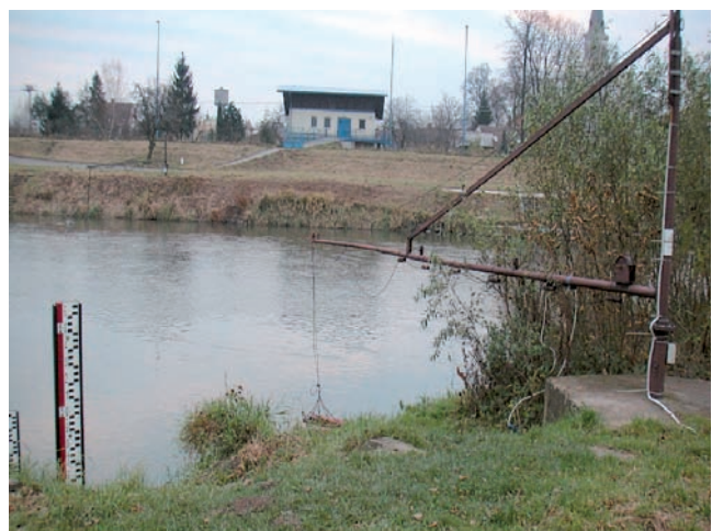
Fot. 5. Sonda pomiarowa zainstalowana na ASBJWO (K. Gawęł)
