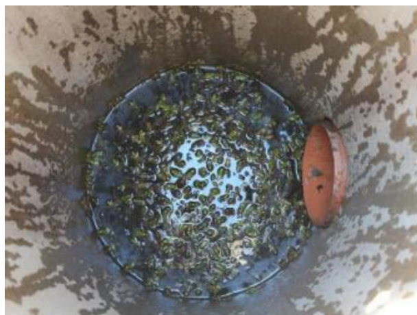
Płazy uwięzione w studzience kanalizacyjnej
