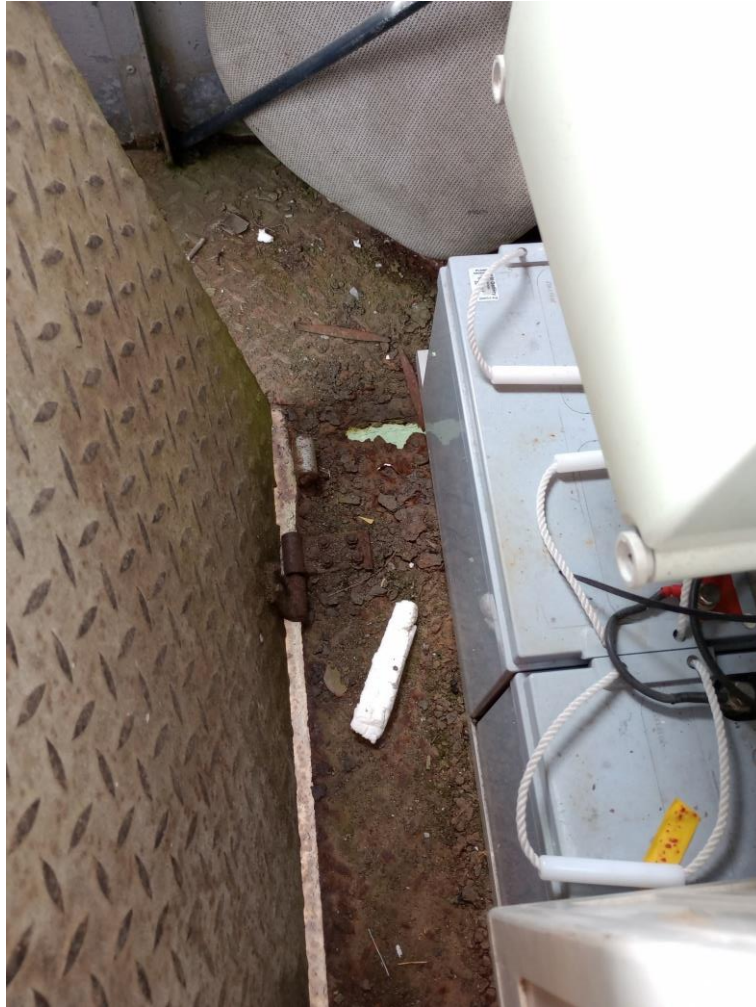
Fot. 21 – Kabina obserwacyjna – podłoga
