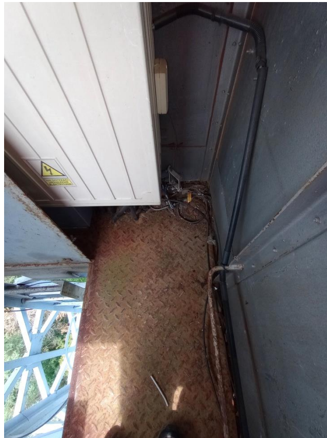
Fot. 20 – Kabina obserwacyjna – podłoga
