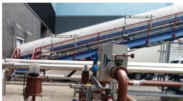
Zdjęcie taśmociągu - źródło hałasu
