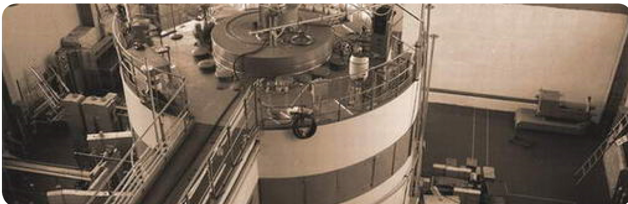
Fot. 2. Hala reaktora EWA ok. 1965 r. w dawnym Instytucie Badań Jądrowych (obecnie w Zakładzie Unieszkodliwiania Odpadów Promieniotwórczych) w Świerku
