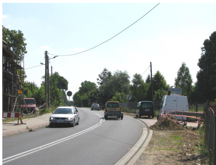
Fot. 3. Janów, RB1. Badany odcinek ul. Częstochowskiej (DK 46) w kierunku centrum miejscowości
