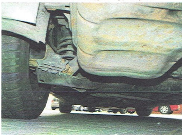
Fot. nr 21 zawieszenie TL, tłumik wydechowy - skorodowane
