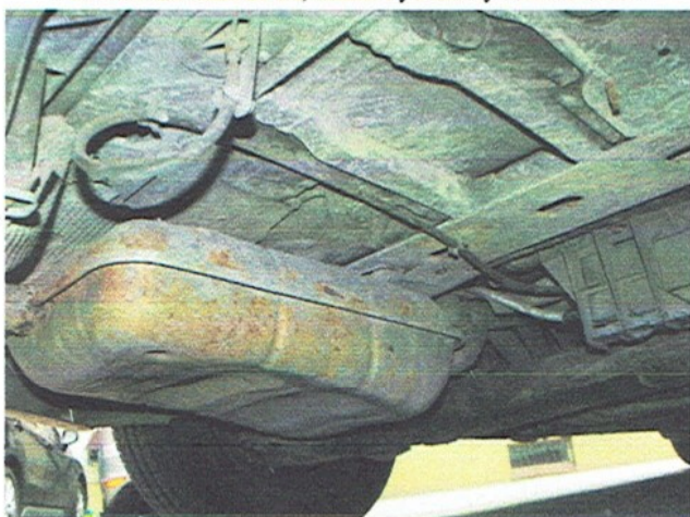
Fot. nr 23 tłumik wydechowy - skorodowany
