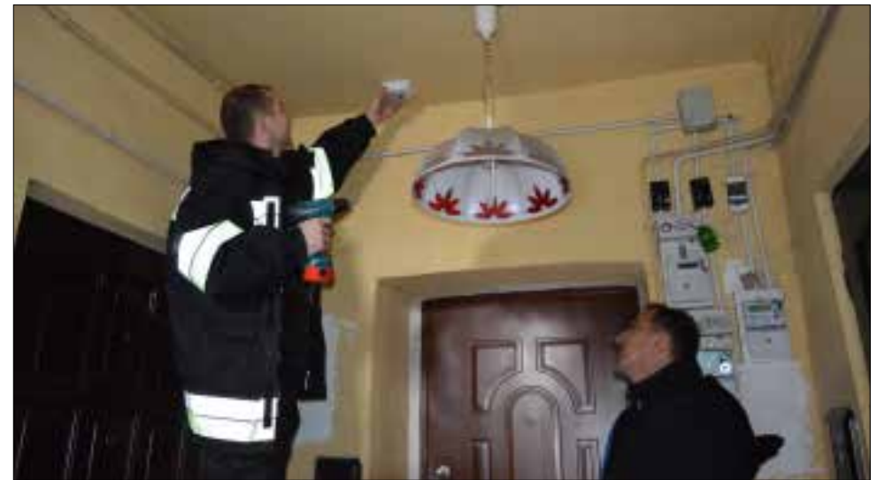
Kontrola budynków wielorodzinnych w Kolaszkach połączona z montażem czujek dymu i gazu, przeprowadzona przez kpt. Mateusza Kotynię.
