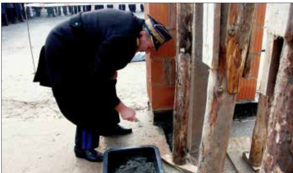
3 listopada 2003 roku odbyła się uroczystość wmurowania aktu erekcyjnego pod rozbudowę budynku koluszkowskiej strażnicy. Na zdjęciu Komendant Wojewódzki PSP nadbryg. Tadeusz Karcz.
