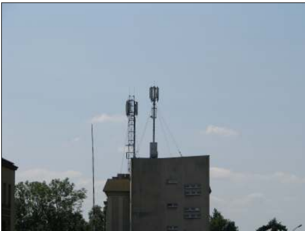
Fot. 3. Fragment instalacji radiokomunikacyjnych przy ul. Sienkiewicza
