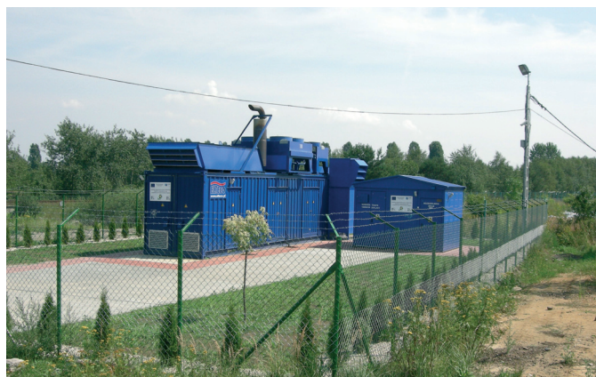
Fot. 1. Instalacja odgazowania kwater składowiska odpadów komunalnych w Tychach wraz z gospodarczym wykorzystaniem biogazu (zdjęcie: Międzygminne Przedsiębiorstwo Gospodarki Odpadami i Energetyki Odnawialnej MASTER Sp. z o.o., Tychy)
