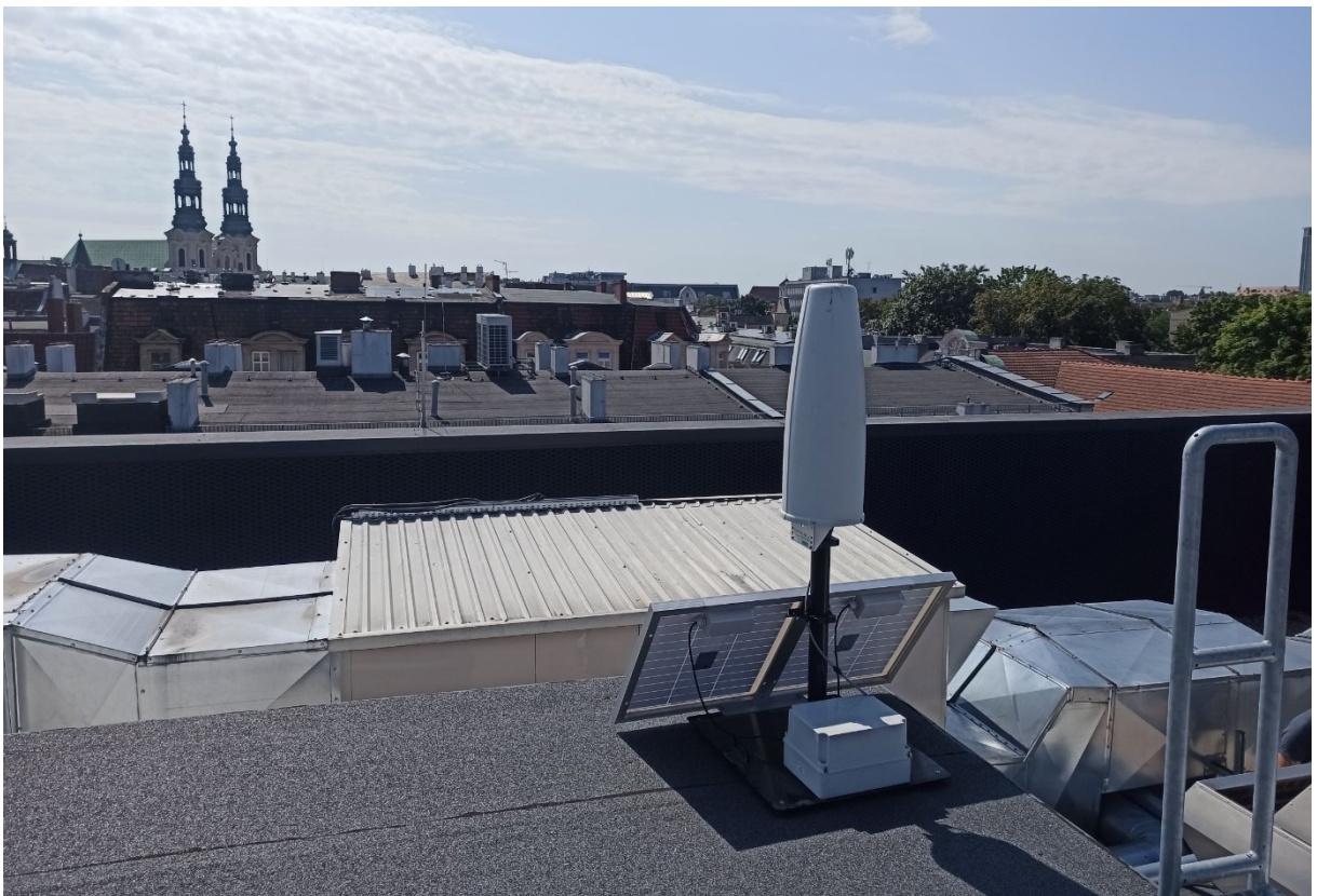
Rys. 3 Miejsce montażu SELMS PEM – Budynek biurowy w Poznaniu – widok na stację bazowe
