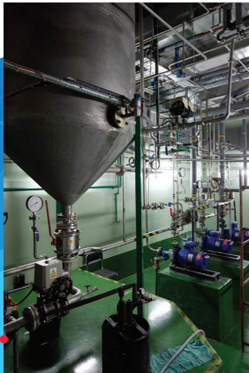
Linia przetwarzania niskoaktywnych odpadów promieniotwórczych
