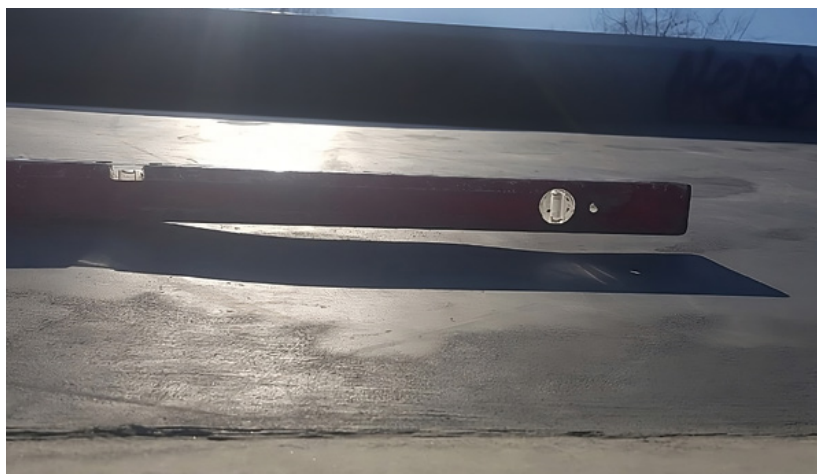
Fot.6.7.2 Nierówno zatarta nawierzchnia jezdna elementu
