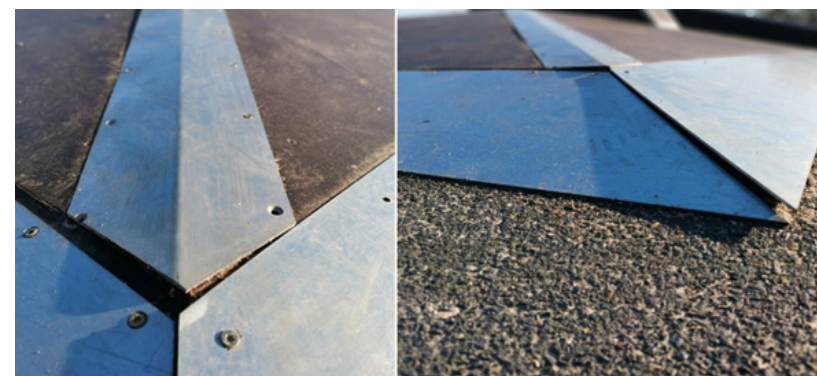
Fot.7.7.8 Błędna instalacja stalowych okuć przeszkód skateparku
