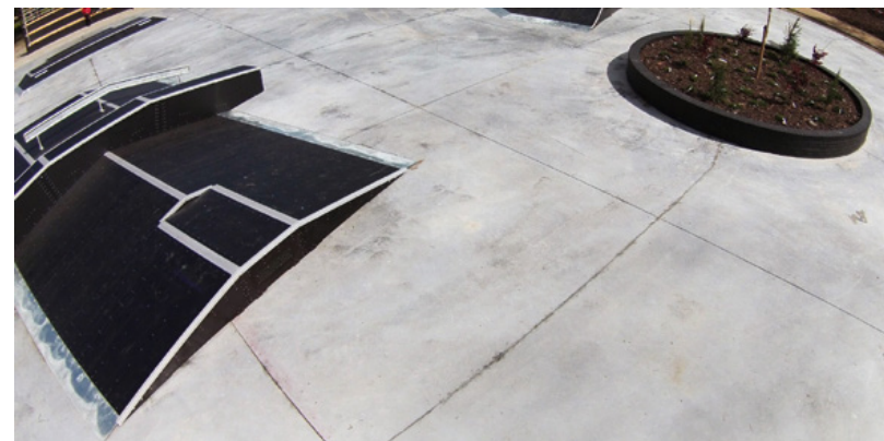
Fot. 7.2.1 Skatepark betonowy w Piszcu z widoczną dylatacją na nawierzchni
