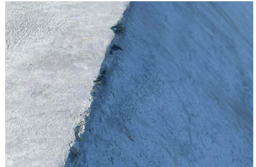
Fot.6.7.5 Odpryski betonu na krawędziach
