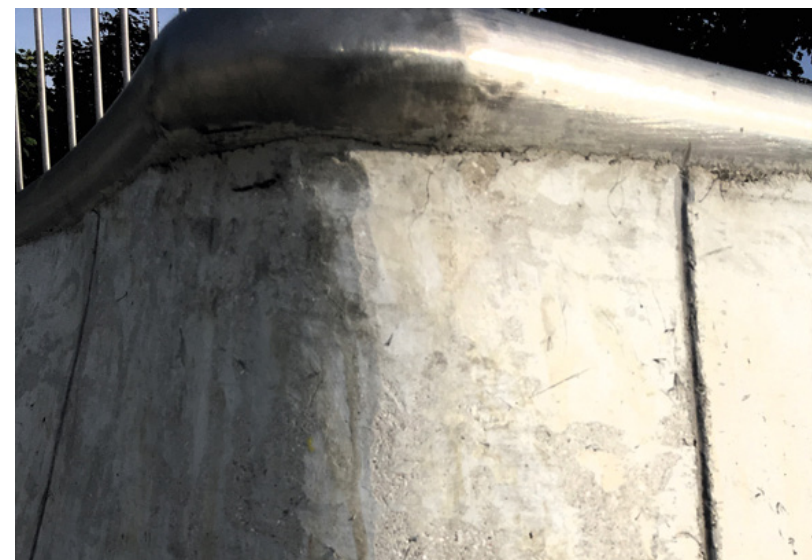
Fot.6.7.3 Błędne osadzenie Coppingu
