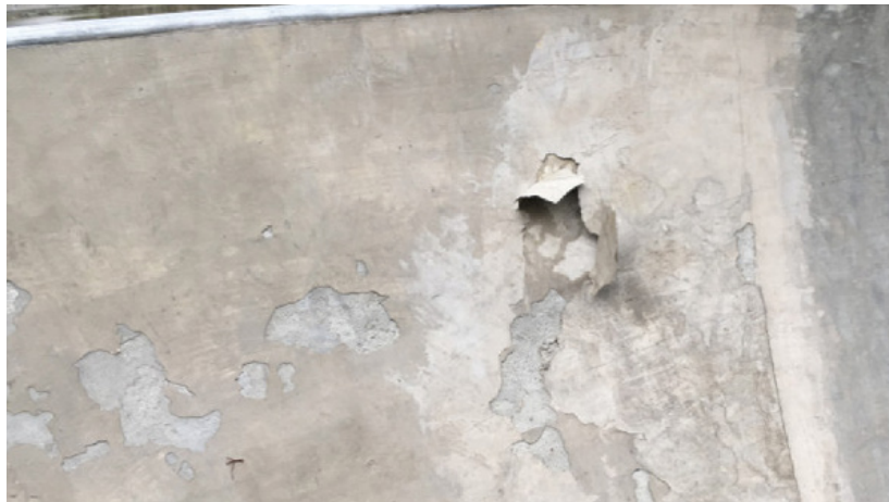
Fot.6.7.6 Odpadająca szpachlówka
