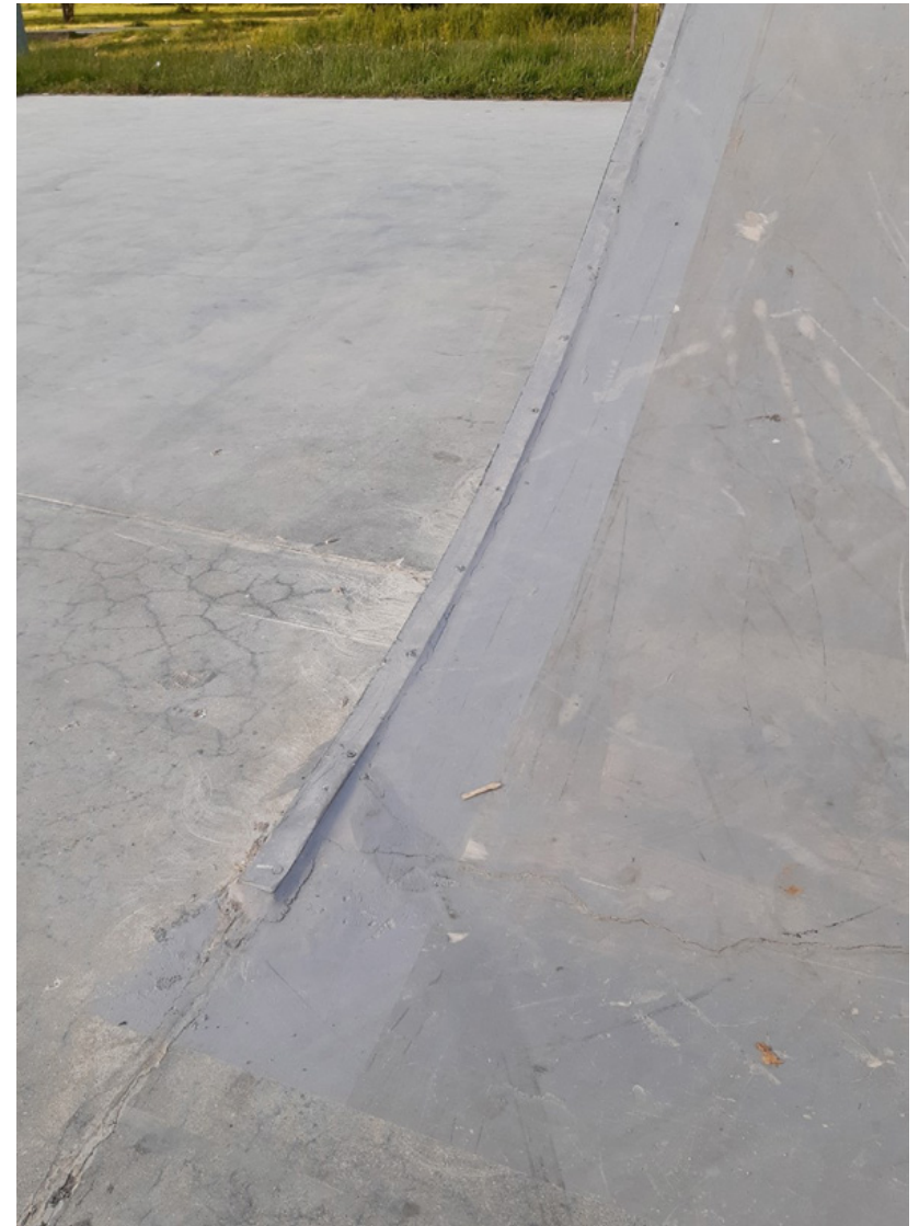
Fot.6.7.7 Nieprawidłowo osadzone i zabezpieczone ostre krawędzie
