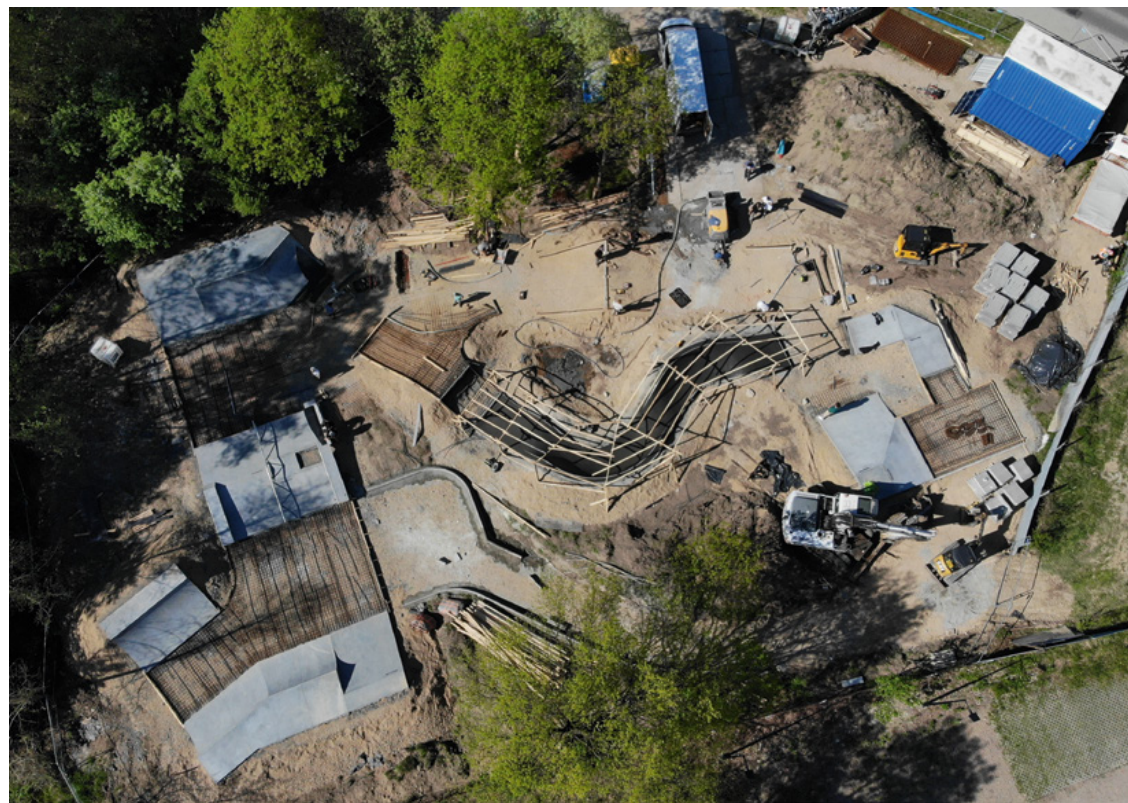
Fot.6.6.4 Zbrojenia na budowie skateparku w Bystrej Podhalańskiej Fot.6.6.5 Budowa skateparku w Krakowie przy ul. Kąpielowej
