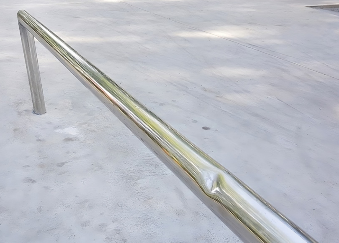
Fot.6.7.4 Przykład zastosowania Poręczy ze zbyt cienką ścianą
