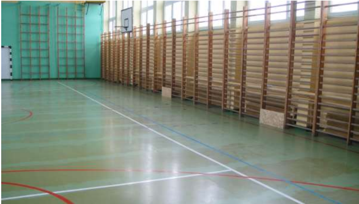
Fot. 18 – sala gimnastyczna Zespołu Szkół Ponadgimnazjalnych nr 2 w Gryfinie przed remontem.
