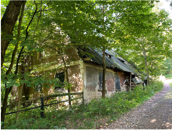
widok z zewnątrz obiektu – widok na elewację wschodnią i północną od strony drogi – ul. Wczasowa, widoczna zawalona część budynku od strony zachodniej
