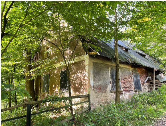
widok z zewnątrz obiektu – widok na elewację wschodnią i północną od strony drogi – ul. Wczasowa, widoczna zawalona część budynku od strony zachodniej
