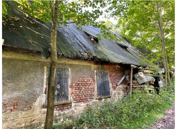
widok z zewnątrz obiektu – widok na elewację północną bliżej zawalonej części budynku
