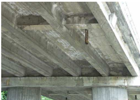
Rys. 3.110. Rozległe przecieki świadczące o braku szczelności izolacji
