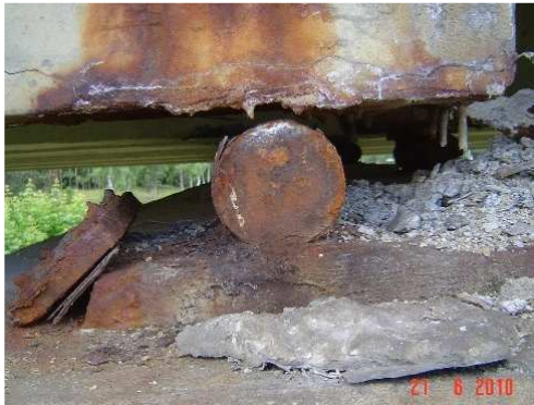
Rys. 3.221. Łożysko stalowe wałkowe skorodowane i zanieczyszczone – w stanie awaryjnym. Płyta górna wypadła zwałka
