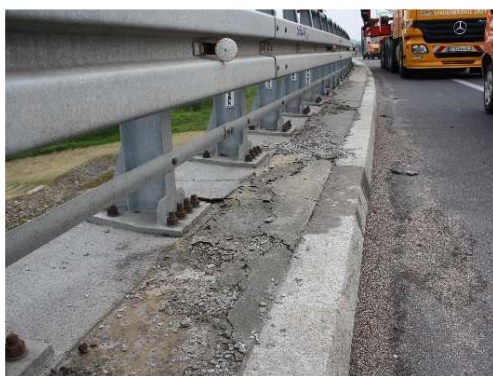
Rys. 3.41. Złuszczenie i ubytki nawierzchni z żywicy epoksydowej, korozja i ubytki betonu pod nawierzchnią. Zniszczenia występują na ponad 30% powierzchni poboczny technicznych wyniesionych
