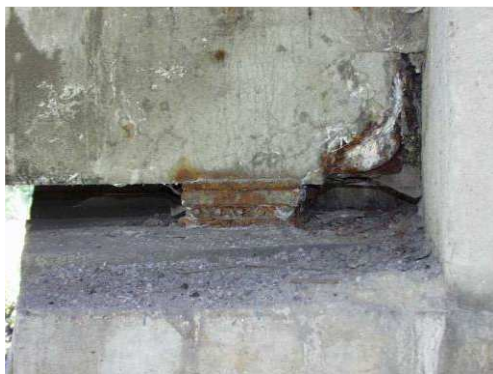
Rys. 3.217. Łożysko stalowe płaskie, stałe, powierzchniowo skorodowane i zanieczyszczone
