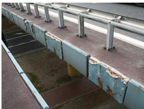
Rys. 3.78. Korozja i ubytki betonu na ok. 25% liczby wbudowanych żelbetowych desek gzymsowych, korozja odsłoniętego zbrojenia prefabrykatów gzymsowych, zniszczenie antykorozyjnych powłok malarskich
