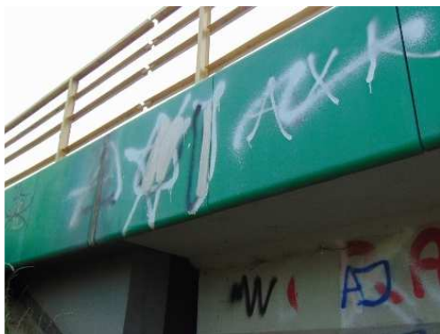
Rys. 3.72. Rozległe zanieczyszczenia graffiti pogarszające estetykę obiektu
