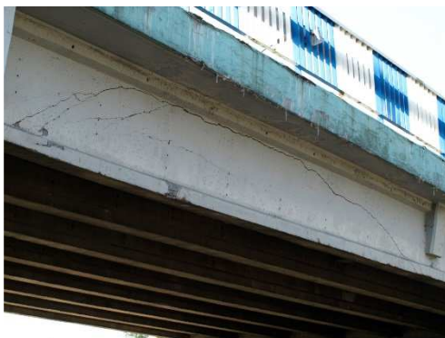
Rys. 3.172. Zniszczenie skrajnej belki typu WBS na skutek uderzenia przez pojazd nienormalny, pęknięcie środnika, ubytki i zarysowanie betonu, możliwe zerwanie splotów sprężających oraz prętów zbrojenia miękkiego
