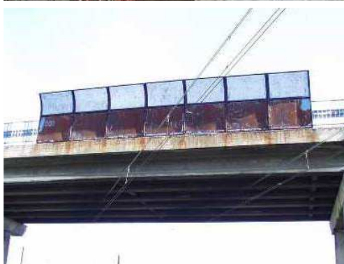
Rys. 3.69. Silna korozja osłony przeciwporażeniowej, perforacja elementu
