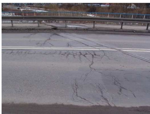
Rys. 3.22. Pęknięcia siatkowe, niewielkie ubytki i deformacje (koleiny), obniżenie nawierzchni przy kształtownikach urządzeń dyfuzyjnych, silne zanieczyszczenie piaskiem jezdni w strefach ścieków przykrawężnikowych
