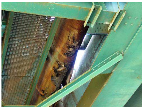
Rys. 3.370. Korozja perforacyjna osłony i ubytki izolacji ciepłociągu
