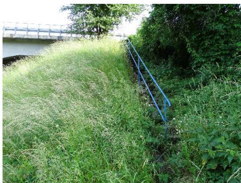
Rys. 3.1. Zbyt bujna wegetacja roślin (traw, drzew, krzewów) występująca na ponad 30% powierzchni stożków, zagrażająca ich trwałości. Wegetacja mchów na schodach skarpowych, korozja i ubytki betonu stopni schodów
