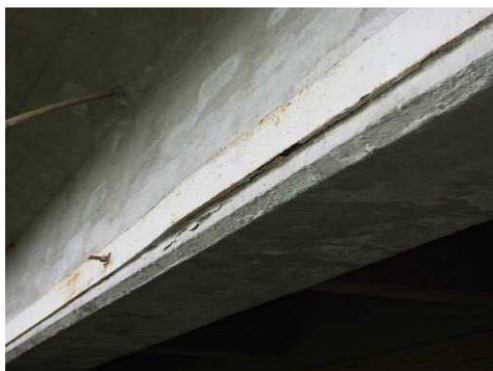
Rys. 3.181. Zniszczenie połączenia klejowego pomiędzy dźwigarem żelbetowym a wzmacniającym go płaskownikiem stalowym
