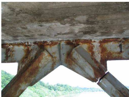
Rys. 3.194. Pęknięcie krzyżulca dźwigara kratownicowego, korozja elementów dźwigara. Stan przedawaryjny
