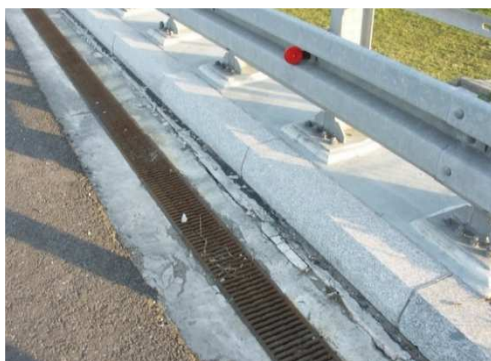
Rys. 3.90. Korozja stalowych elementów odwodnienia liniowego w strefie ścieku przykrawężnikowego, zniszczenie zaprawy cementowej w strefie styku technologicznego ścieku z krawężnikami – nieprawidłowe spoinowanie na całej długości ścieku
