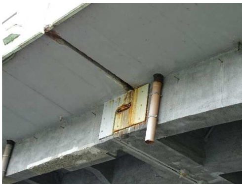
Rys. 3.312. Przecieki wody, beton skorodowany w obrębie przegubu, korozja blachy wzmacniającej boczne powierzchnie przegubu
