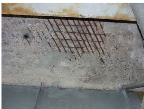
Rys. 3.124. Ubytki i korozja betonu oraz korozja zbrojenia na ok. 10% powierzchni płyty pomostu
