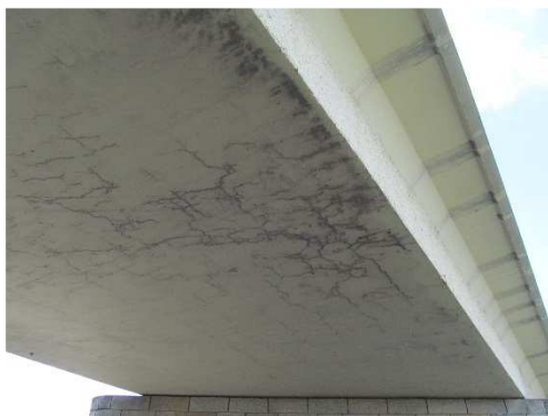
Rys. 3.154. Rozległa siatka rys skurczowych na spodniej powierzchni dźwigara płytowego, zawilgocenie wzdłuż rys
