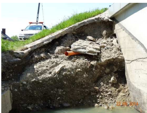
Rys. 3.12. Osunięcie i rozmycie stożka nasypu powodujące odsłonięcie skrzydełka oraz stan awaryjny nasypu przy przyczółku. Całkowite zniszczenie betonowych umocnień stożków
