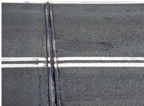
Rys. 3.236. Zanieczyszczenie urządzenia dylatacyjnego ograniczające przesuw przęsła, nierówności i spękania nawierzchni w bezpośrednim sąsiedztwie urządzenia
