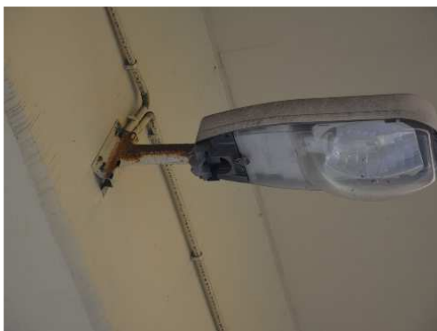
Rys. 3.390. Niesprawność oświetlenia pod wiaduktem – uszkodzona jedna z dwóch lamp, korozja zamocowania lampy
