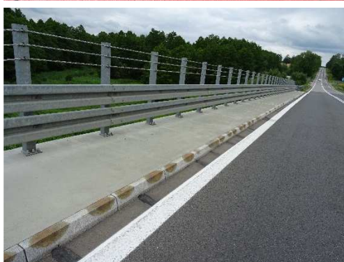
Rys. 3.43. Przebarwienia na krawężnikach kamiennych obejmujące ponad 30% prefabrykatów wbudowanych w obiekt
