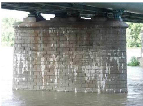
Rys. 3.268. Osady i wykwyty świadczące o korozji ługującej betonu
