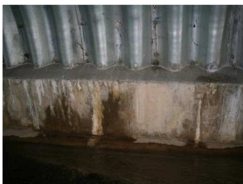
Rys. 3.265. Zacieki, osady i wykwity oraz wyługowania związków wapnia z betonu niskiego korpusu przyczółka konstrukcji gruntowo-powłokowej
