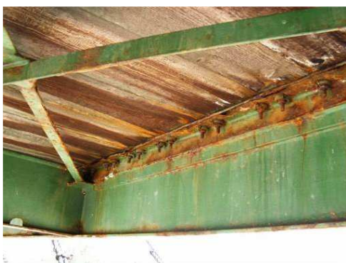
Rys. 3.142. Liczne zawilgocenia i przecieki oraz korozja drewna (gnicie) powodująca zmniejszenie przekroju o ok. 20%
