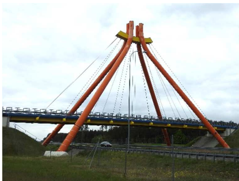
Rys. 3.290. Stalowy pylon o nietypowej konstrukcji wykazujący lokalne uszkodzenie antykorozyjnej powłoki malarskiej oraz zanieczyszczenie
