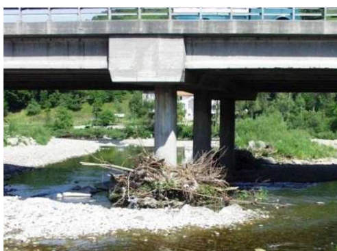
Rys. 3.296. Zanieczyszczenia gromadzące się przy filarze, utrudniające spływ wody i kry lodowej
