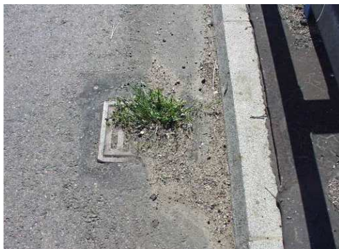
Rys. 3.87. Zanieczyszczenie powodujące całkowitą niedrożność odwodnienia
