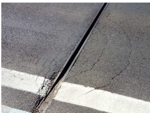
Rys. 3.31. Lokalne rysy, pęknięcia i wykruszenia nawierzchni w obrębie skrajnych profili stalowych modułowego urządzenia dylatacyjnego
