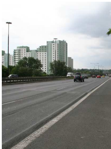
Rys. 3.19. Deformacje nawierzchni na wszystkich pasach ruchu na dojazdach – koleiny o głębokości do 30 mm uniemożliwiają dopływ wody opadowej do urządzeń odwadniających
