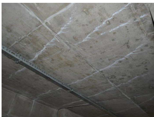
Rys. 3.127. Liczne rysy poprzeczne o rozwar-tości do 0.1 mm z białymi wyługowaniami oraz lokalne zawilgocenie na spodniej powierzchni płyty pomostu sprężonego dźwigara o prze-kroju skrzyńkowym
