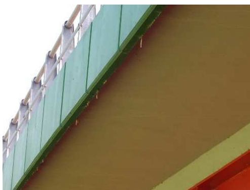
Rys. 3.114. Białe osady i stalaktyty na wewnętrznej powierzchni desek gzymsowych, izolacja wywinięta na boczną powierzchnię wspornika płyty pomostu, brak uszkodzenia izolacji
