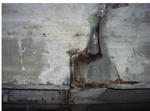
Rys. 3.309. Korozja i ubytki betonu w obrębie przegubu, korozja zbrojenia, zanieczyszczenia szczeliny dylatacyjnej, przecieki wody
