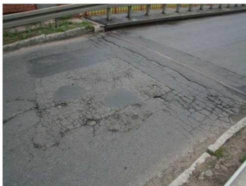
Rys. 3.21. Pęknięcia siatkowe, ubytki, obniżenie nawierzchni na dojeździe o ok. 25 mm i zanieczyszczenie jezdni przy krawężnikach
