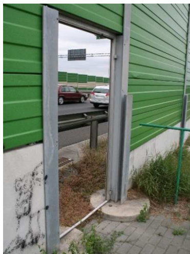
Rys. 3.331. Brak drzwi w ekranie przeciwhałasowym, zanieczyszczenie graffiti na panelach betonowych
