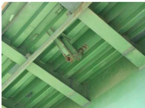
Rys. 3.133. Miejscowe zniszczenie powłoki antykorozyjnej
