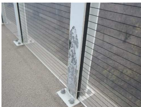
Rys. 3.335. Lokalne odspojenie uszczelniającej powłoki malarskiej na słupie ekranu przeciwhałasowego, biała korozja na odsłoniętej powłoce cynkowej
