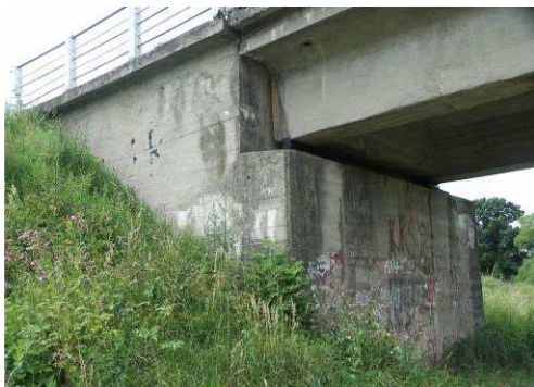
Rys. 3.251. Zanieczyszczenia (graffiti), osady i wykwyty, lokalne przecieki i korozja betonu
