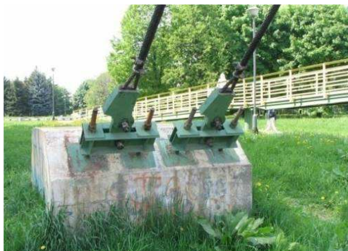
Rys. 3.347. Niewielka, nieprzekraczająca 5% powierzchni, korozja elementów stalowych zakotwienia ciągów, rysy skurczowe na betonowym bloku kotwiącym o rozwarości do 0.5 mm
