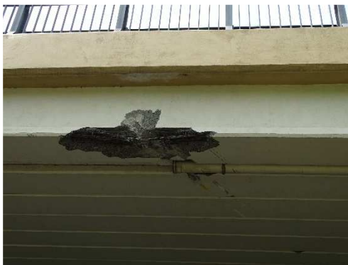
Rys. 3.171. Uszkodzenie skrajnej belki typu Kujan dźwigara płytowego na skutek uderzenia przez pojazd nienormalny, odprysk i zarysowanie betonu, zerwanie splotów sprężających oraz prętów zbrojenia miękkiego
