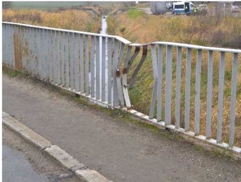
Rys. 3.57. Lokalne uszkodzenie balustrady, deformacja poręczy i szczeliny
