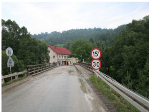
Rys. 4.4. Zły stan techniczny obiektu, zbyt mała nośność i ograniczenie prędkości
