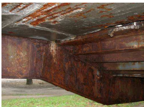
Rys. 3.377. Silnie zaawansowana korozja stali konstrukcyjnej, betonu i stali zbrojeniowej. Istotne osłabienie przekroju
