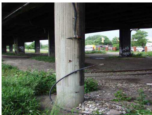
Rys. 3.372. Uszkodzenie instalacji uszynienia obiektu
