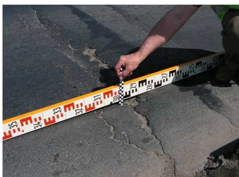
Rys. 3.237. Nierówności i ubytki asfaltu nad szczeliną dylatacyjną, w miejscu ucięcia nawierzchni. Stwierdzono niewielkie przecieki
