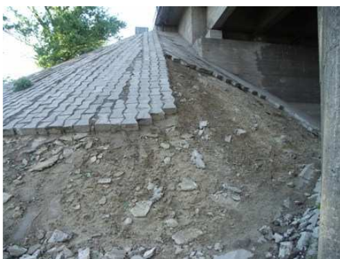
Rys. 3.14. Brak ok. 50% elementów betonowych umacniających stożek
