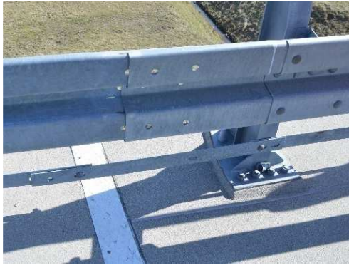
Rys. 3.56. Brak łączników śrubowych w prowadnicy bariery ochronnej nad szczeliną dy-latacyjną w chodniku
