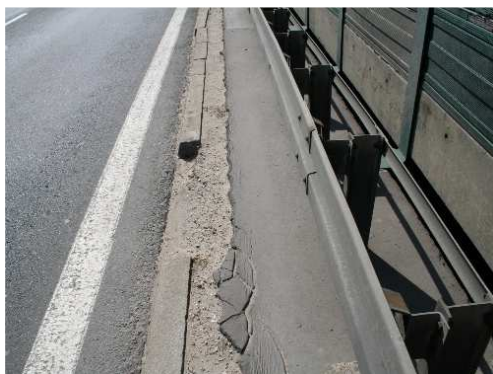
Rys. 3.45. Uszkodzenie pobocza technicznego wyniesionego. Krawężnik zniszczony w ok. 10%, ubytek i zarysowanie nawierzchni bitumicznej w ok. 30%, korozja i ubytek betonu wypełniającego kapę
