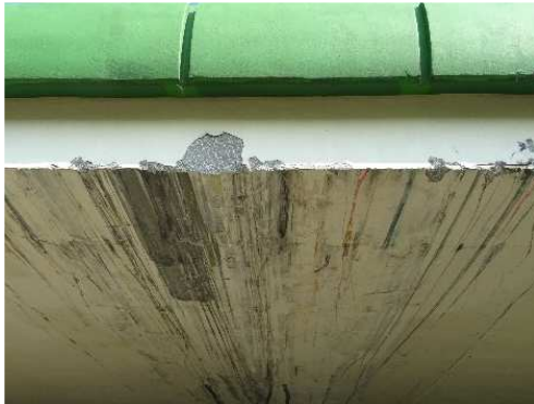
Rys. 3.170. Uszkodzenie dźwigara płytowego z betonu monolitycznego na skutek uderzenia przez pojazd nienormalny, odprysk i zarysowanie betonu, uszkodzenie antykorozyjnych powłok ochronnych
