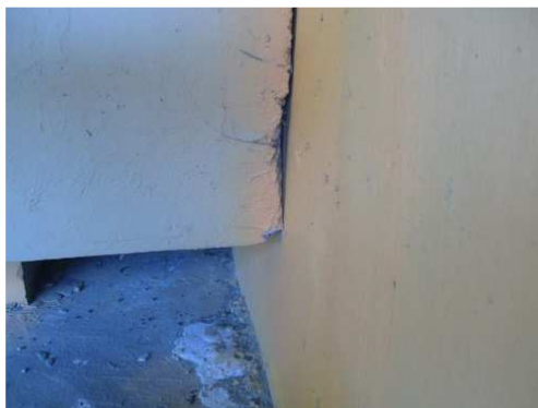
Rys. 3.257. Przemieszczenie poziome przyczółka. Brak szczeliny dylatacyjnej pomiędzy krawędzią dźwigara i ścianką nadłożyskową Kod uszkodzenia: PB Ocena: 1 Uwaga: konieczne jest wykonanie ekspertyzy
