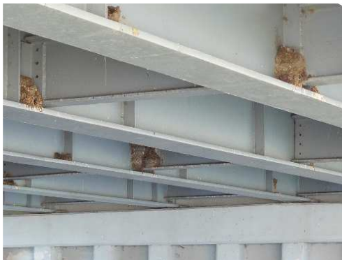
Rys. 3.185. Rozległe zanieczyszczenie środników i pasów dolnych dźwigarów blachownicowych ptasimi odchodami, sprzyjające uszkodzeniom powłok malarskich oraz korozji elementów stalowych
