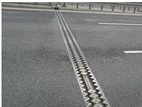
Rys. 3.247. Uszkodzenie dwumodułowego urządzenia dylatacyjnego – brak nakładek wyszczupiających (do 5%)
