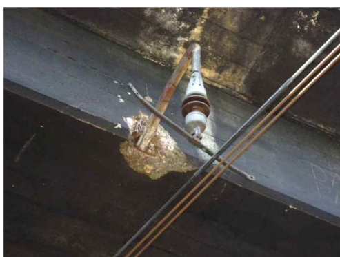
Rys. 3.373. Osłabienie zamocowania odbojnicy sieci trakcyjnej
