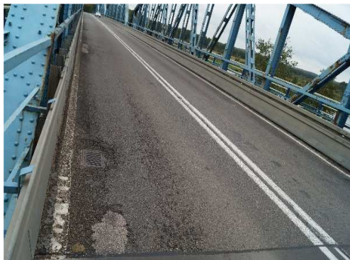
Rys. 3.32. Miejscowe wkruszenia i ubytki materiału nawierzchni, lokalne rysy i pęknięcia nawierzchni
