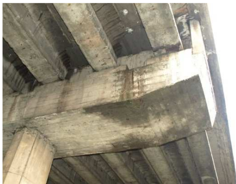
Rys. 3.281. Uszkodzenia oczepu filara spowodowane przeciekami przez nieszczelne urządzenie dylatacyjne. Zawilgocenie, zarysowania i osady, korozja odsłoniętego zbrojenia z powodu zbyt cienkiej otuliny
