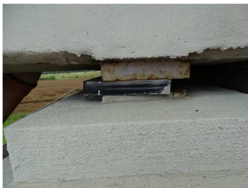
Rys. 3.215. Łożysko elastomerowe w wadliwym położeniu, uszkodzenie powłok malarskich, korozja powierzchniowa górnej blachy nadłożyskowej
