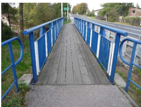
Rys. 3.141. Drewniany pokład podłużny pełniący funkcję pomostu oraz nawierzchni chodnika kładki. Przebarwienie i zawilgocenie desek wskazuje na zużycie się środków impregacyjnych
