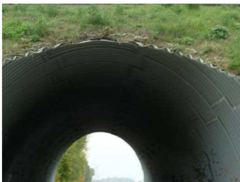
Rys. 3.84. Konstrukcja gruntowo-powłokowa, na której nie projektowano i nie wykonano gzymsu (wieńca betonowego)
