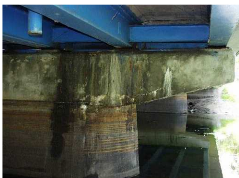
Rys. 3.270. Korozja betonu, zacieki, wykwyty, osady, rysy o rozwarości do 0.3 mm, miejscowa korozja zbrojenia
