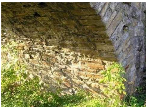
Rys. 3.206. Złuszczenia i ubytki elementów kamiennych, z których wykonano sklepienie. Ubytki nie przekraczają 5% powierzchni przekroju sklepienia
