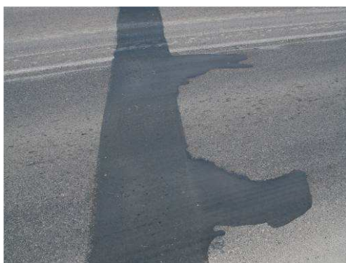
Rys. 3.240. Nierówności progowe, deformacja i przemieszczenie (rozwalcowanie) zawleki bitumicznej
