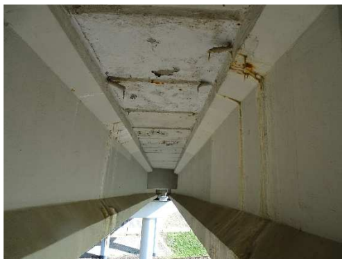
Rys. 3.120. Lokalny przeciek przez płytę pomostu, osady, wykwity oraz uszkodzenie antykorozyjnych powłok ochronnych
