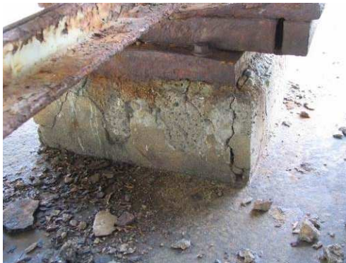
Rys. 3.273. Korozja betonu, rysy, pęknięcie i ubytki betonu ciosu podłożyskowego na filarze
