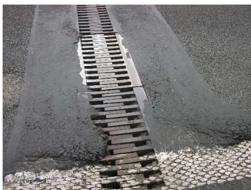
Rys. 3.250. Deformacja asfaltu lanego strefy przejściowej wzdłuż segmentów palczastego urządzenia dylatacyjnego, deformacje przekraczające 20 mm
