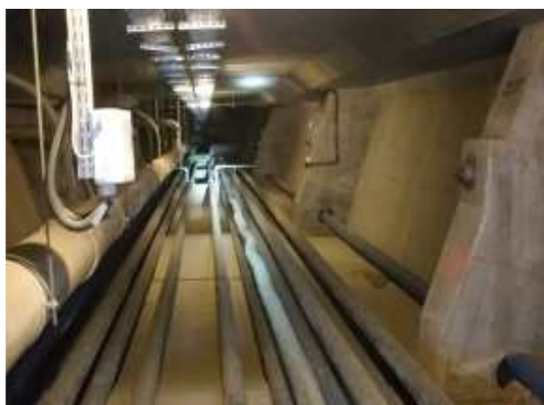
Rys. 3.359. Deformacja, wybrzuszenie osłony swobodnego kabla sprężającego we wnętrzu dźwigara o przekroju skrzynkowym, spowodowane prawdopodobnie zerwaniem lub spadkiem siły naciągu w części splotów kabla sprężającego
