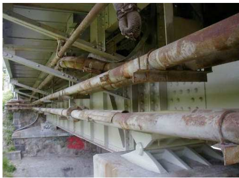
Rys. 3.366. Zniszczenie zabezpieczeń antykorozyjnych i korozja urządzeń obcych
