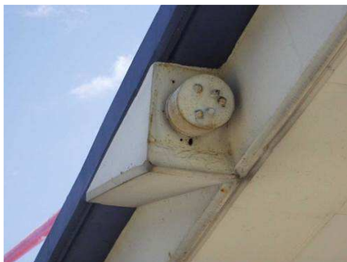
Rys. 3.346. Niewielkie zniszczenie zabezpieczeń antykorozyjnych zakotwienia wanty
