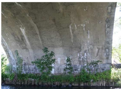
Rys. 3.163. Osady i wykwity spowodowane przeciekami przez sklepienie, świadczące o braku skuteczności izolacji
