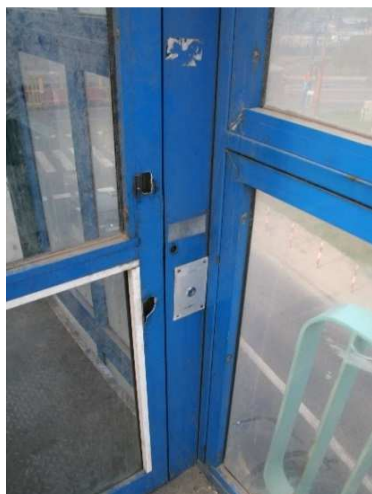
Rys. 3.380. Uszkodzenie elementów wyposażenia (urwane uchwyty/klamki do otwierania drzwi) uniemożliwiające użytkowanie windy
