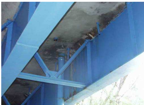
Rys. 3.107. Lokalne przecieki w sąsiedztwie wpustu i sączków – powierzchnia przecieków nieprzekraczająca 5% powierzchni płyty pomostu
