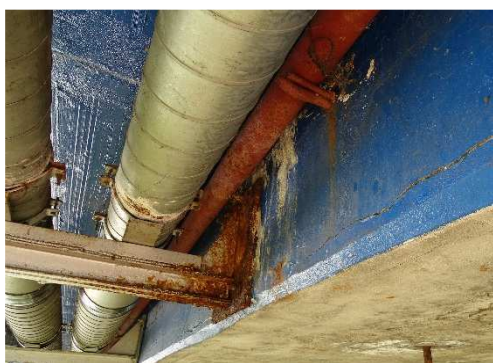
Rys. 3.371. Zaawansowana korozja wspornika podpierającego urządzenie obce. Wspornik przyczynia się do uszkodzeń dźwigara głównego
