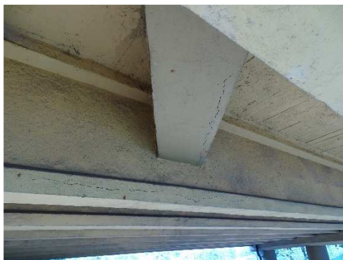
Rys. 3.159. Rysy podłużne na bocznej powierzchni pasa dolnego belki typu WBS oraz rysy wzdłuż dolnej krawędzi poprzecznicy
