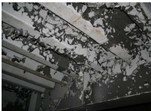
Rys. 3.134. Całkowite zniszczenie (złuszczenie) powłoki nawierzchniowej na wszystkich częściach pomostu ortotropowego przęsła o przekroju skrzynkowym
