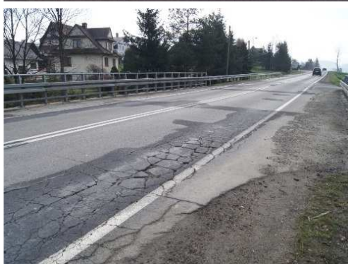
Rys. 3.23. Pęknięcia siatkowe, deformacje (koleiny) i ubytki nawierzchni na prawym pasie ruchu (do 20% powierzchni), silne zanieczyszczenie piaskiem nawierzchni poboczy utwardzonych
