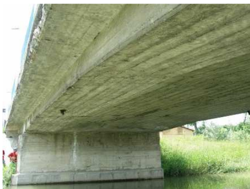
Rys. 3.153. Osady, wykwity, niewielka korozja i ubytki betonu na wspornikach pochodnikowych, lokalnie ubytki betonu i korozja strzemion
