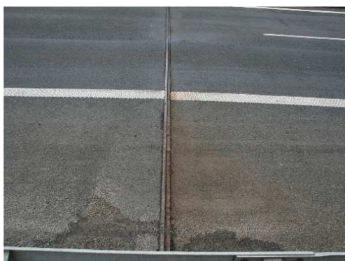
Rys. 3.248. Wadliwe położenie skrajnych profili stalowych jednomodułowego urządzenia dylatacyjnego nieadekwatne do temperatury (brak szczeliny), prawdopodobne zniszczenie neoprenowej wkładki uszczelniającej
