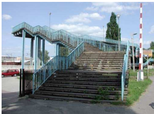
Rys. 3.374. Zniszczenie powłoki malarskiej na ok. 10% powierzchni balustrady i początki korozji materiału
