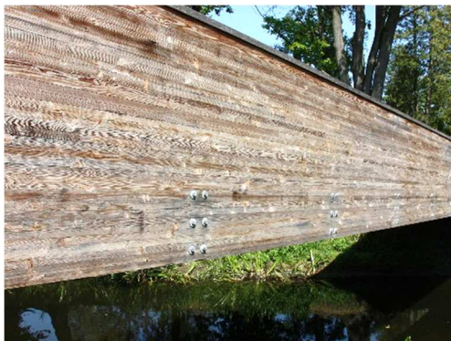
Rys. 3.200. Złuszczenie powłoki lakierniczej zabezpieczającej dźwigar przed czynnikami atmosferycznymi
