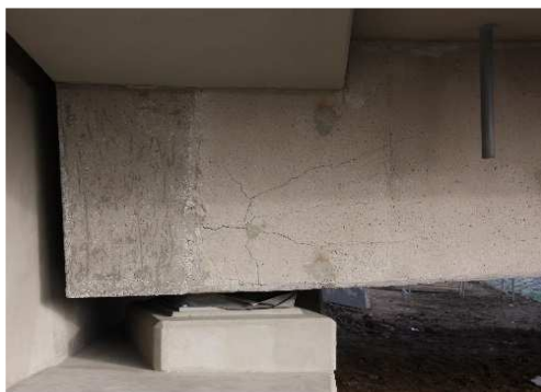
Rys. 3.161. Rysy o rozwarości do 1.4 mm o charakterze przeciążeniowym na bocznej powierzchni dźwigara kablobetonowego (beton o innej fakturze i kolorystyce na końcu dźwigara głównego to obetonowanie głowic kotwiących kable)
