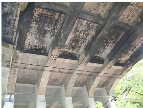
Rys. 3.121. Ubytki i korozja betonu oraz korozja odsłoniętego zbrojenia, wykwity (białe osady), zanieczyszczenie sadzą spodu płyty pomostu i dźwigarów
