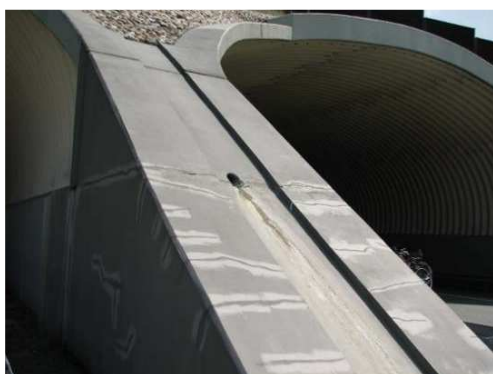
Rys. 3.105. Dren spełniający swoją funkcję (czynny) z niewielkimi zanieczyszczeniami
