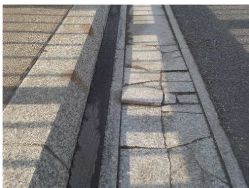
Rys. 3.92. uszkodzenie ścieków przykrawężnikowych z elementów kamiennych, pęknięcia, przemieszczenia i ubytki elementów
