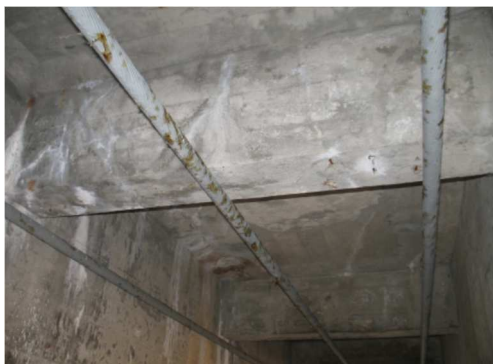
Rys. 3.354. Miejscowa korozja cięgien sprężających dźwigary żelbetowe, zniszczenie antykorozyjnej powłoki malarskiej (brak osłon)
