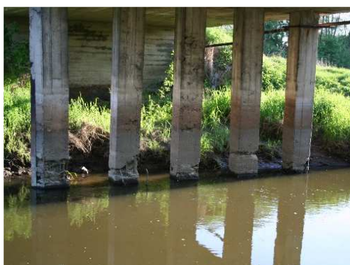
Rys. 3.277. Rozległe ubytki i korozja betonu w słupach filara oraz korozja odsłoniętego zbrojenia stwarzające zagrożenie dla bezpieczeństwa konstrukcji
