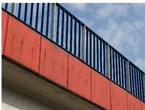
Rys. 3.77. Ogniska korozji zbrojenia w obrębie uchwytów mocujących żelbetowe deski gzymsowe do zbrojenia kapy chodnikowej, osady i zanieczyszczenie na zewnętrznej powierzchni prefabrykatów gzymsowych oraz uszkodzenia dekoracyjno-ochronnych powłok malarskich
