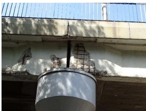
Rys. 3.174. Uszkodzenie skrajnych dźwigarów typu WBS w strefie podparcia na filarze, ubytek, korozja i zarysowanie betonu, korozja zbrojenia miękkiego
