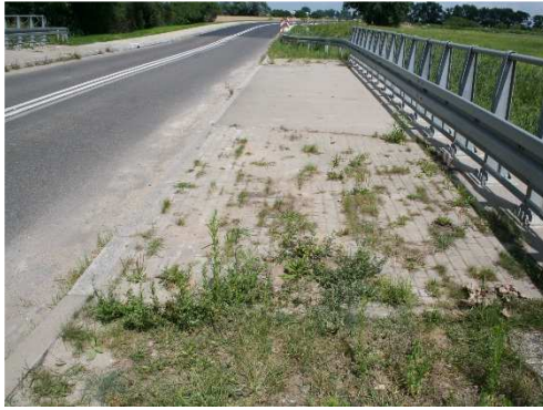
Rys. 3.36. Wegetacja roślin, zanieczyszczenie piaskiem i nierówności nawierzchni chodnika z kostki betonowej
