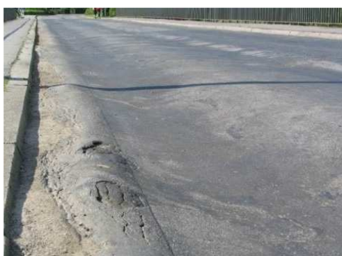
Rys. 3.26. Deformacje nawierzchni (koleiny) o głębokości przekraczającej 60 mm, rysy i pęknięcia asfaltu, zanieczyszczenia
