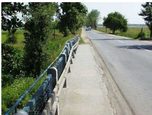
Rys. 3.59. Deformacja oraz przemieszczenie balustrady wraz z prowadnicą o ok. 15 cm, osłabione zamocowanie 2 słupków
