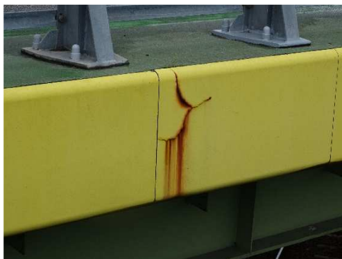
Rys. 3.81. Uszkodzenie zewnętrznej powierzchni deski gzymsowej z polimerobetonu, rysy i pęknięcia powłoki dekoracyjno-ochronnej, korozja zbrojenia w obrębie uchwytów mocujących deski gzymsowe do zbrojenia kapy chodnikowej
