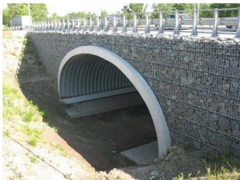
Rys. 3.150. Zasyпка i ściany boczne z koszy kamiennych niewykazujące uszkodzeń
