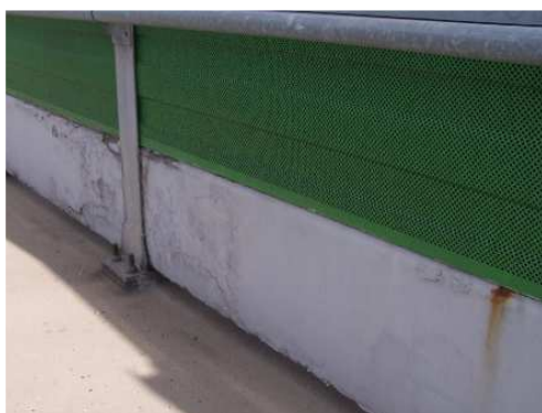
Rys. 3.328. Ekran przeciwhałasowy z wypełnieniem kasetowym oraz betonowym panelem dolnym, uszkodzenie powłok ochronnych, rysy skurczowe oraz ogniska korozji zbrojenia na panelach betonowych, zmatowienie powłok malarskich ze śladami korozji powierzchniowej na stalowym wypełnieniu kasetowym
