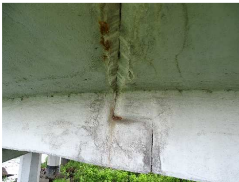
Rys. 3.313. Brak możliwości obrotu/przesuwu, intensywne przecieki wody, beton skorodowany w obrębie przegubu, rdzawe zacieki świadczące o korozji zbrojenia, osady wypełniające przegub
