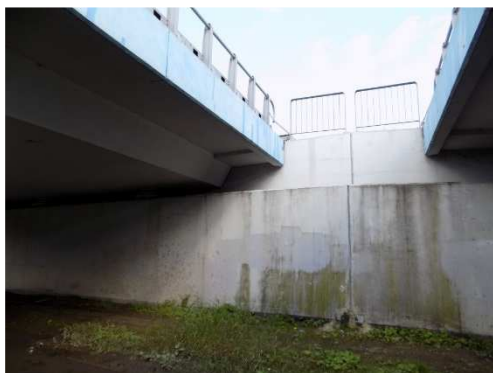
Rys. 3.259. Zacieki wodą spływającą z ławy podłożyskowej, lokalne przecieki przez korpus
