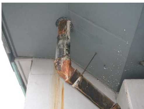
Rys. 3.106. Przecieki wokół rury odprowadzającej wodę na skutek nieprawidłowego osadzenia wpustu
