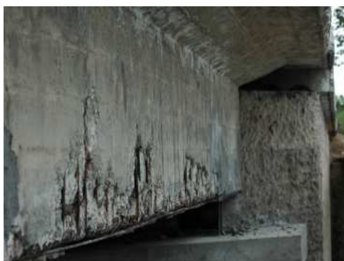
Rys. 3.168. Osady i białe wykwyty, ubytki betonu, odsłonięte pręty zbrojeniowe, korozja zbrojenia
