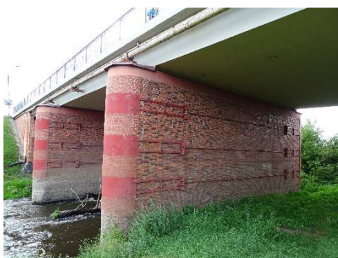
Rys. 3.364. Lokalne uszkodzenia powłoki anty-korozyjnej cięgien wzmacniających filary
