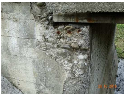
Rys. 3.255. Korozja i ubytki betonu, rysy, zawilgocenie i osady na powierzchni korpusu Kod uszkodzenia: KB, UB, RB, CB, OB Ocena: 2
