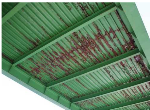
Rys. 3.136. Zniszczenie powłoki antykorozyjnej i rozległa korozja blach fałdowych stanowiących część pomostu, niewielka korozja powierzchniowa na poprzecznicach
