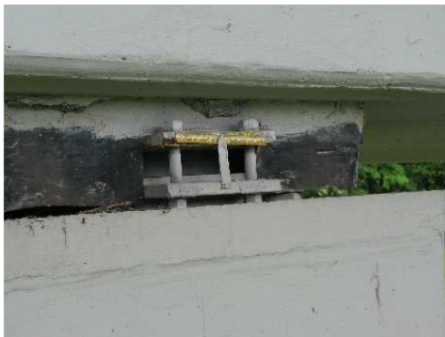
Rys. 3.222. Łożysko garnkowe z ograniczeniem ruchu przez niezdemontowane śruby w uchwytach montażowych/transportowych. Pęknięcia fartucha ochronnego, skorodowany i zanieczyszczony wskaźnik oraz skala przemieszczeń (położenia) łożyska.
