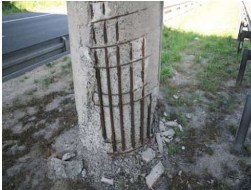
Rys. 3.272. Ubytki betonu filara oraz korozja zbrojenia stwarzające zagrożenie dla bezpieczeństwa konstrukcji
