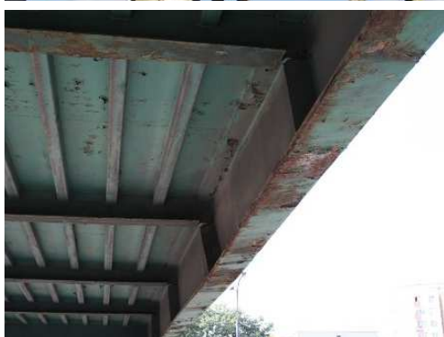
Rys. 3.196. Deformacja dźwigara blachowniowego kładki na skutek uderzenia przez pojazd, pęknięcie żeber pionowych podpierających ortotropowy pomost, zniszczenie antykorozyjnych powłok malarskich, rozległa korozja powierzchniowa
