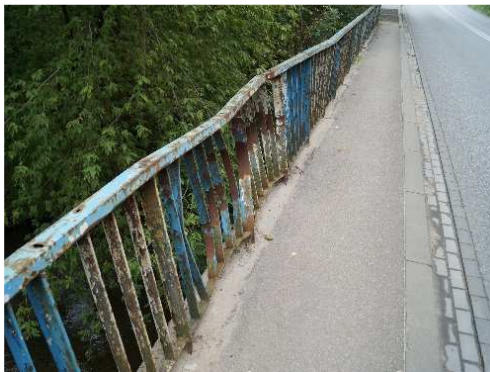
Rys. 3.58. Deformacja i przemieszczenie balustrady o ok. 15-20 cm w stosunku do położenia pierwotnego, osłabienie zamocowania balustrady do belki podporęczowej oraz całkowite zniszczenie antykorozyjnych powłok malarskich
