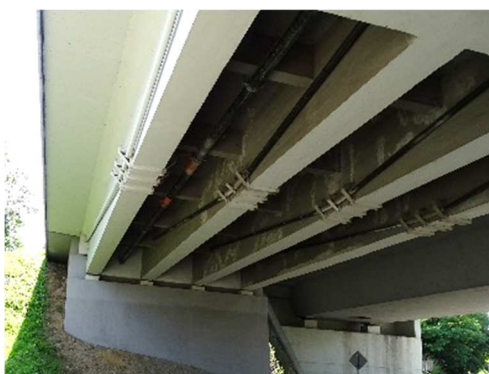
Rys. 3.363. Lokalne zanieczyszczenia osłon (rury HDPE) zewnętrznych kabli sprężających niemające wpływu na estetykę i trwałość
