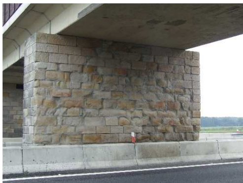
Rys. 3.284. Ubytki kamiennej licówki filara spowodowane wietrzeniem kamienia. Pęknięcia pojedynczych kamieni oblicowania, niewielkie ubytki spoinowania
