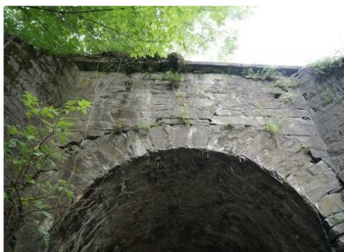
Rys. 3.145. Odspojenie ściany bocznej od sklepienia kamiennego, ubytki materiału ściany bocznej, wegetacja roślinności Kod uszkodzenia: UK, LK, RK, WK Ocena: 2
