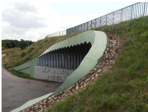
Rys. 3.82. Gzyms (wieniec betonowy) na krawędzi konstrukcji z blachy falistej bez uszkodzeń, w dobrym stanie technicznym
