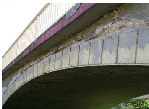
Rys. 3.146. Korozja i ubytki materiału ściany bocznej mostu sklepionego, wspornik podchodnikowy z niewielkimi zanieczyszczeniami Kod uszkodzenia: UB, KB Ocena: 3
