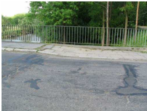
Rys. 3.20. Nawierzchnia na dojazdach obniżona o ok. 50 mm, powodująca zwiększone oddziaływania dynamiczne na konstrukcję i przyspieszoną degradację urządzenia dylatacyjnego. Występują również zastoiska wody i spękania asfaltu
