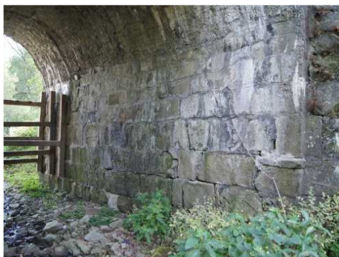
Rys. 3.263. Uszkodzenie kamiennego korpusu przyczółka, rysy i pęknięcia kamieni, przecieki, osady, ubytki spoinowania, wegetacja mchów, korozja i ubytki kamienia
