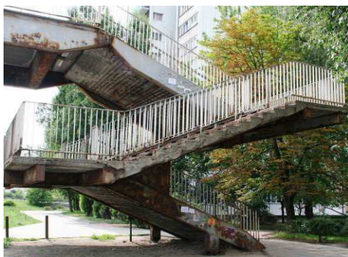
Rys. 3.375. Korozja i ubytki betonu płyty pomostu, silnie zaawansowana korozja stali konstrukcyjnej i zbrojeniowej
