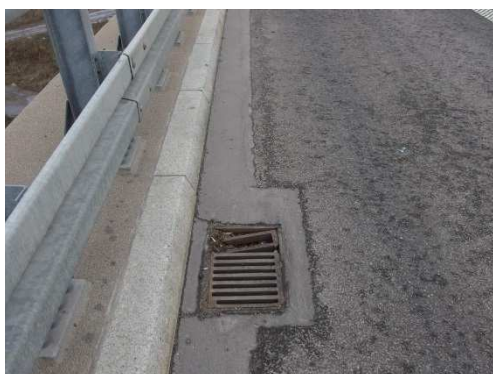
Rys. 3.96. Uszkodzona kratka ściekowa wpustu, rysy w asfalcie lanym przeciwnospadku
