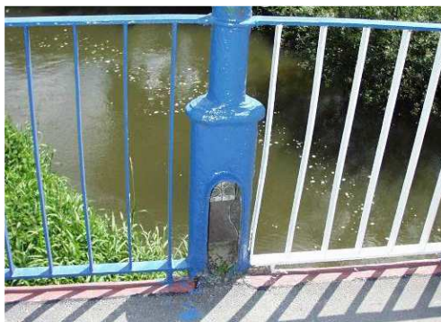
Rys. 3.368. Zniszczenie osłony instalacji elektrycznej w latarni oświetlającej obiekt
