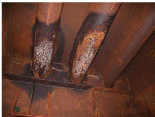
Rys. 3.138. Pomost ortotropowy wykonany ze stali trudnordzewiejącej, na elementach pomostu wyraźne lokalne, brunatne przebarwienia oraz białe osady i wykwyty zawierające jony chlorku, mikrorysy na spodzie żeber podłużnych oraz w spoinach łączących żebra podłużne z blachą pomostu
