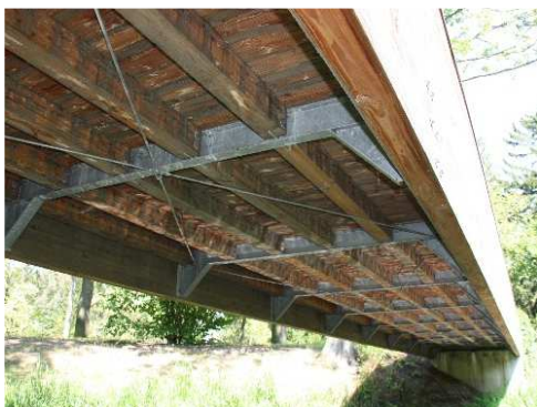
Rys. 3.140. Zawilgocenia, zacieki oraz miejscowa korozja drewna
