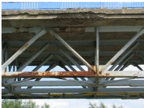
Rys. 3.188. Korozja pasa dolnego dźwigara kratowniczowego (korozja powierzchniowa), osłabienie przekroju szacowane na poniżej 5%
