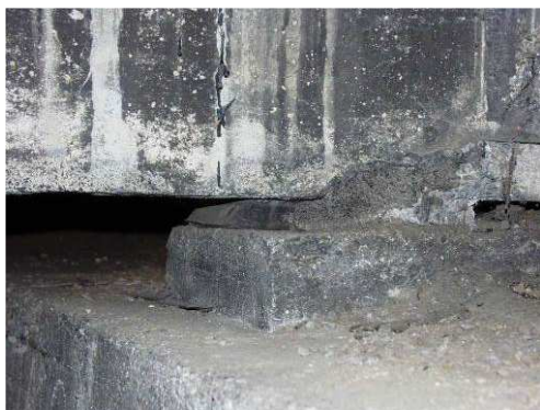
Rys. 3.216. Łożysko elastomerowe uszkodzone na skutek działania wysokiej temperatury – pożaru pod mostem, odkształcenia postaciowe dyskwalifikujące jego przydatność użytkową
