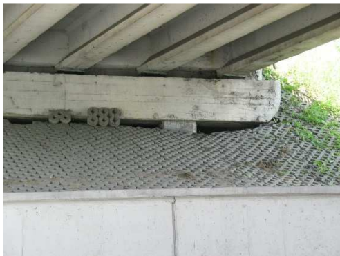
Rys. 3.11. Osiadanie skarpy nasypu drogowego w obrębie przyczółka zatopionego w nasypie zagrażające stateczności skarpy oraz sprzyjające powstawaniu wybojów na dojazdach obiektu. Ubytki i przemieszczenia elementów umocnień skarpy
