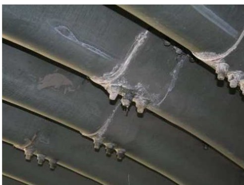
Rys. 3.117. Osady i zacieki obejmujące 5% złąć śrubowych, spowodowane uszkodzeniem izolacji
