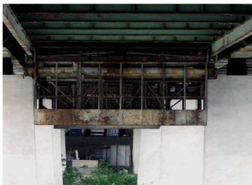
Rys. 3.382. Zniszczenie powłoki antykorozyjnej i korozja wózka rewizyjnego
