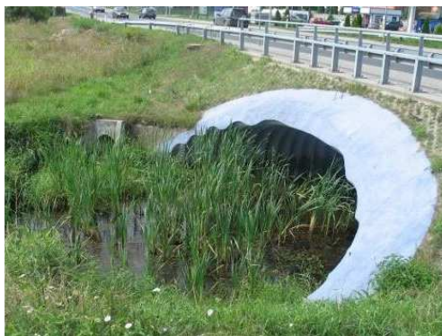
Rys. 3.305. Nadmierna wegetacja roślin utrudniająca przepływ wody Kod uszkodzenia: WT Ocena: 3
