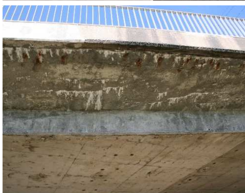
Rys. 3.162. Ubytki, korozja i zarysowania betonu, korozja odsłoniętego zbrojenia, osady i wykwity zakończone stalaktytami na całej powierzchni wsporników podchodnikowych
