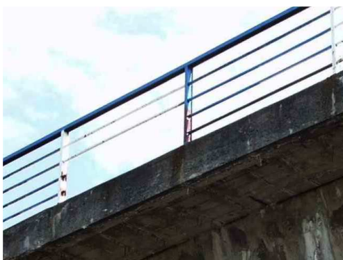
Rys. 3.62. Brak przeciągów balustrady
