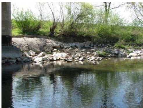
Rys. 3.300. Podmycie umocnień koryta rzeki. Brak odpowiednich umocnień może spowodować podmycie przyczółka
