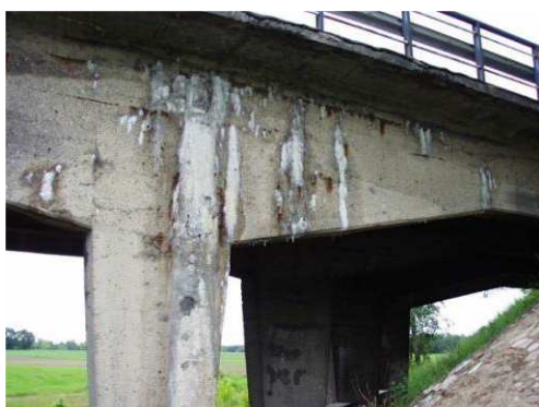
Rys. 3.164. Przecieki wody, osady i wykwity świadczące o zaawansowanej korozji betonu, korozji zbrojenia – strzemion
