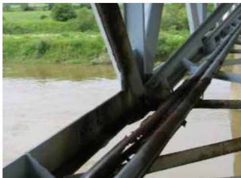
Rys. 3.369. Ubytki korozyjne osłon przewodów telekomunikacyjnych
