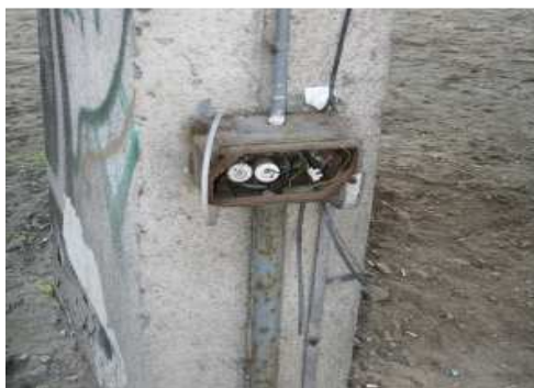
Rys. 3.389. Korozja i uszkodzenie pokrywy skrzynki bezpiecznikowej/rozdzielczej
