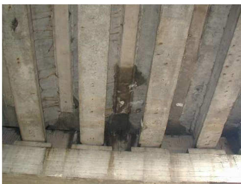
Rys. 3.109. Lokalne przecieki przez zamek belek typu Płońsk oraz w sąsiedztwie dylatacji – powierzchnia przecieków nieprzekraczająca 5% powierzchni płyty pomostu
