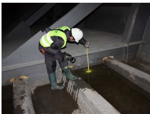
Rys. 3.98. Zastoiska wody we wnętrzu przęsła o konstrukcji skrzynkowej. Uszkodzony system odwodnienia pomostu, niedrożne otwory do odprowadzenia wody z wnętrza skrzynki
