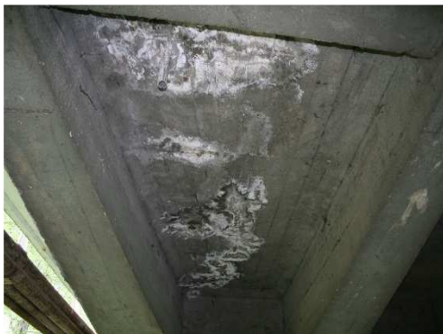
Rys. 3.115. Rozległe przecieki świadczące o braku szczelności izolacji
