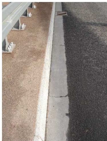
Rys. 3.34. Regularne rysy poprzeczne na całej długości ścieku przykrawężnikowego w formie przeciwspadku, którego górną powierzchnię wykonano z żywicy
