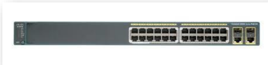
Fot. 34 Przełącznik WS-C2960L-24PS-LL zakupiony przez KW PSP łączący sieci LAN komend z urządzeniem brzegowym sieci OST112.
