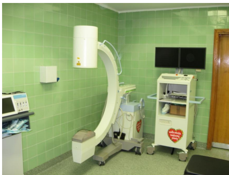
Zdjęcie 2. Aparat rtg do radiologii zabiegowej.
