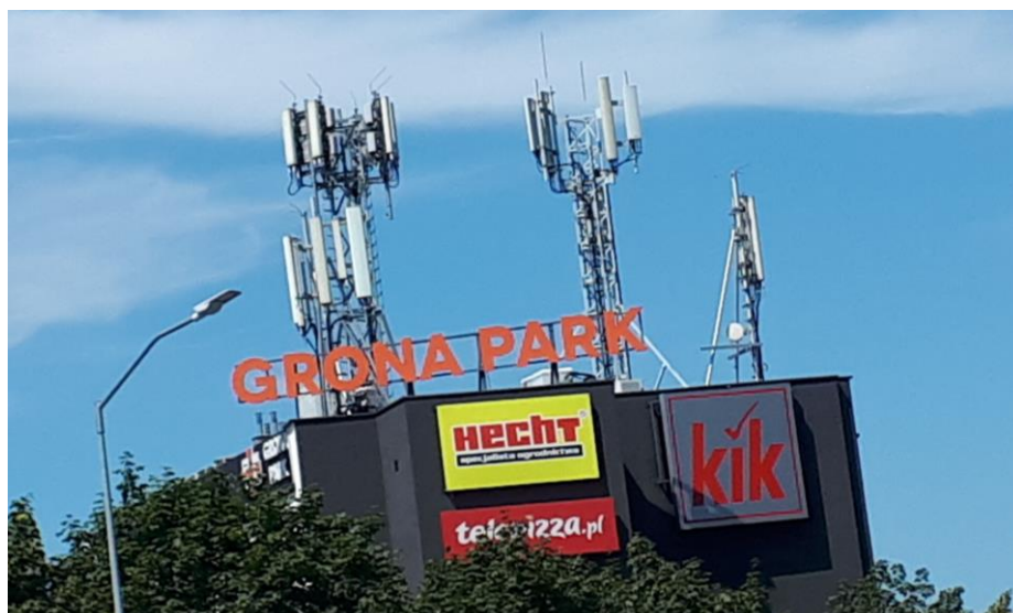
Fot. 1: Widok anten stacji bazowych: ID: ZGO1026, ID: BT31768, ID: 61550, zlokalizowanych pod adresem: ul. Wiejska 2, 65-609 Zielona Góra
