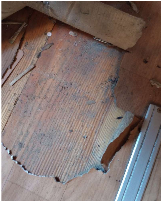
Fot. 2 Pomieszczenie kancelarii – uszkodzenia istniejącej okładziny podłogowej PCV (podłoga drewniana)
