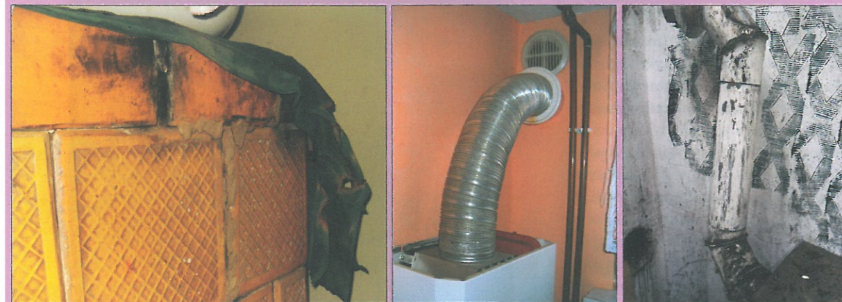
od lewej: Nieszczelny piec kaflowy ze śladami okopceń Żyłę podłączony do kominu gazowy piecyk łazienkowy Piecyk grzewczy na paliwo stałe wadliwie podłączony do kominu na str. 22: Do całkowitego spalania 1 m 3 gazu ziemnego CH 4 potrzeba około 13 m 3 powietrza
