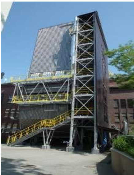
Fot.5 Instalacja odazotowania spalin w Elektrociepłowni Pomorzany. Materiały własne.
