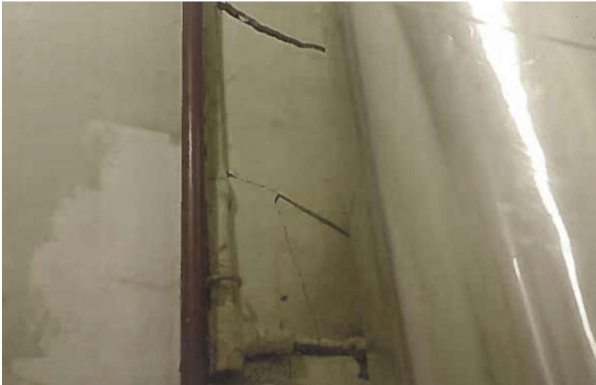
Zdjęcie nr 21 i 22, pęknięcia ścian
