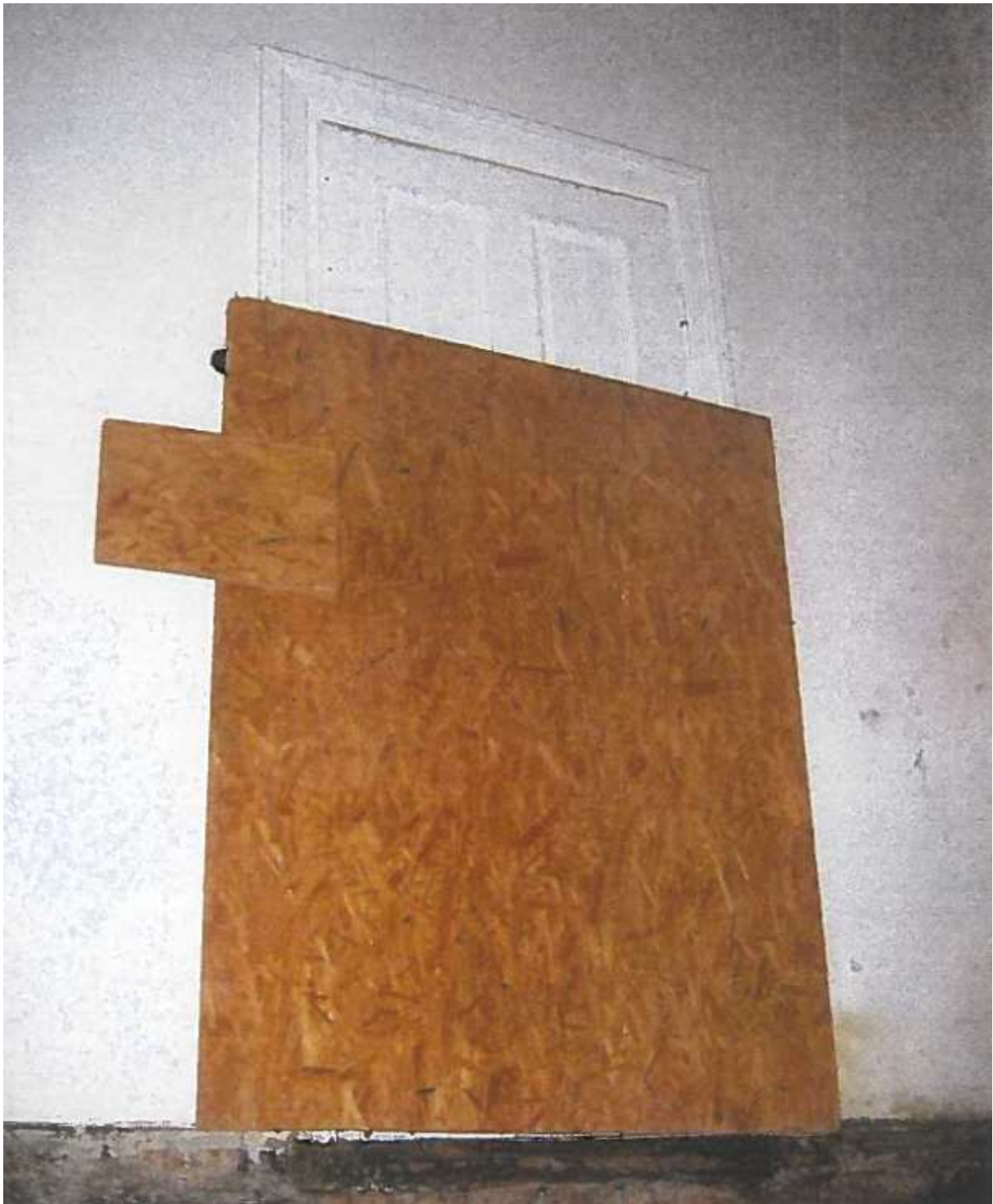
Zdjęcie nr 9, drzwi zabite płytą pilśniową w celu ocieplenia ściany
