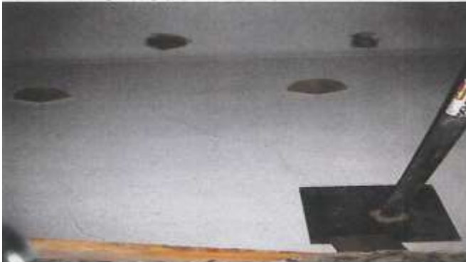
rozpoczynająca się spęknięcie ścian. Fotografia wykonana z poziomu piwnicy przez dziurę w stropie.
