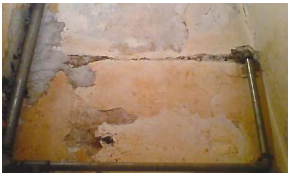
Zdjęcie nr 30 i 31, grzyb przy otworach okiennych; grzyb na ścianach
