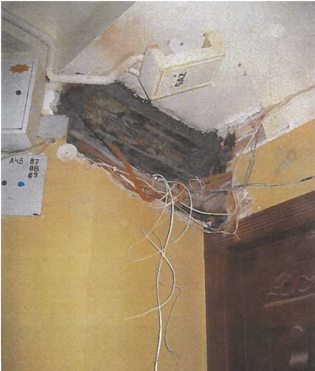
Zdjęcie nr 12, naruszenie instalacji elektrycznej powodujące odłączenie energii
