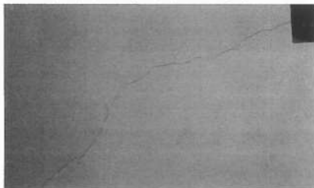
Pęknięcie skośne ściany działowej między kuchnią a pokojem 1 powstałe w dniu kiedy rozpoczęto wyburzanie ścian i stropów łukowych w piwnicach. W styczniu 2012 w szczelinie mieściła się dłoń.
