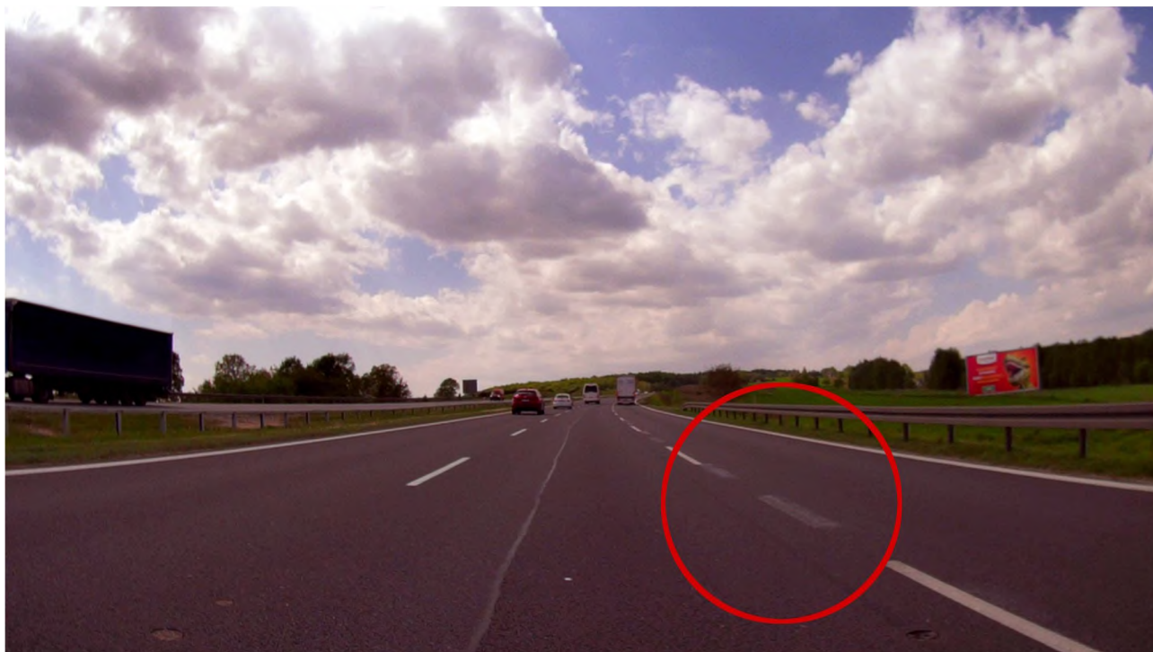
Zdjęcie 2: Widoczne poprzednie oznakowanie poziome pasa ruchu powolnego na autostradzie A4 (Balice I – Rudno, kier. Katowice)
