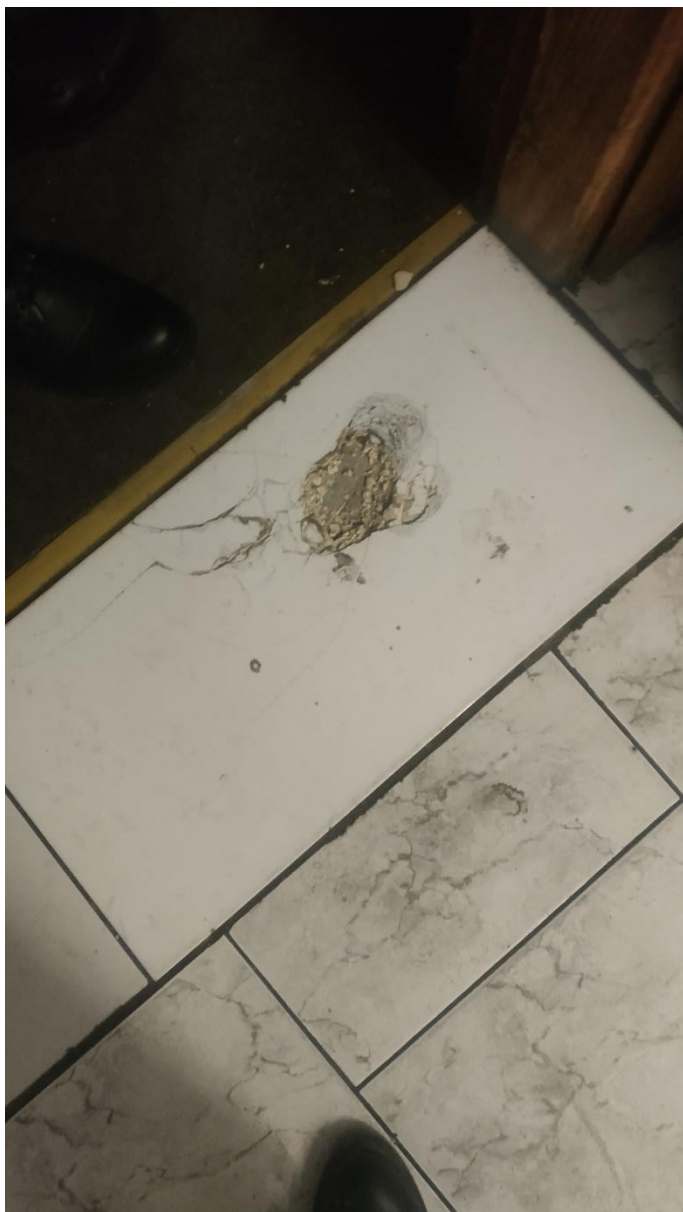
Ubytki płytek ceramicznych w posadzce.
