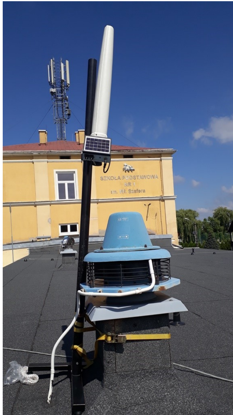
Rys. 3 Miejsce montażu SMS PEM – Szkoła Podstawowa nr 1 w Mielcu – widok na SBTK
