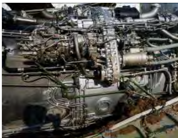
Zdj. 12. Widok agregatów silnikowych oraz elementów sterowania silnikiem po zdjęciu osłon
