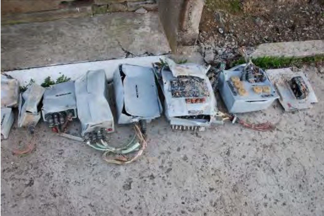
Rys. 30. Skrzynki sterowania instalacji elektrycznej
