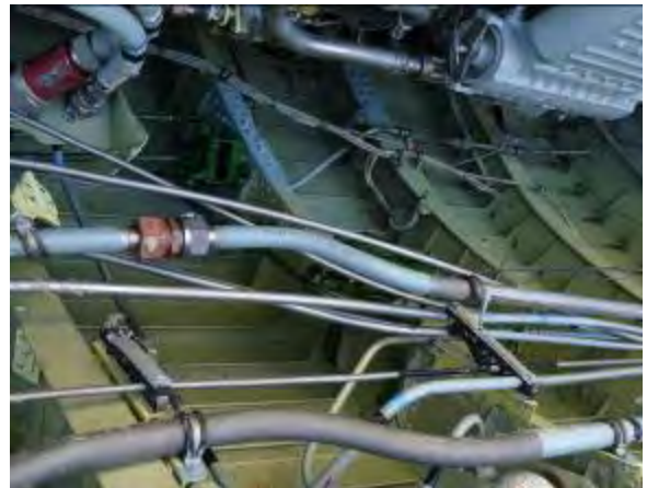
Zdj. 38. Widok elementów sterowania silnikiem
