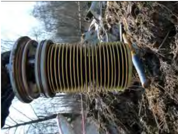
Zdj. 53. Widok filtra oleju MFS-30
