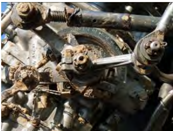
Zdj. 19. Widok agregatów silnikowych oraz elementów sterowania silnikiem – noniusz na pompie NR-30KU-4
