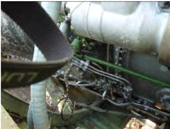
Zdj. 37. Widok elementów sterowania silnikiem
