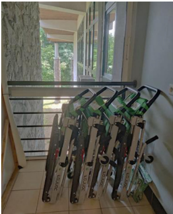
Krzesła ewakuacyjne stojące przy klatce schodowej.
