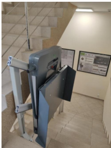
Platforma schodowa ukośna wewnątrz budynku.
