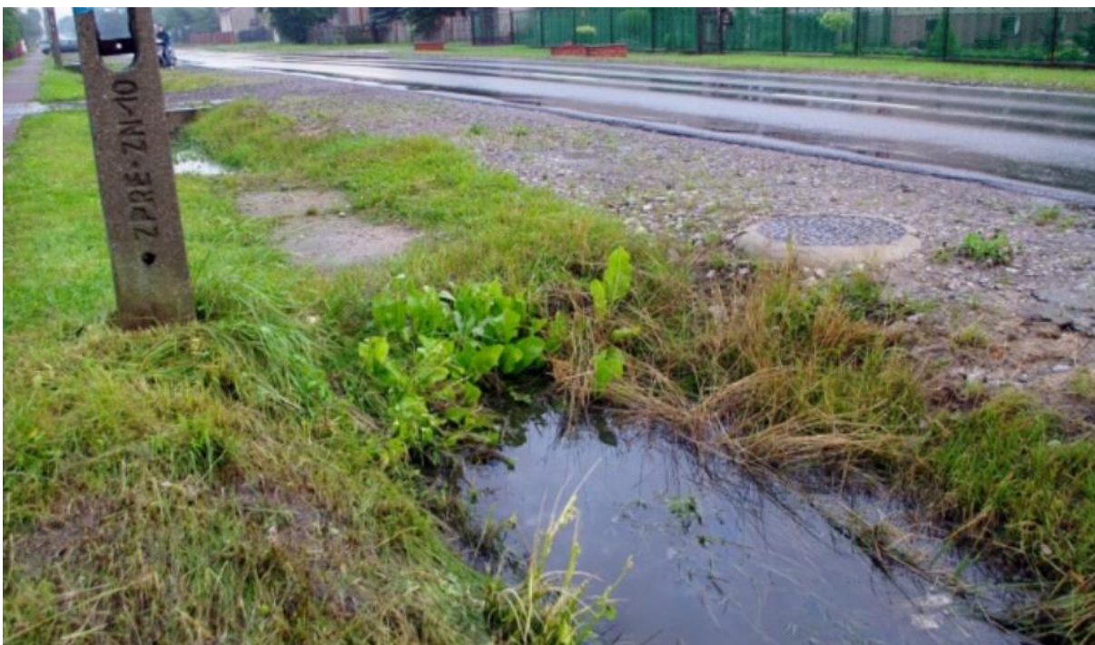
Rys. 7.2.2. Brak odpływu wody, elementy odwodnień zasypane – stan zły
