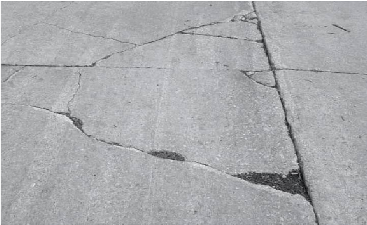
Rys. 5.2.2.10. Widok pęknięć blokowych w obszarze naroża
