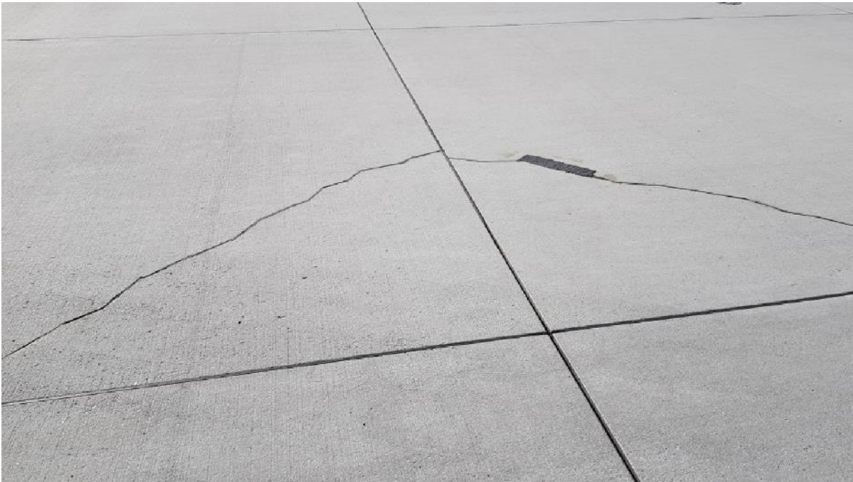
Rys. 5.2.2.6. Widok pęknięcia naroża
