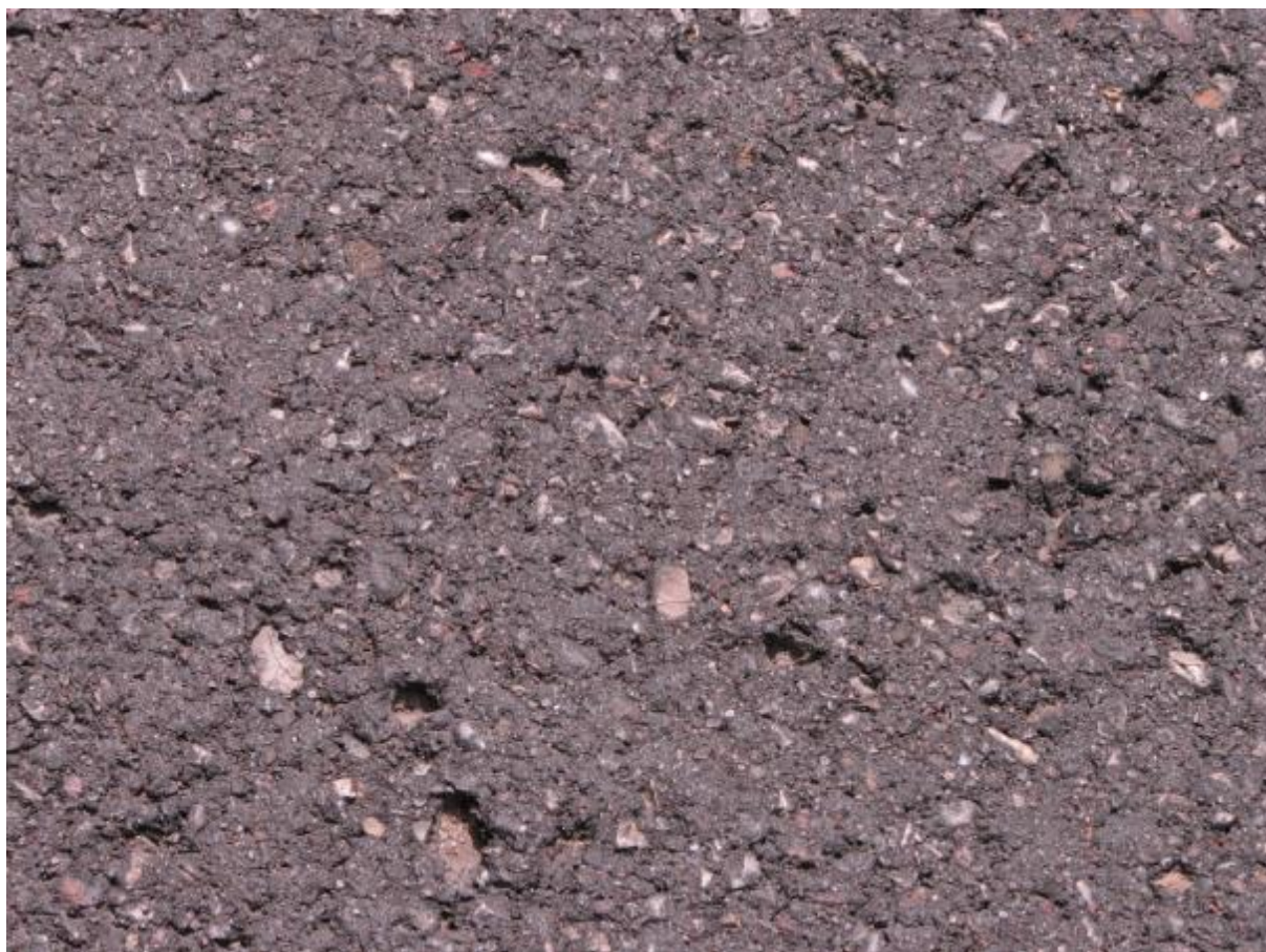
Rys. 5.1.3.1. Ubytki ziaren kruszywa i lepiszcza oraz mieszanki mineralno-asfaltowej
