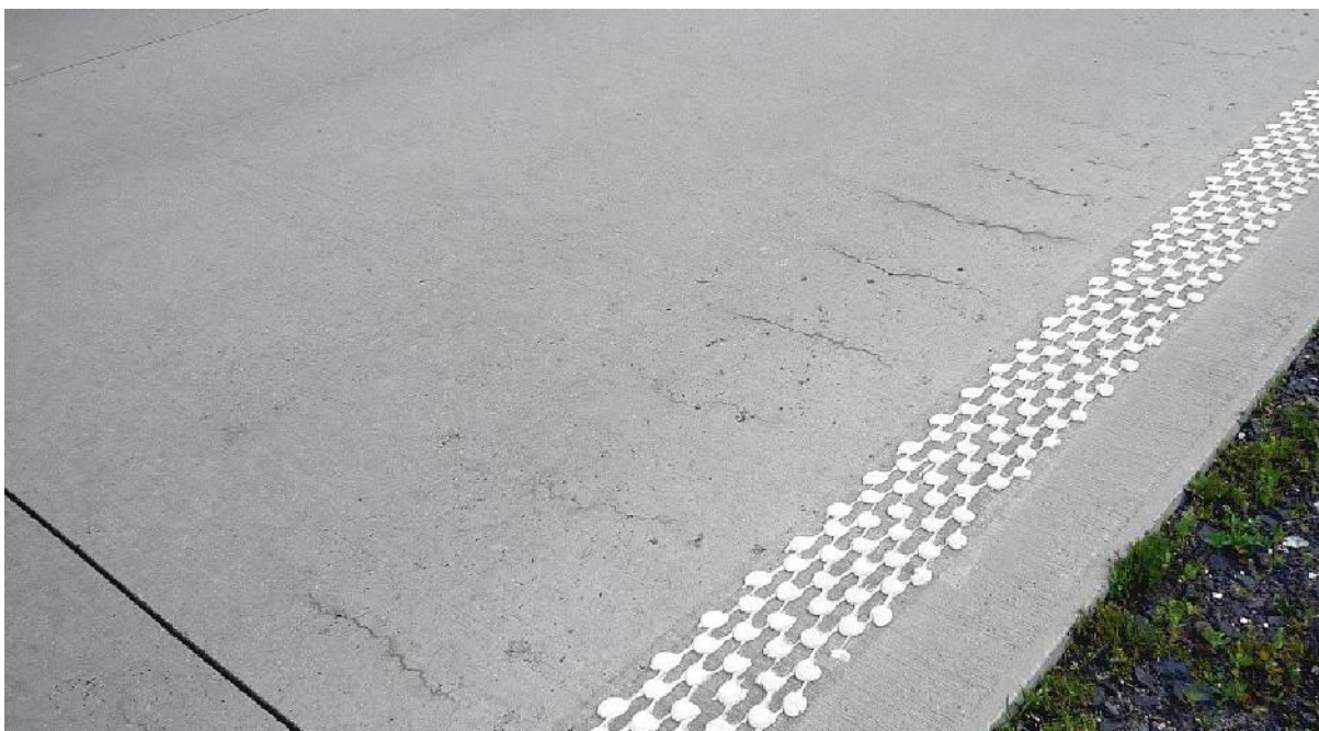
Rys. 5.2.3.7. Widok pęknięć spowodowane niewłaściwą pielęgnacją
