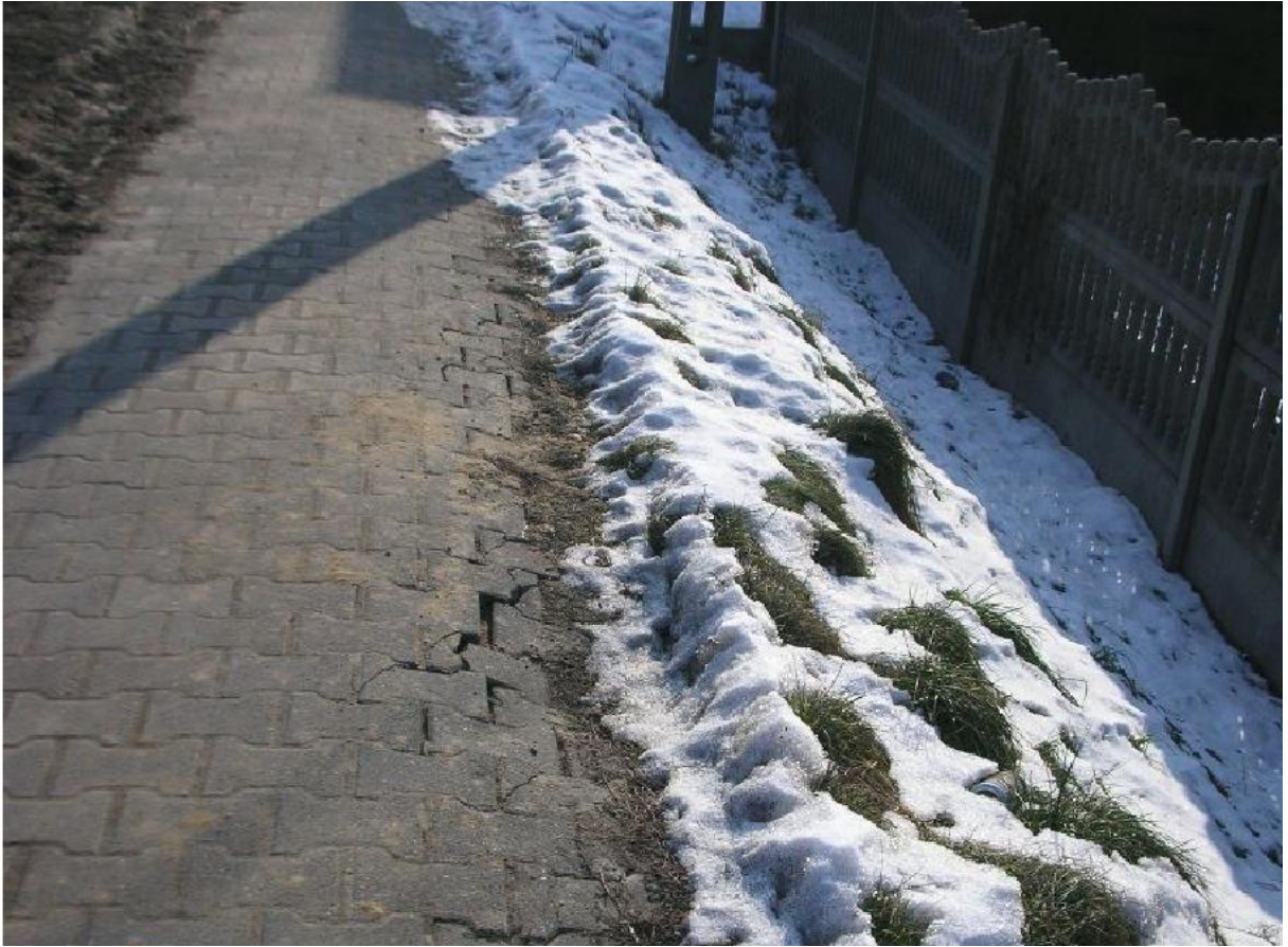
Rys. 6.11. Uszkodzenia chodnika z kostki betonowej spowodowane ruchem pojazdów utrzymania zimowego
