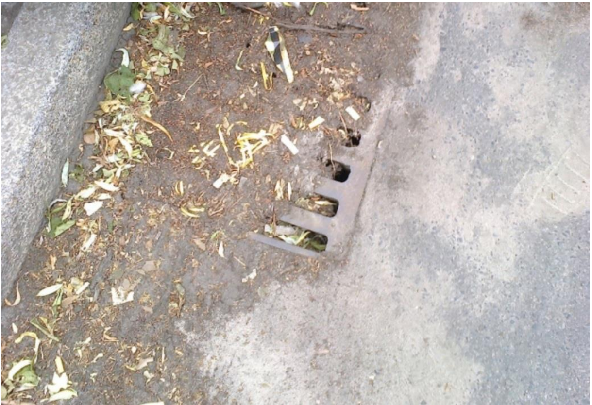
Rys. 7.2.5. Wpusty studzienek kanalizacyjnych i studzienki zasypane – stan zły
