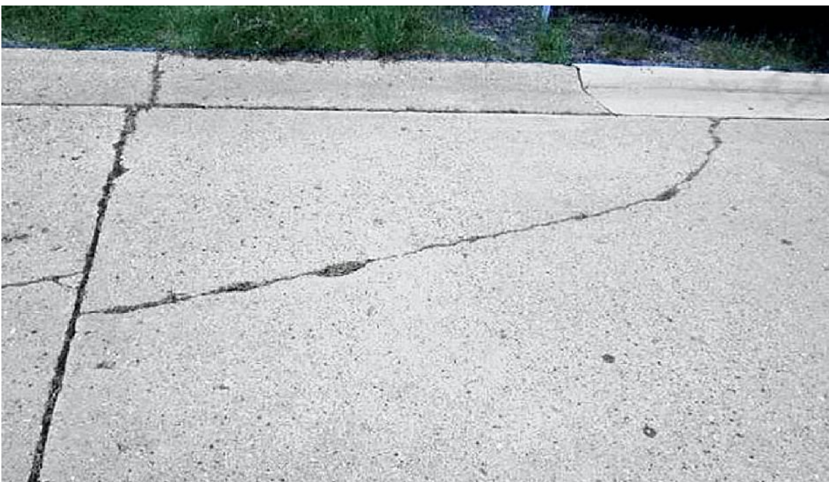
Rys. 5.2.2.7. Widok pęknięcia naroża z częściowym wykruszeniem
