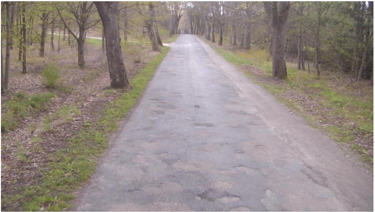
Rys. 5.1.3.7. Stan zły: liczne wyboje – powyżej 50% powierzchni [3]
