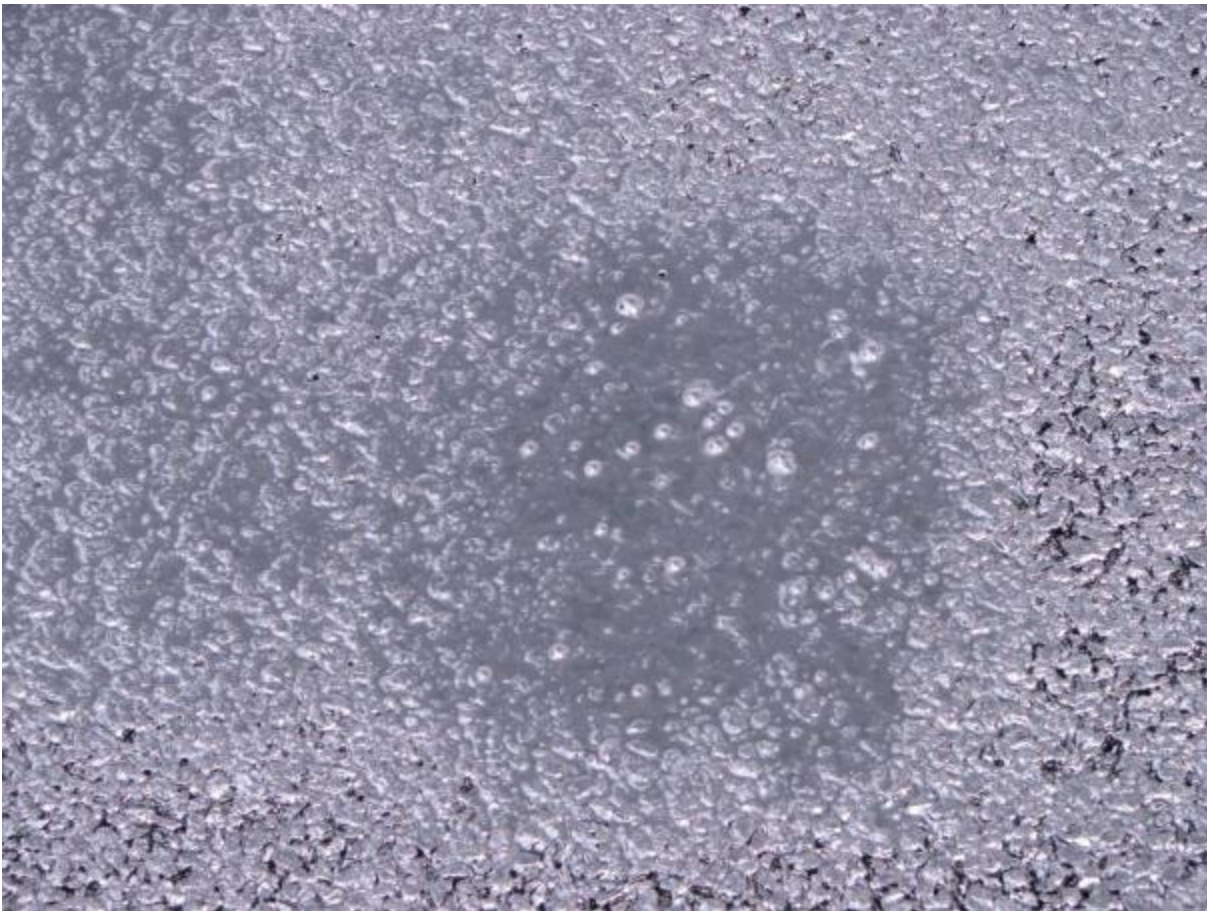
Rys. 5.1.3.9. Wypływ (plamy) lepiszcza
