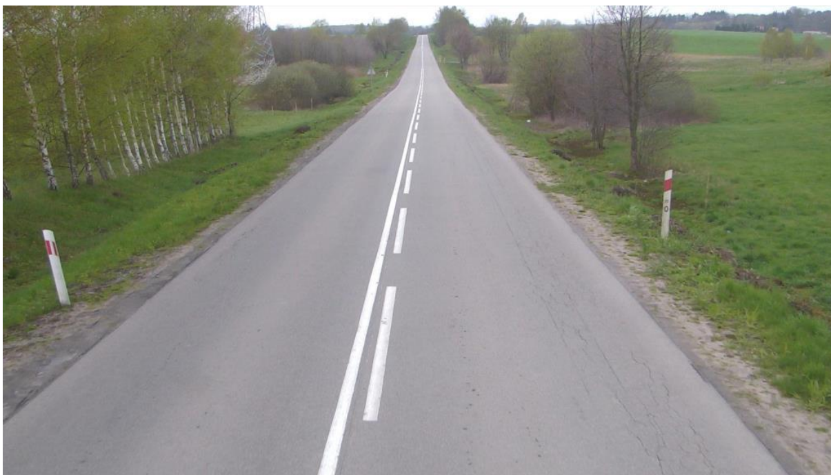
Rys. 5.1.2.2. Stan niezadowolający: skupiska spękań siatkowych zajmujące do 15% powierzchni [3]
