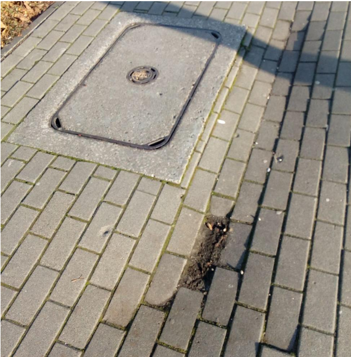
Rys. 6.5. Zapadnięcia lokalne bez ubytków
