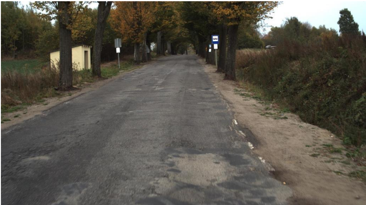
Rys. 5.1.1.5. Stan zły: liczne uszkodzenia zajmujące powyżej 50% powierzchni - nawierzchnia mocno skoleinowana [3]
