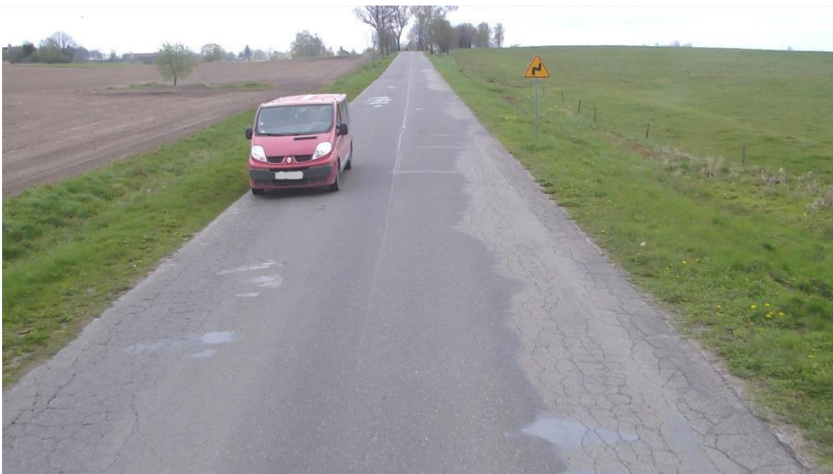
Rys. 5.1.2.3. Stan zły: spękania siatkowe i skupiska spękań zajmujące ponad 50% powierzchni [3]
