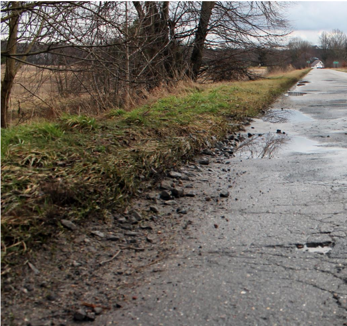
Rys. 7.1.4. Pobocze zawyżone, powstałe wskutek zjawiska tzw. „rośnięcia pobocza”
