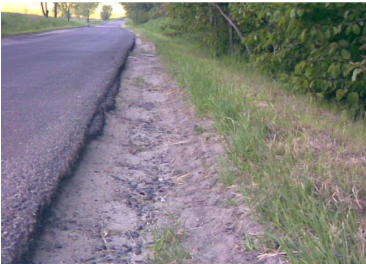
Rys. 7.1.1. Pobocze „skoleinowane” pierwszego rodzaju (zaniżone), powstałe wskutek ruchu pojazdów
