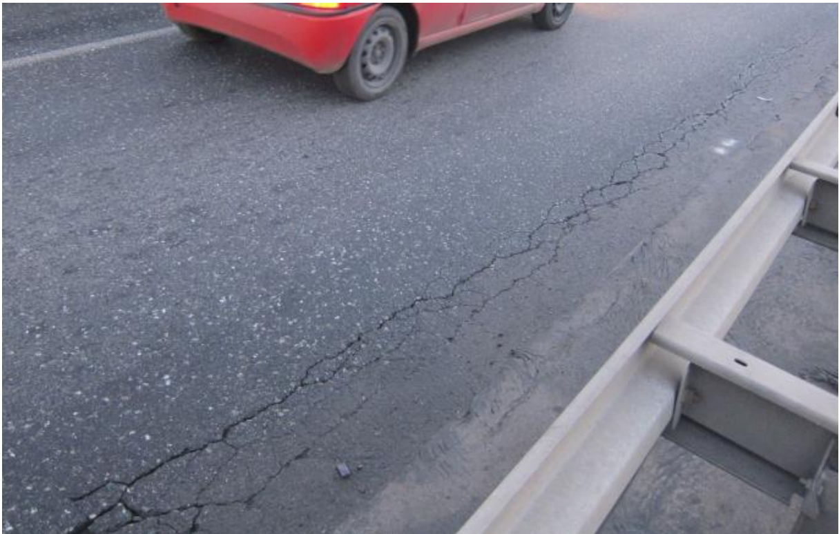
Rys. 5.1.2.7. Spękania zmęczeniowe podłużne (w śladzie koleiny)
