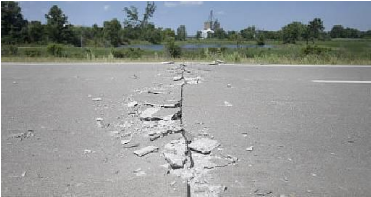
Rys. 5.2.4.2. Widok uszkodzenia szczeliny płyty
