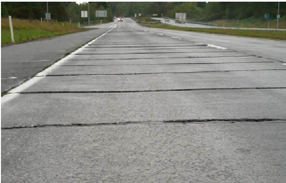
Rys. 5.2.1.6. Widok uskoków płyt
