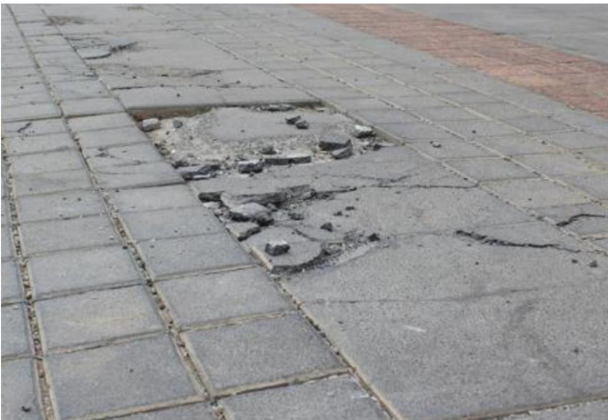
Rys. 6.10. Głębokie złuszczenia płyt chodnikowych z betonu cementowego
