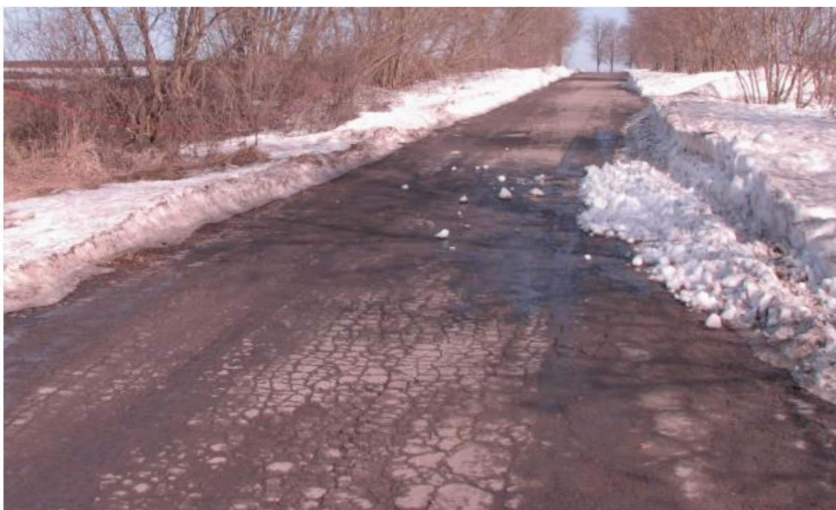
Rys. 5.1.2.13. Stan zły: spękania termiczne zmęczeniowe (blokowe) zajmujące powyżej 50% powierzchni
