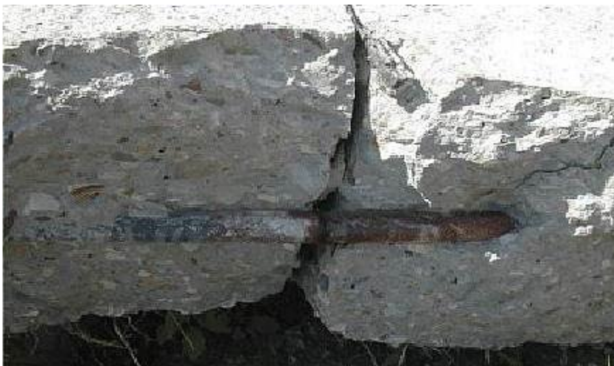
Rys. 5.2.5.2. Widok uszkodzeń z powodu nieprawidłowej pracy i korozji dybli
