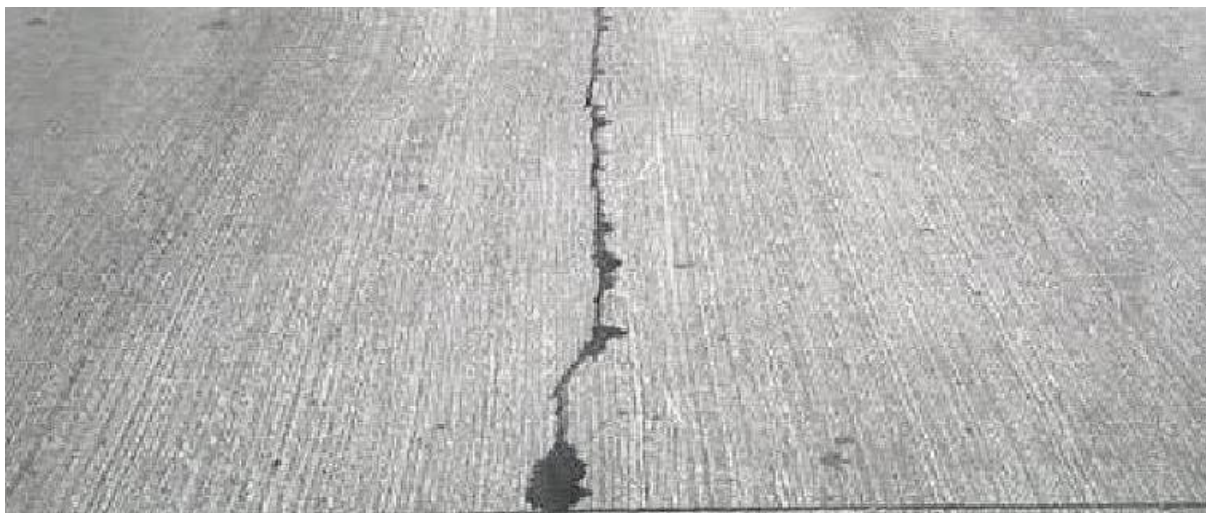
Rys. 5.2.2.1. Widok pęknięcia podłużnego na długości płyty
