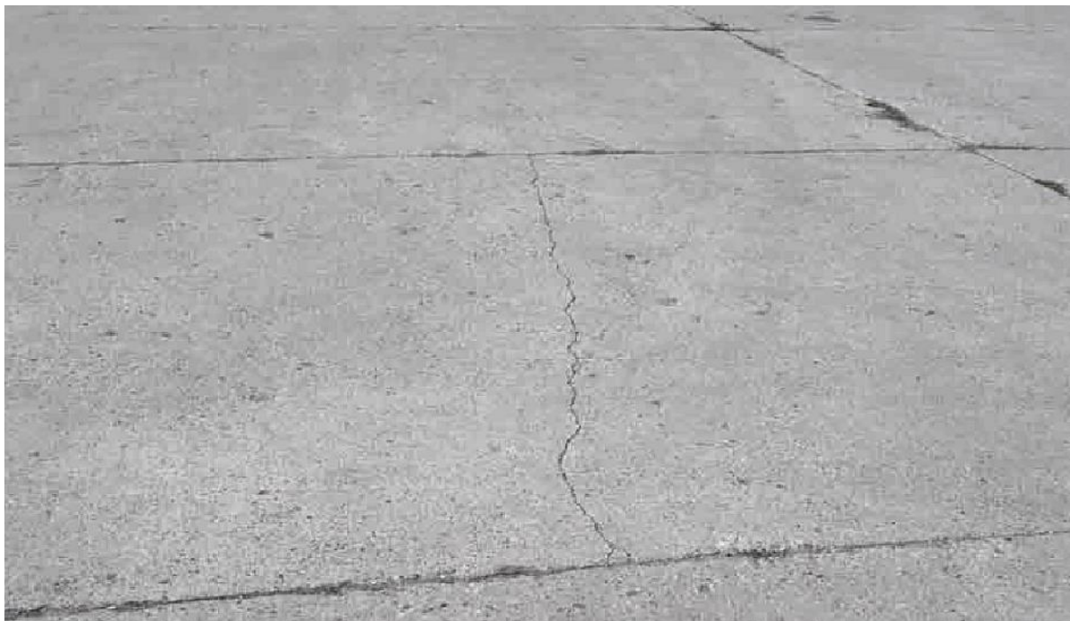
Rys. 5.2.2.4. Widok pęknięć poprzecznych
