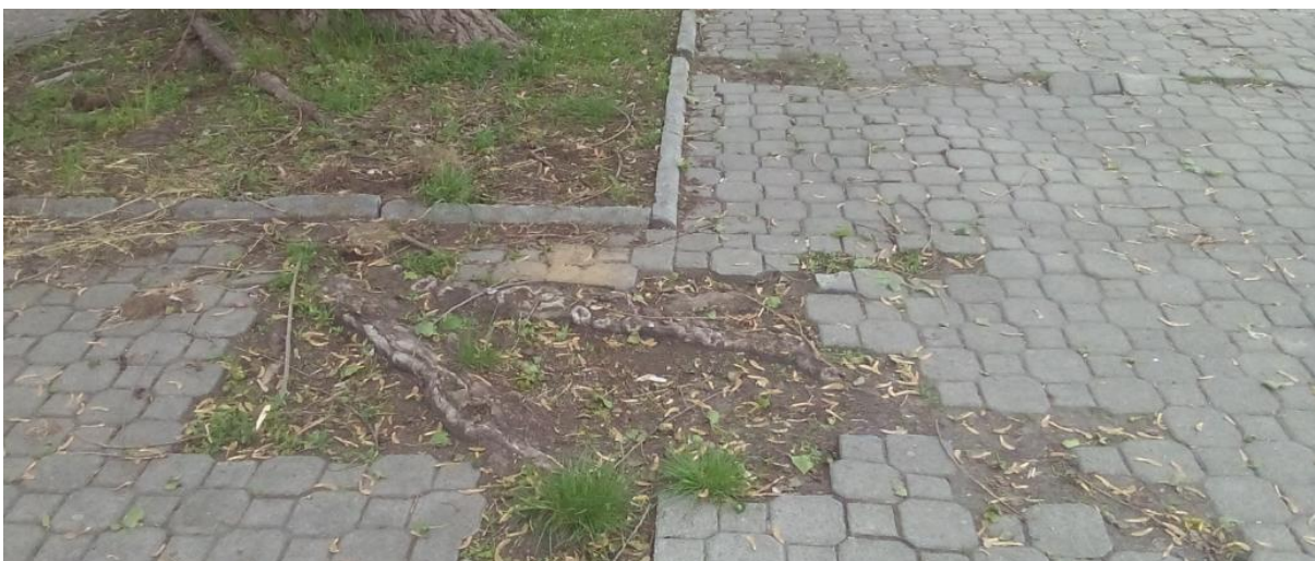
Rys. 6.2. Sfalowania i ubytki kostki betonowej spowodowane korzeniami drzew
