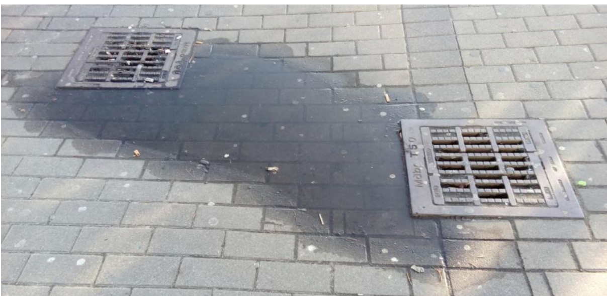
Rys. 6.6. Zapadnięcia lokalne bez ubytków
