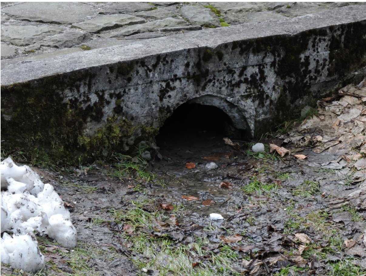
Rys. 7.2.4. Przepust niedrożny powyżej 50% – stan zły
