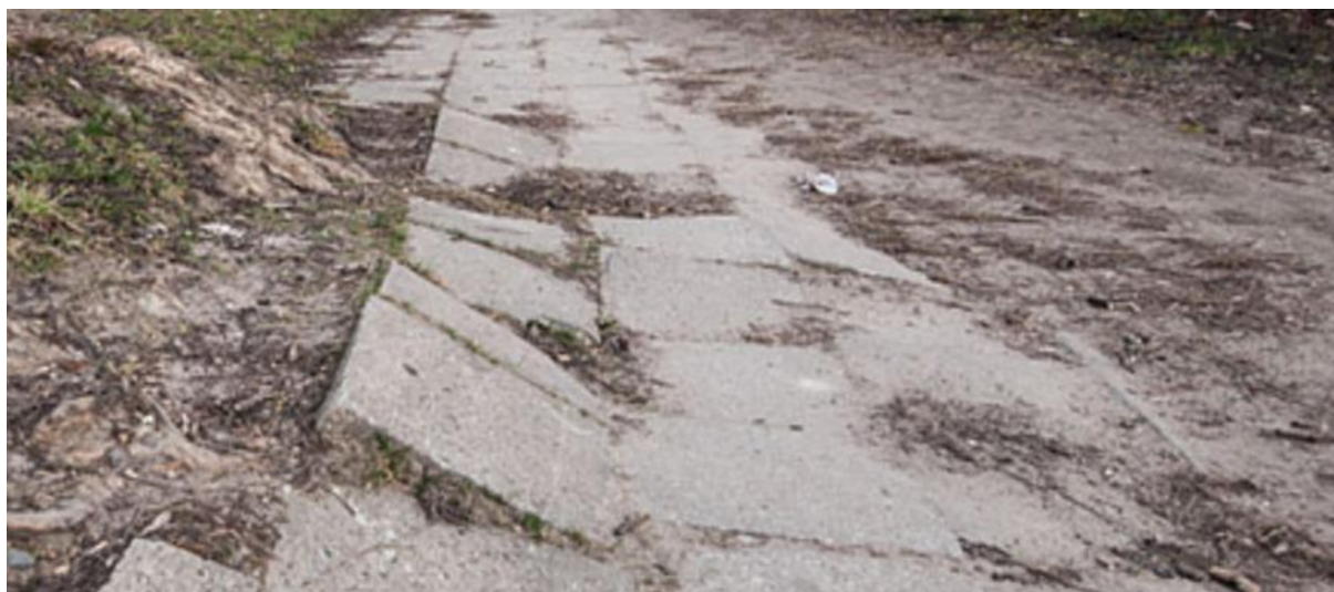
Rys. 6.1. Sfalowania płyt chodnikowych
