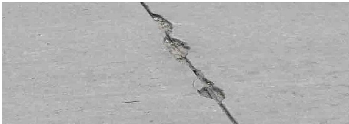
Rys. 5.2.4.1. Widok uszkodzenia szczeliny płyty
