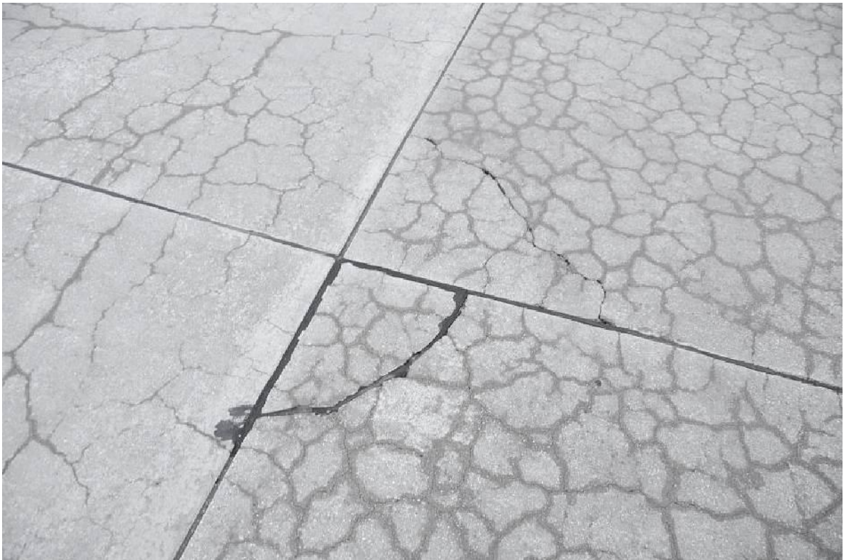
Rys. 5.2.3.5. Widok pęknięć alkalicznych
