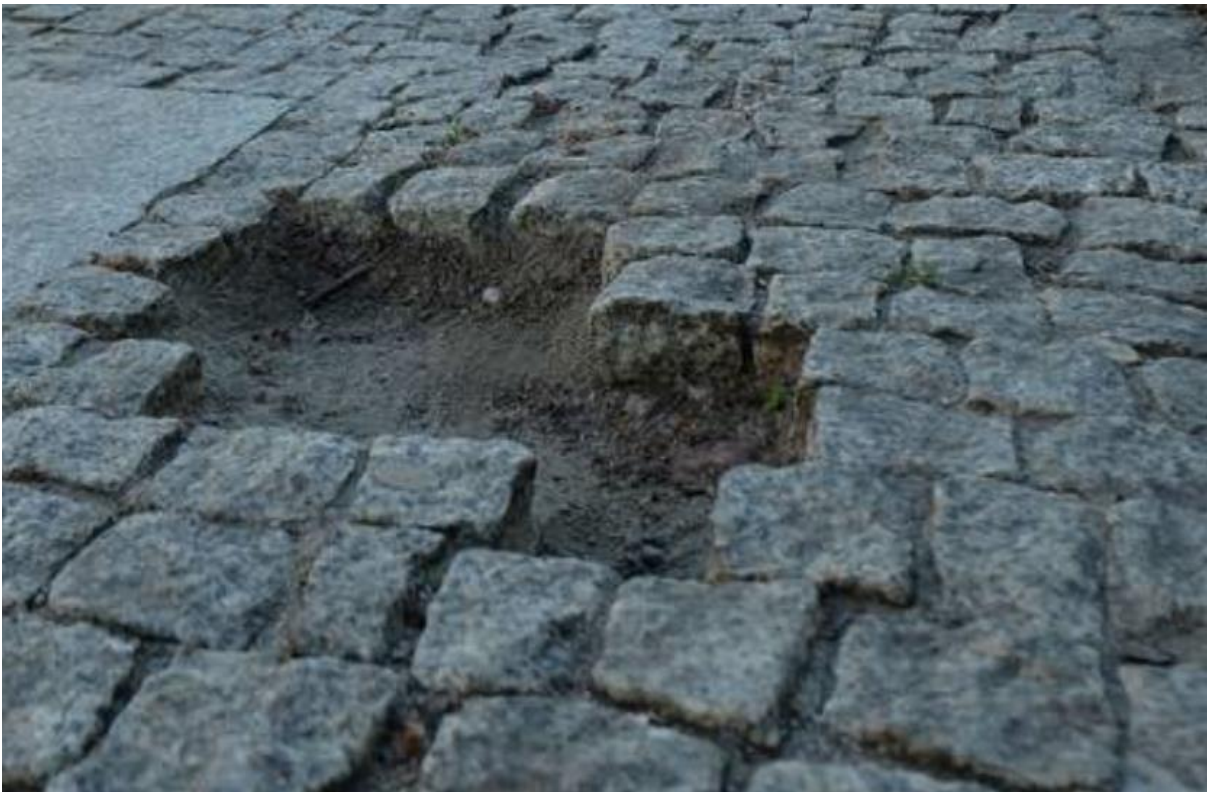
Rys. 6.9. Braki elementów chodnika z kostki kamiennej
