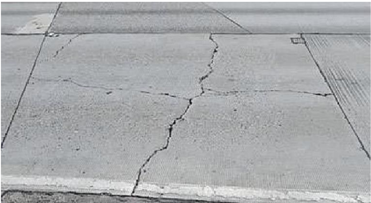
Rys. 5.2.2.9. Widok pęknięć blokowych
