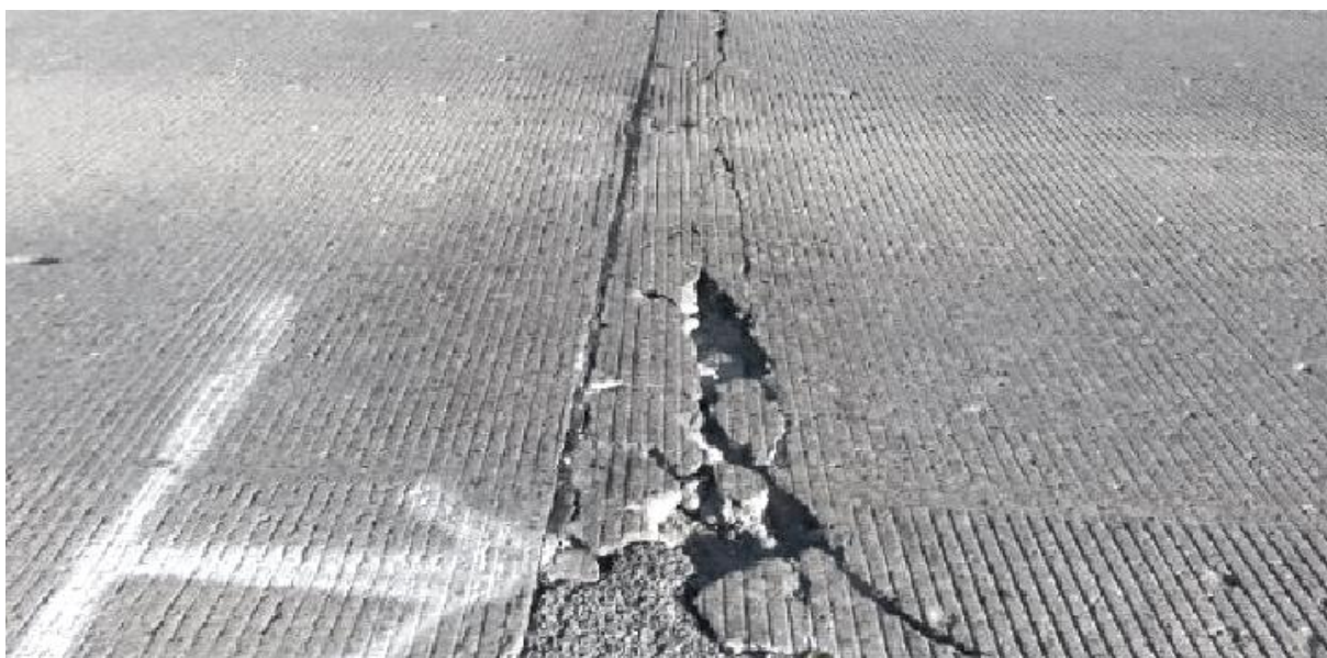
Rys. 5.2.5.1. Widok uszkodzeń z powodu nieprawidłowej pracy dybli
