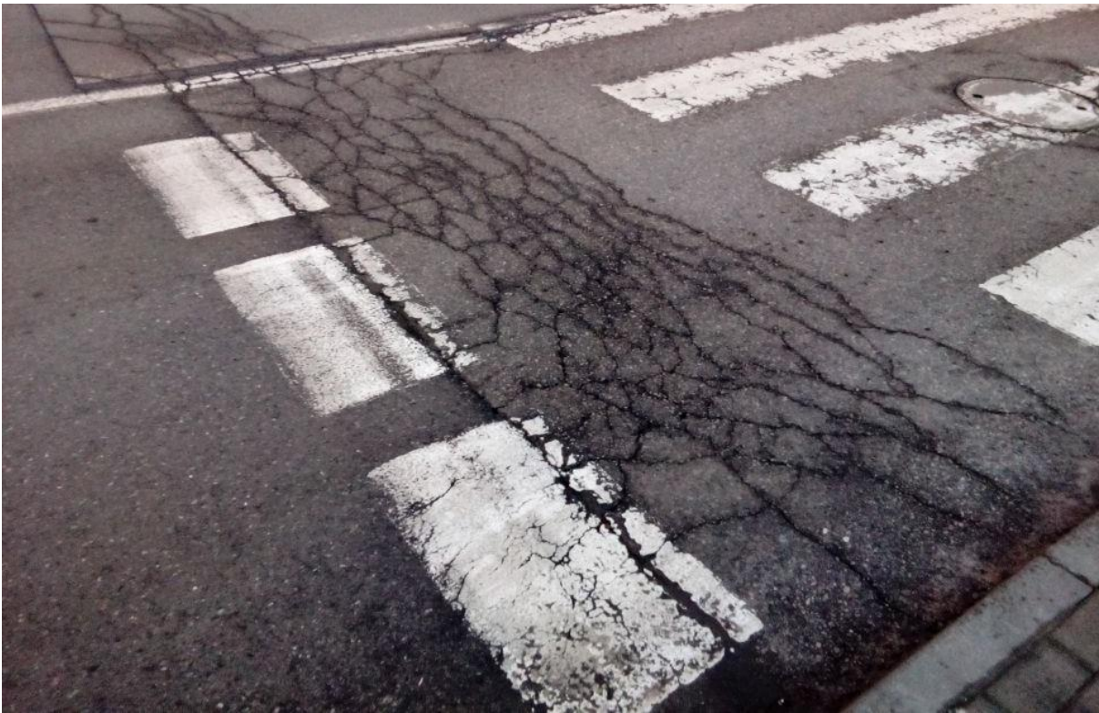
Rys. 5.1.2.5. Przykład spękania zmęczeniowego przy połączeniu technologicznym
