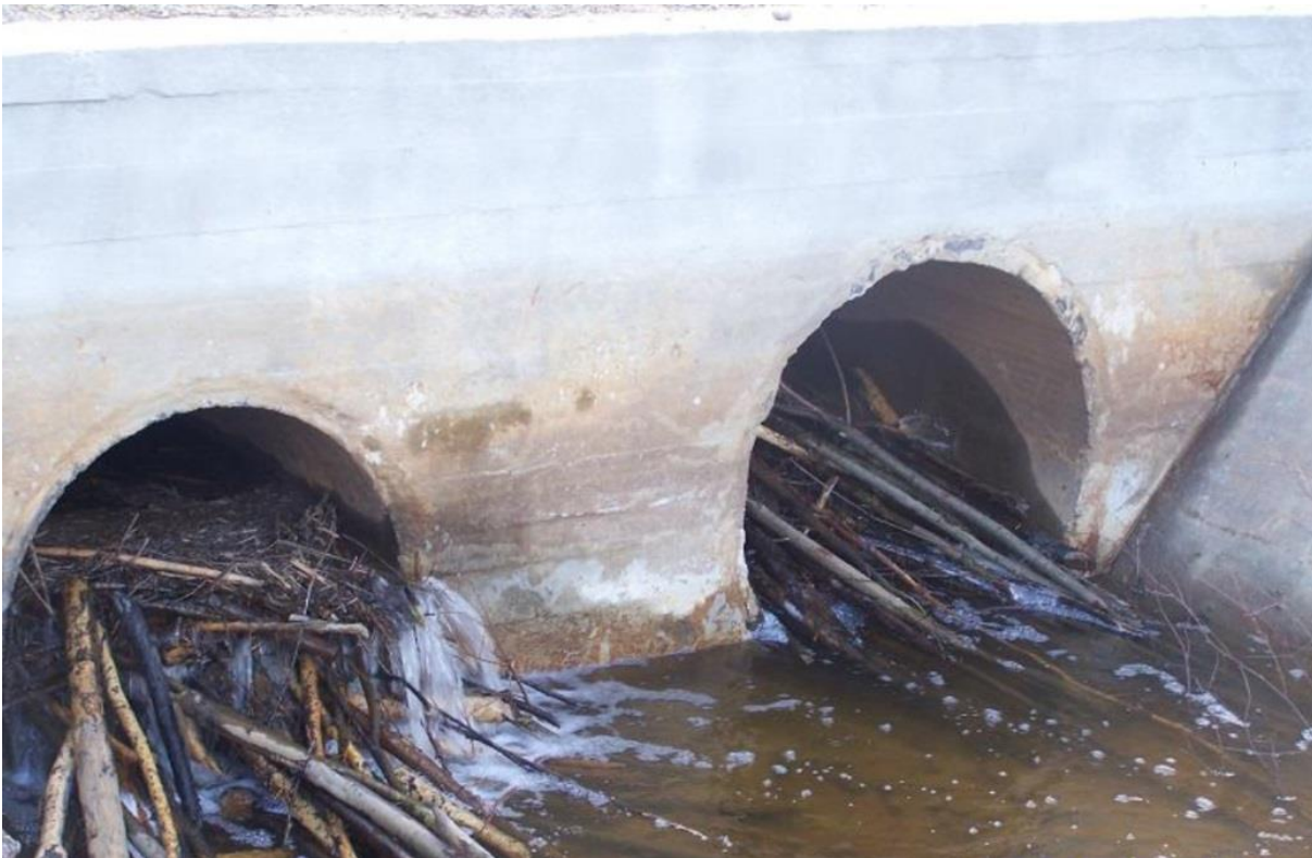
Rys. 7.2.3. Przepusty niedrożne powyżej 30% – stan zły
