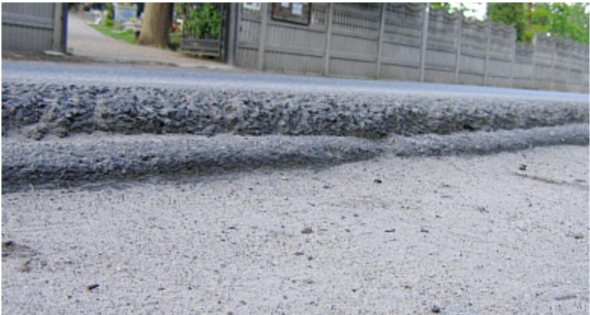
Rys. 7.1.3. Pobocze zaniżone, powstałe w wyniku błędów wykonawczych (brak uzupełnienia)
