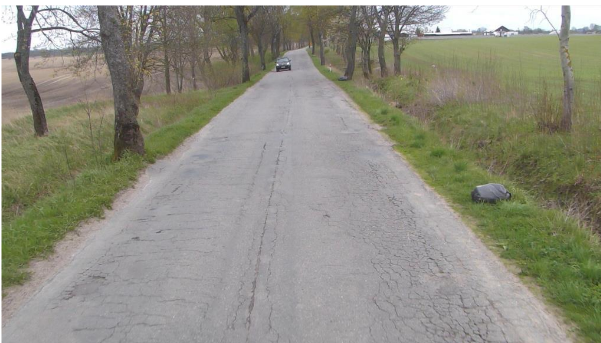
Rys. 5.1.2.4. Stan zły: spękania siatkowe zajmujące ponad 50% powierzchni [3]
