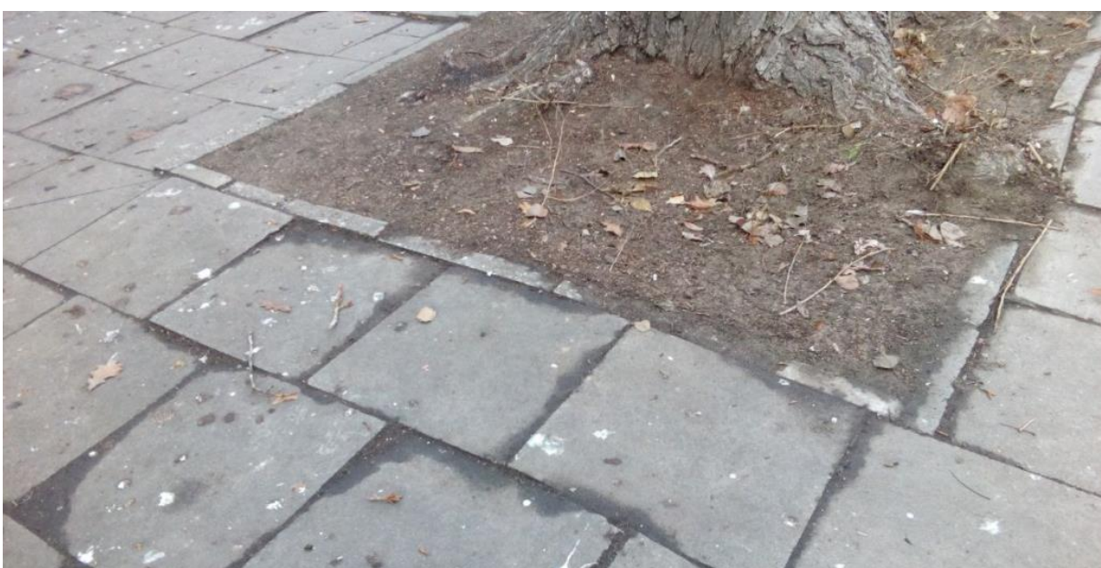
Rys. 6.3. Sfalowania płyt betonowych spowodowane korzeniami drzew
