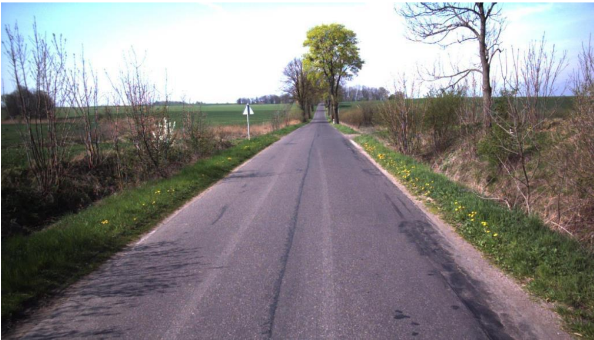
Rys. 5.1.3.6. Stan niezadawalający: łaty oraz spękania zajmujące do 20% powierzchni [3]
