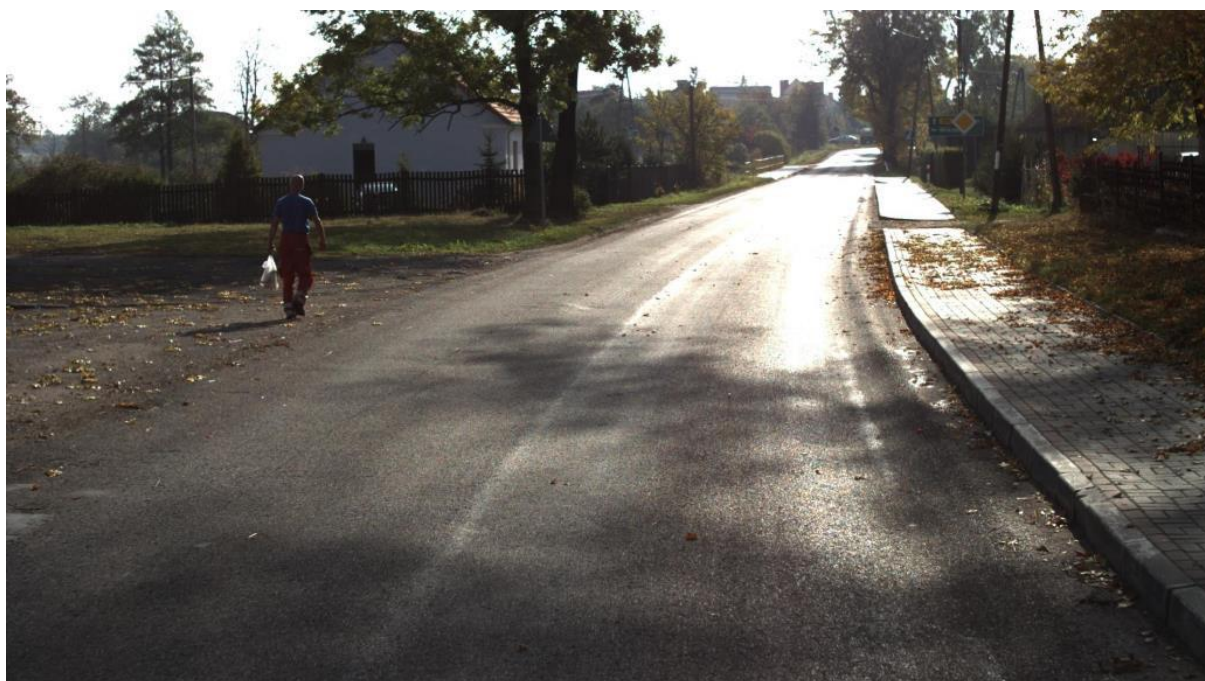
Rys. 5.1.1.4. Stan niezadowalający: widoczna deformacja w śladzie prawego koła – uszkodzenia zajmujące powyżej 10% powierzchni [3]
