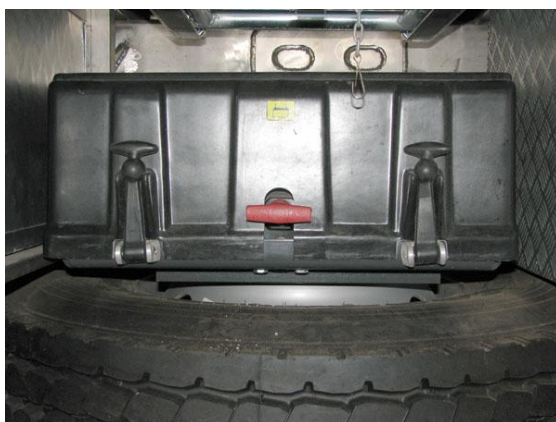
Fotografia nr 5.25. Skrzynka z akumulatorami i wyłącznikiem (foto Jacek Gawroński)
