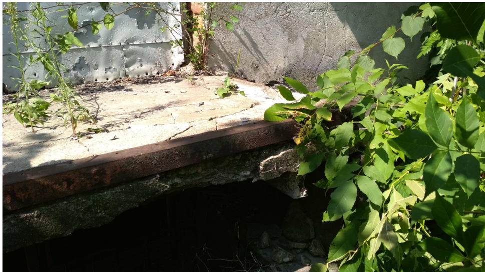
Fot.8 Zniszczony podest wejściowy.
