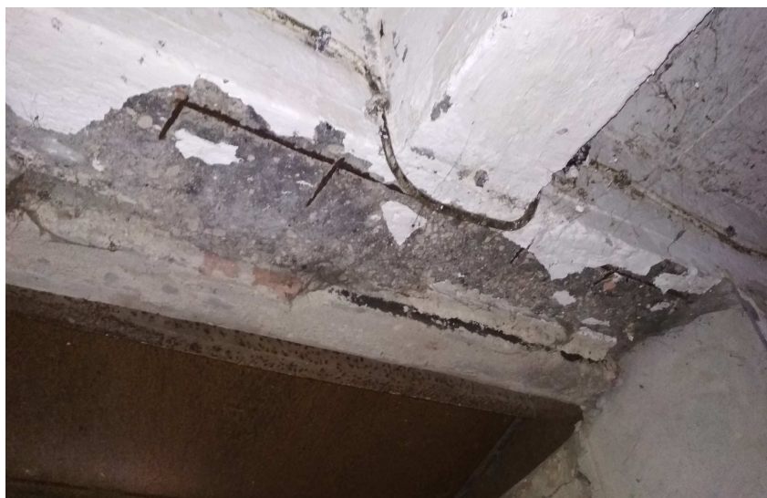
Fot.4 Odspojona otulina zbrojenia nadproża piwnicy.
