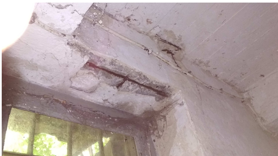
Fot.5 Odspojona otulina zbrojenia nadproża piwnicy.
