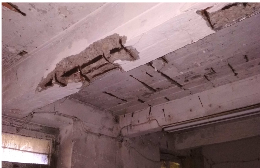
Fot.1 Odstłonięte zbrojenie żebra stropu piwnicy pod rampą.
