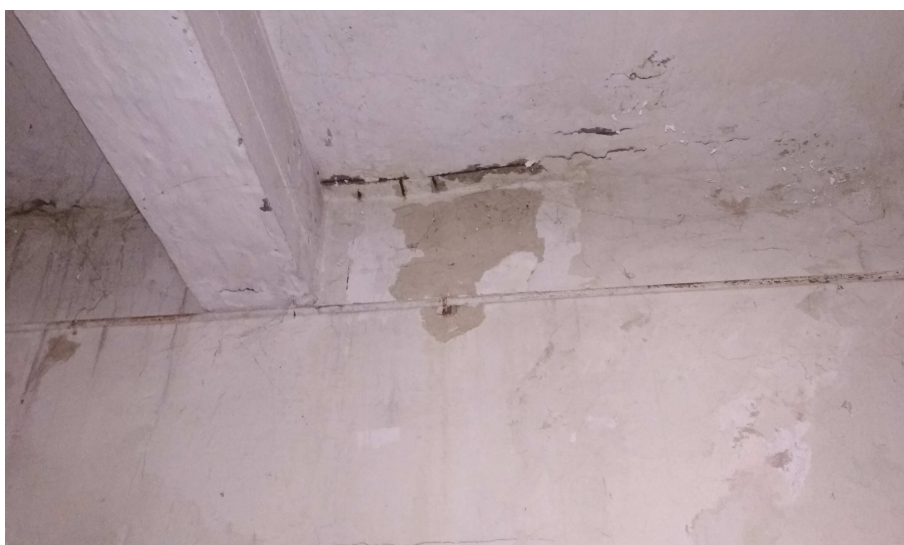
Fot.3 Lokalne odspojenie otuliny stropu nad parterem.
