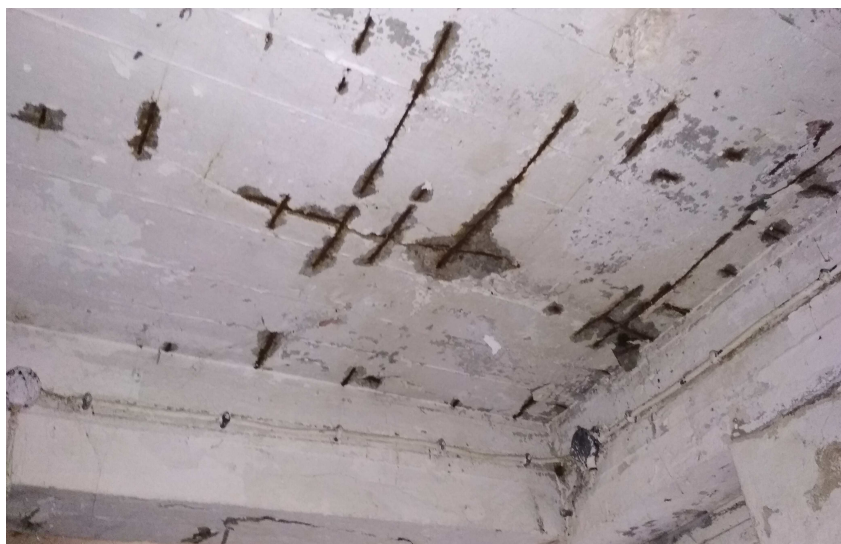
Fot.2 Skorodowane, odstłonięte zbrojenie płyty stropowej piwnicy pod rampą
