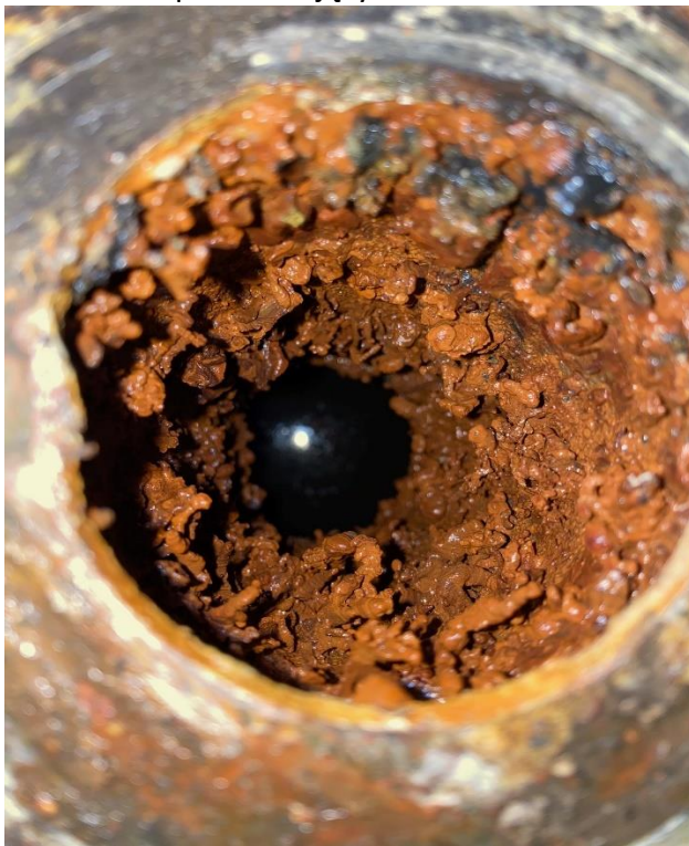
Przewód doprowadzający do zbiornika c.w.u.:
