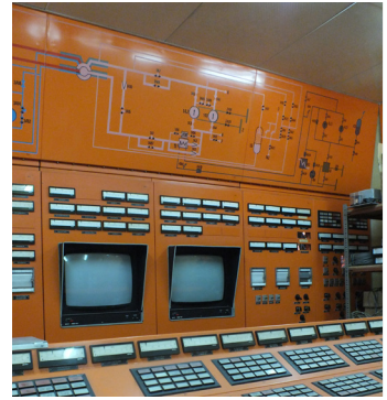
Fot. 10. Sterownia SBM EJ (fot. Łukasz Sawicki)
