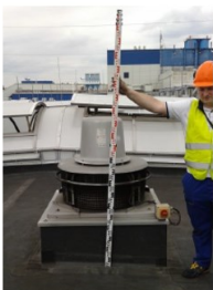
Zdjęcie wentylatora - źródła hałasu
