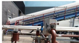
Zdjęcie taśmociągu - źródło hałasu
