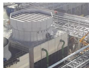
Zdjęcie chłodni wentylatorowej modkrej - źródła hałasu
