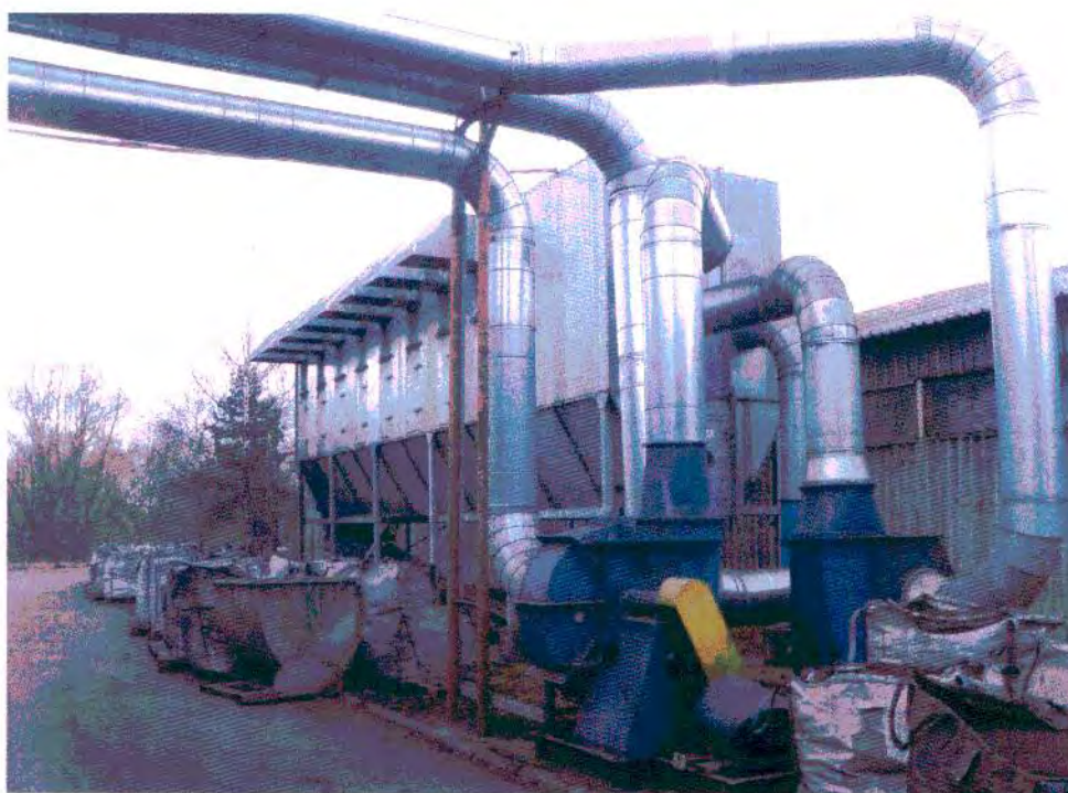
Rys. 10. Widok układu odpylania instalacji Sortowni, Uherce Mineralne, gm. Olszanica: stan z dnia 4 marca 2014 r. [4]
