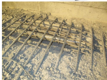
Zarysowanie w miejscu zakrzywienia kabla
