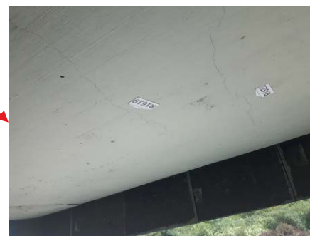
Zarysowanie płyt w obszarze stopniowej mobilizacji sprężenia
