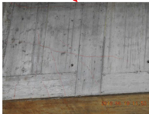
Zarysowanie w miejscu styku segmentów
