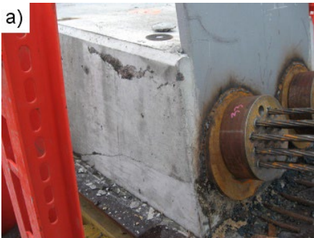
Zarysowanie w obrębie główicy kotwiącej
