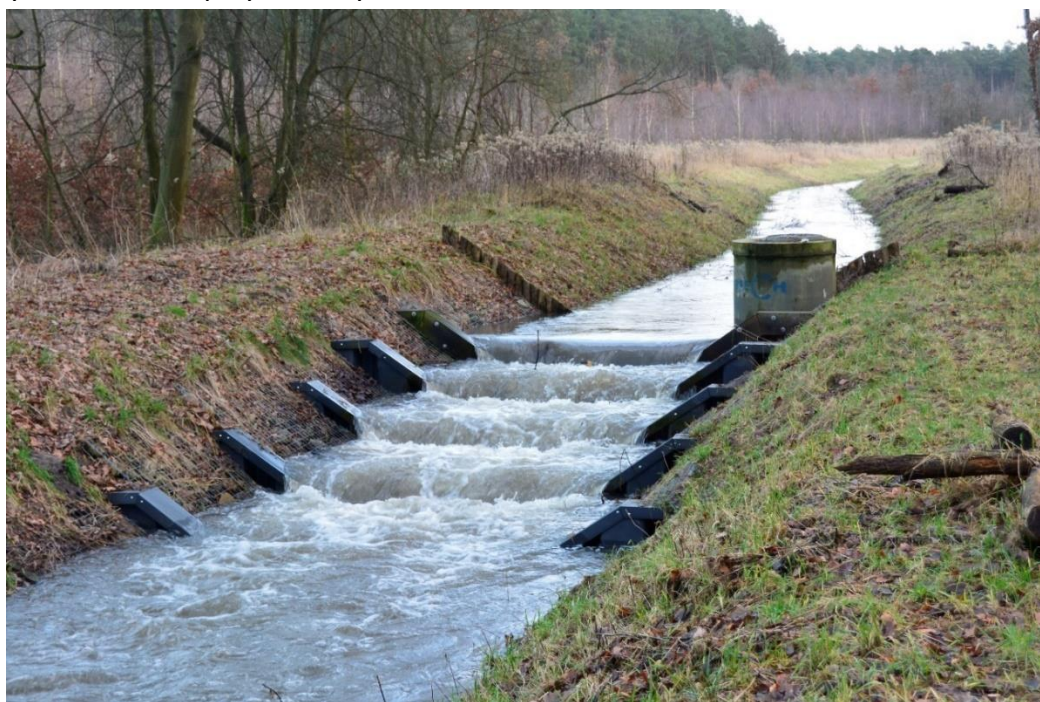
Fotografia 18. Struga Łysomicka z progiem piętrzącym, przepławką (fot. R. Wiesiołek)
