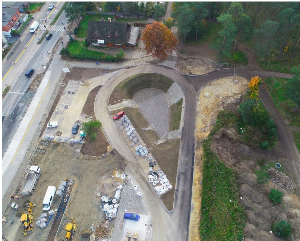
Zbiornik retencyjny przy Węźle Janowo - 1150 m 3
