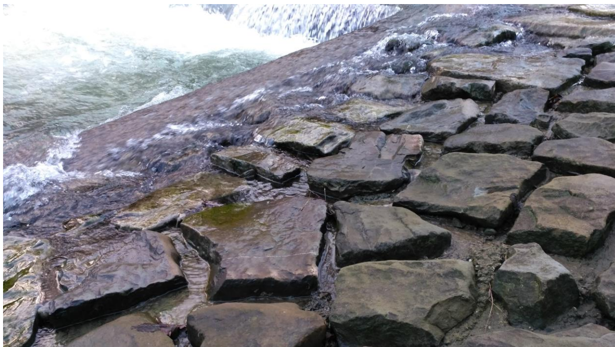
Fot. 7.14 Powierzchnia wykonana w technologii grouted rock (kamień częściowo osadzony w betonie). Fot. I. Biedroń
