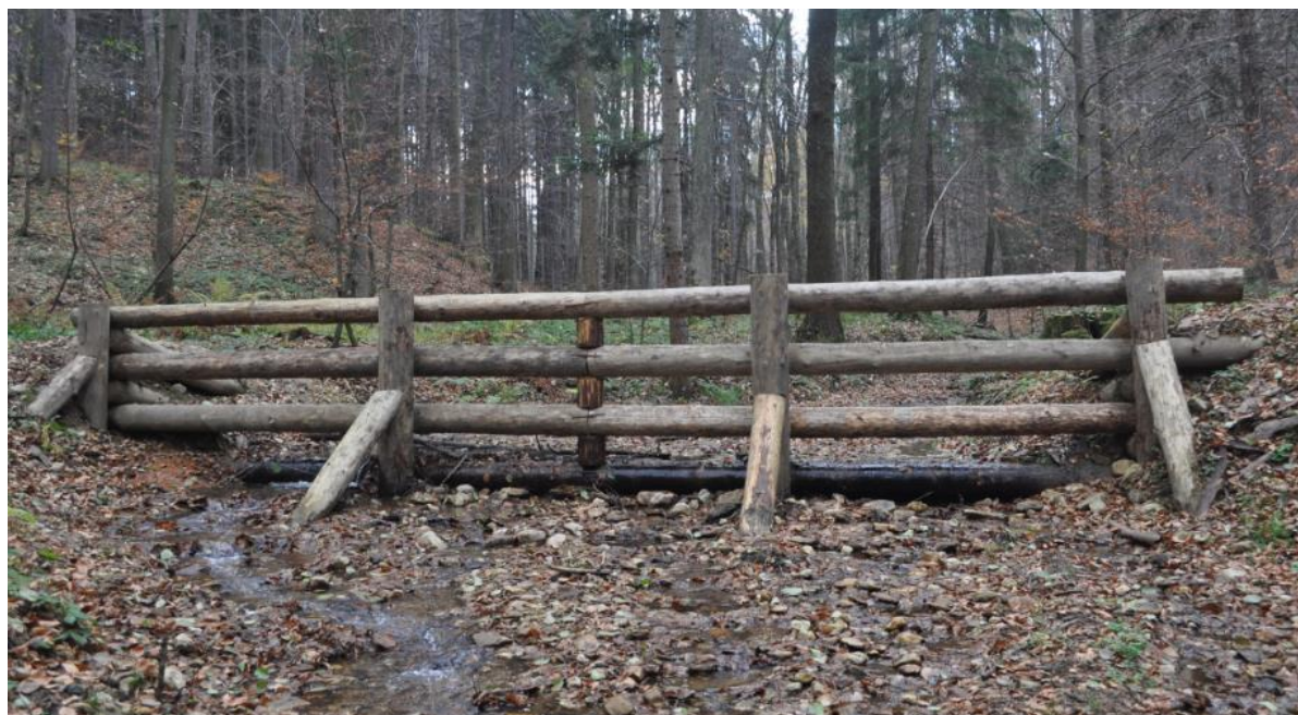
Fot. 7.8 Łapacz rumoszu drzewnego zbudowany na potoku w nadleśnictwie Prudnik, w pobliżu wypływu z lasu. Umożliwia pozostawianie martwych drzew na całym leśnym odcinku potoku, bez stwarzania zagrożenia zatkania przepustów wśród zabudowy poniżej. Źródło: archiwum Lasów Państwowych
