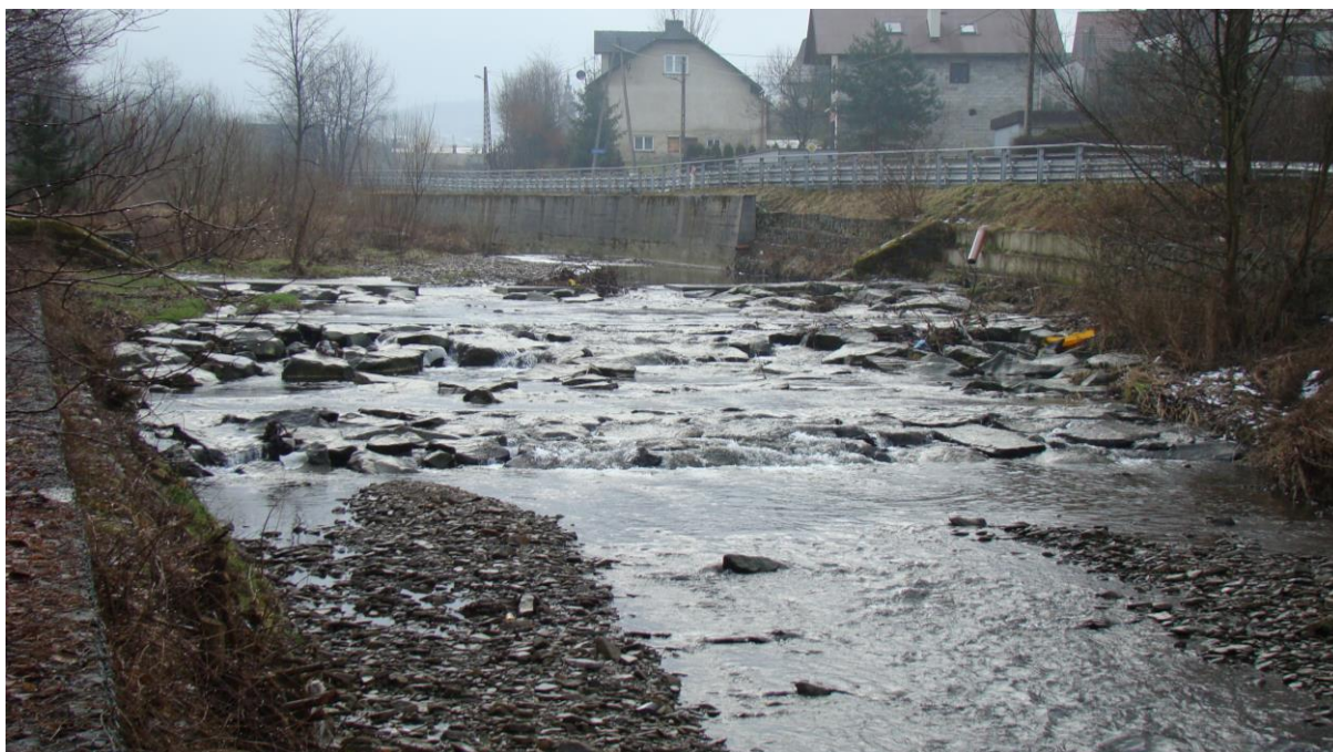
Fot. 1.5 Przebudowany stopień kilkanaście lat po wykonaniu inwestycji na potoku górskim. Fot. K. Wybraniec
