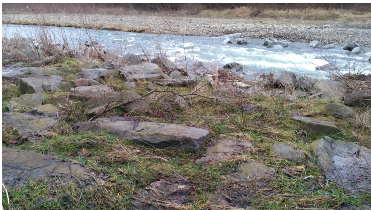
Fot. 2.13 Deflektor ukierunkowujący nurt wykonany przez umieszczenie w korycie rzeki górskiej dużych głazów (Działanie dodatkowe 10), po kilku latach wtopiony już w brzeg i koryto rzeki. Fot. I. Biedroń
