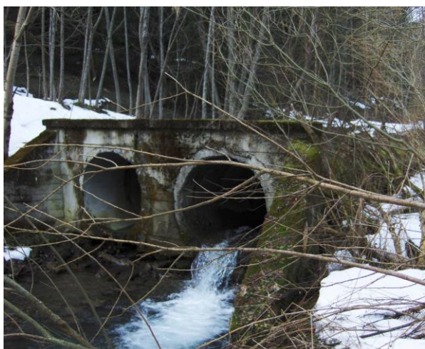
Przeпуск przeznaczony do rozbiórki
