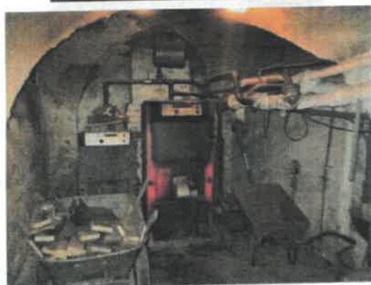
kotłownia w piwnicy
