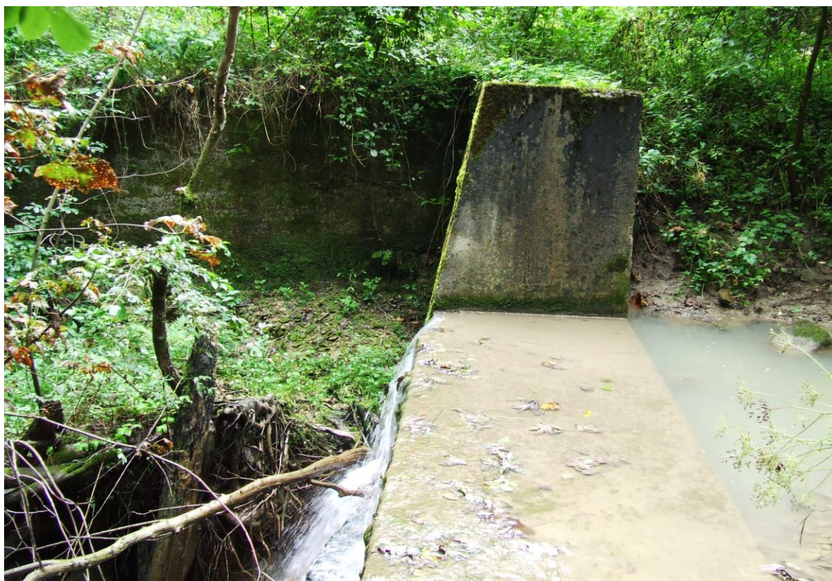
Fot. 23. Potok Hołubla jaz wymagający rozbiórki. Fot. W. Pilch
