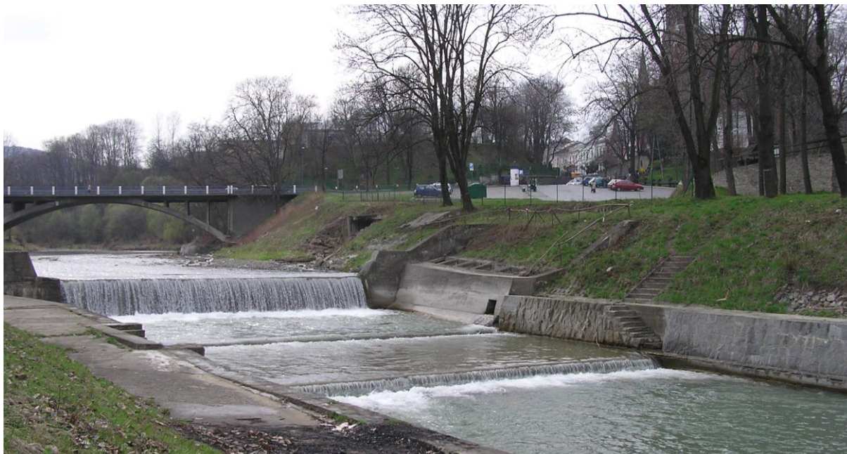
Fot. 19. Stopień na Białej w Grybowie – przed modernizacją. Widoczna kaskada znacząco utrudniająca migrację ryb pod prąd. Źródło: archiwum RZGW w Krakowie
