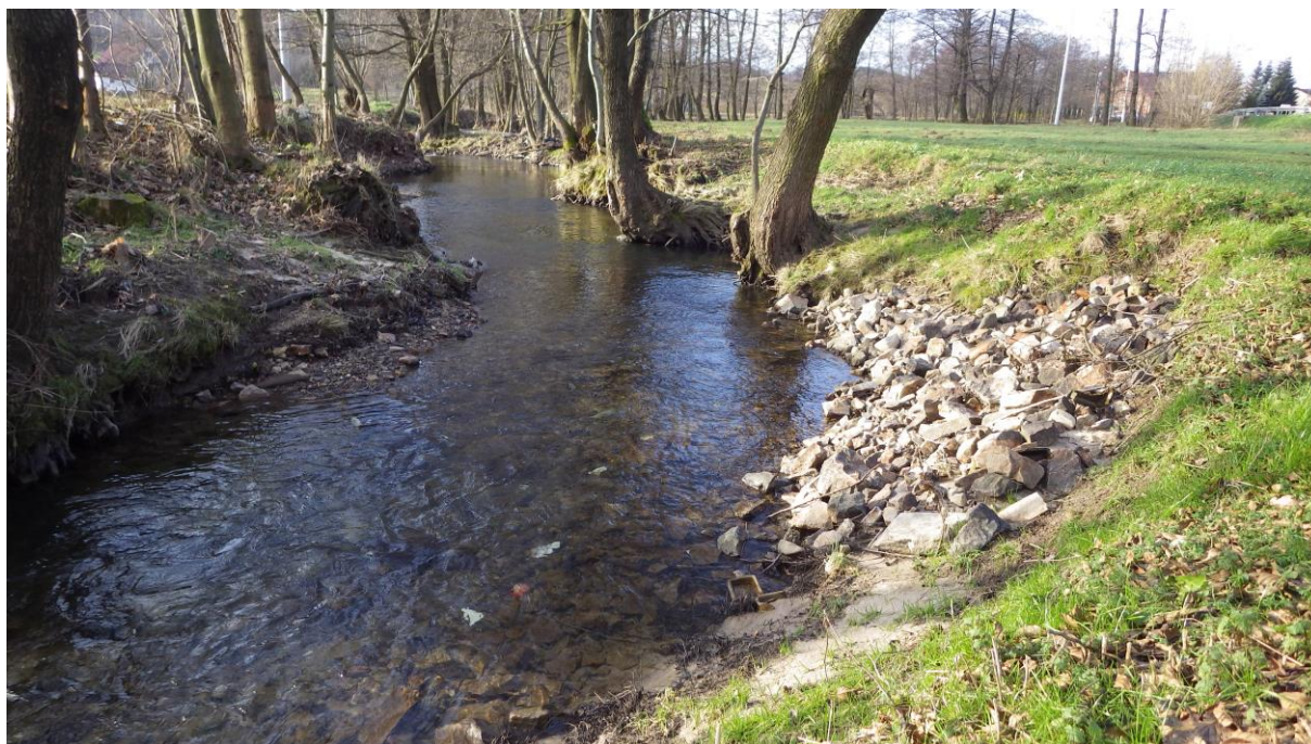
Fot. 4. Punktowe usunięcie wyrwy w brzegu z wykorzystaniem materiału rodzimego pochodzącego z koryta cieku. Zachowane drzewa na brzegach cieku stanowią naturalne zabezpieczenie przeciwoerozyjne. Fot. I. Biedroń
