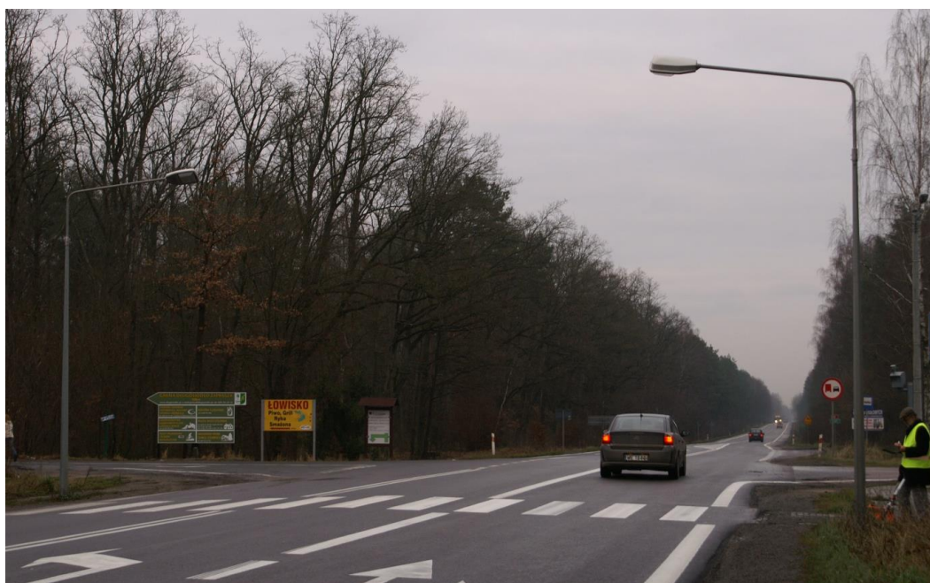
Rys. 3.71 Autonomiczny solarny system oświetlenia przejścia dla pieszych zlokalizowanych na skrzyżowaniu.
