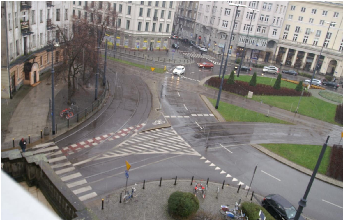
Rys. 3.64 Oświetlenie masztowe na skrzyżowaniu z ruchem okrężnym. Przejście dla pieszych oświetlone pojedynczą oprawą
