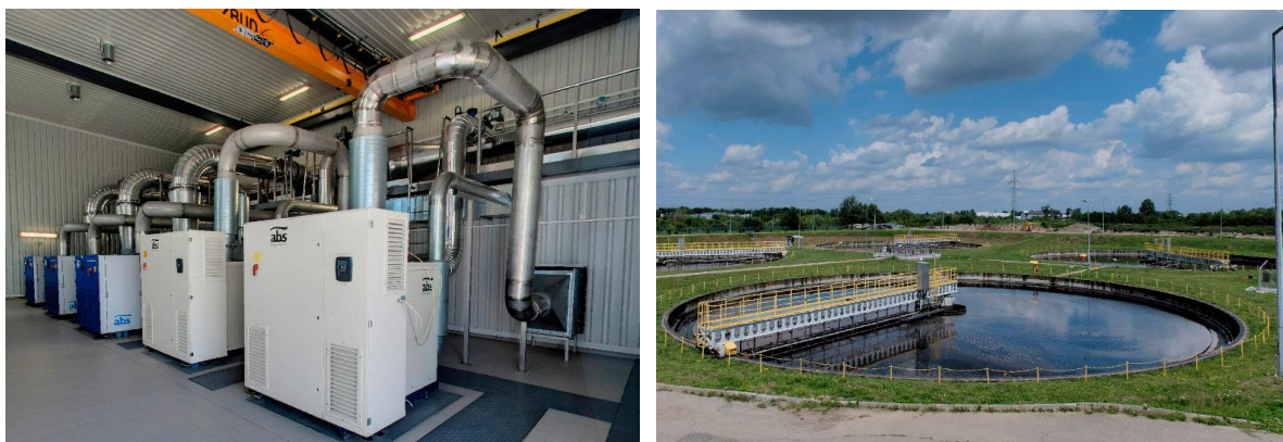
Fot. 5-6. Elementy instalacji w stacji uzdatniania wody należącego do MPWiK w Rzeszowie.
