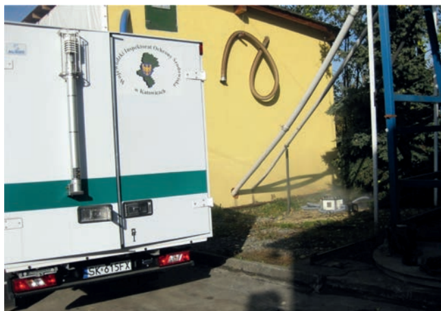
Fot. 1. Sprawdzenie szczelności osadnika wybieralnego z użyciem generatora dymu - lokalizatora przyłączy kanalizacyjnych
