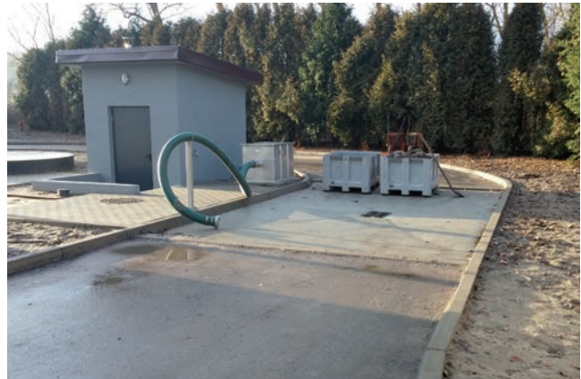
Fot. 16. Pompownia ścieków surowych oczyszczalni w Świerklańcu po modernizacji
