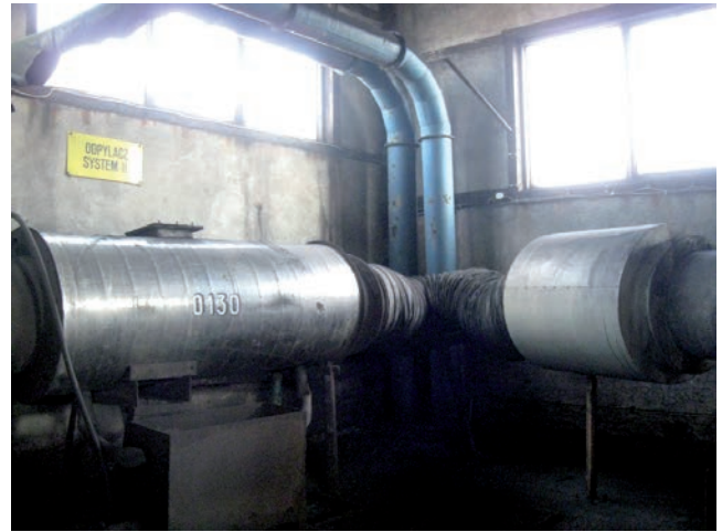
Fot. 2. Wytlumienie uławiaczy pyłu na stacji przygotowania KW S.A., Oddział KWK „Jankowice”
