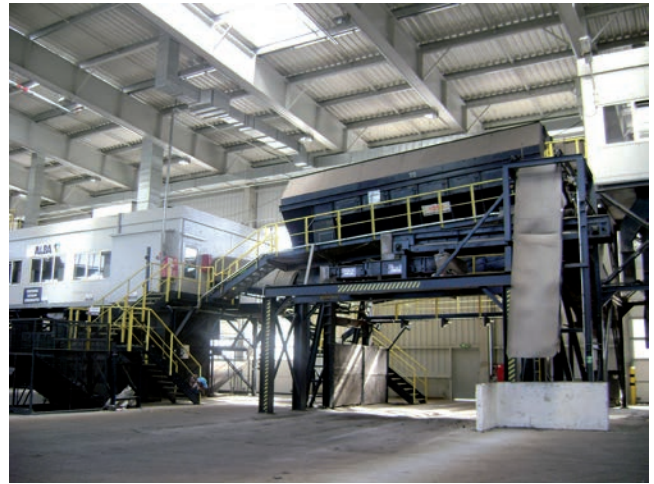
Fot. 2. Instalacja do sortowania odpadów komunalnych
