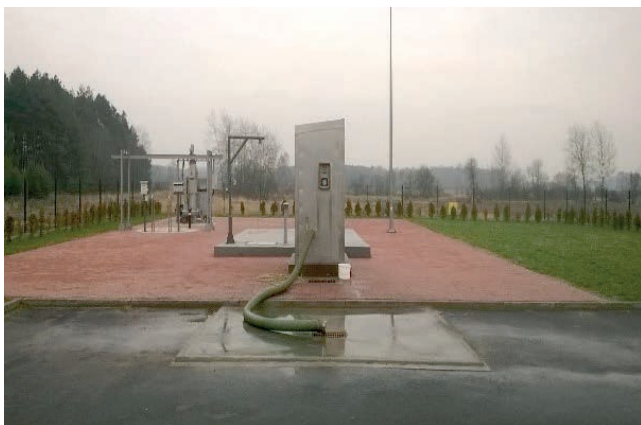
Fot. 13. Punkt zlewny ścieków dowożonych oczyszczalni w Ożarówicach
