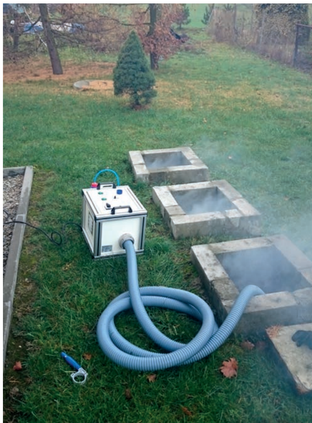
Fot. 3. Sprawdzenie szczelności osadnika wybieralnego z użyciem generatora dymu - lokalizatora przyłączy kanalizacyjnych
