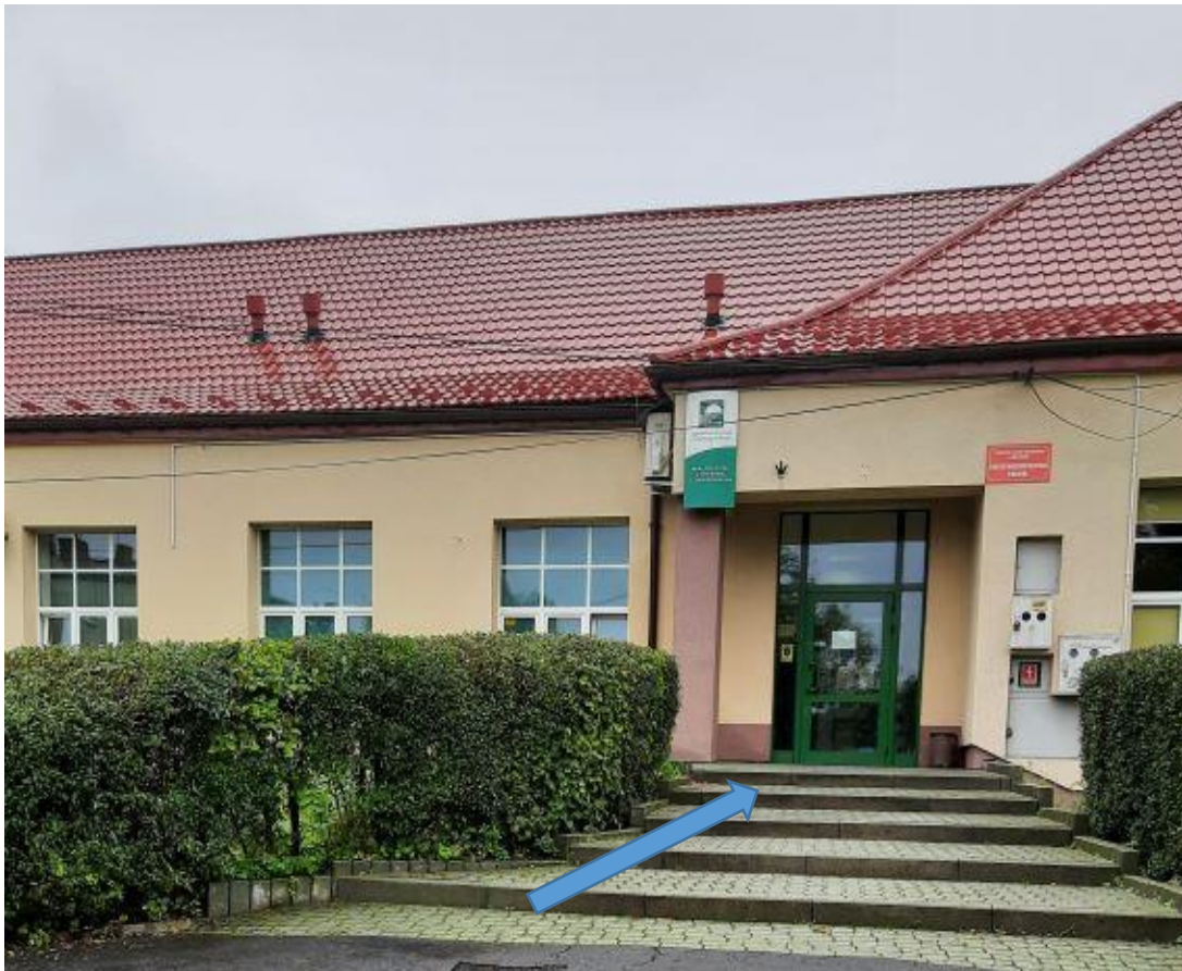
Wyjście ewakuacyjne / wejście boczne od strony zachodniej z podjazdem dla osób z niepełnosprawnościami.
