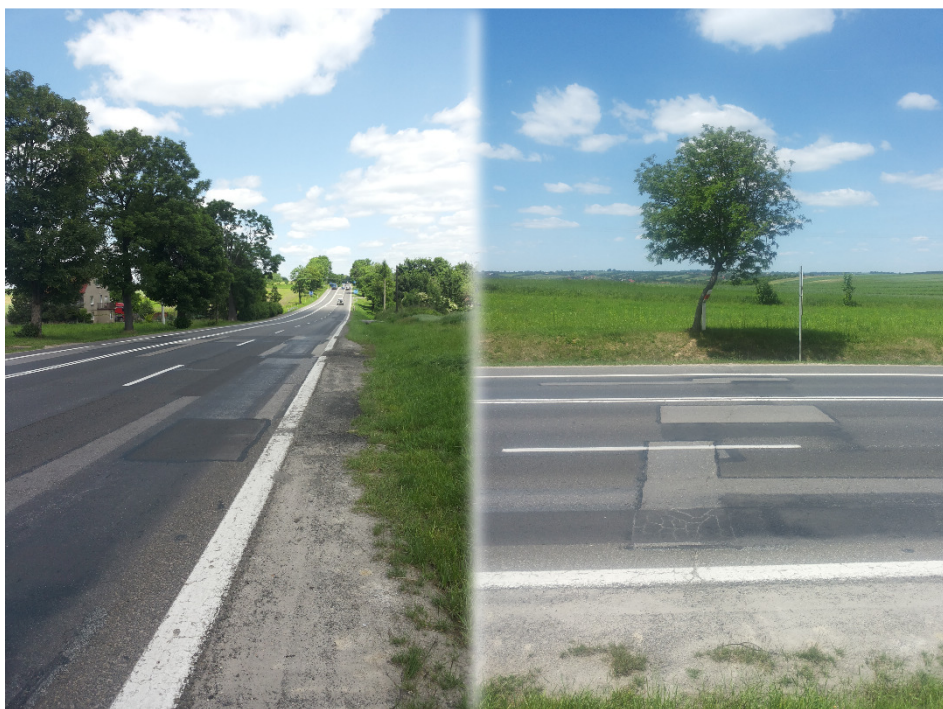
Rys. 7.15. Zły stan nawierzchni drogi krajowej nr 7 wzdłuż analizowanego poligonu nr 1
