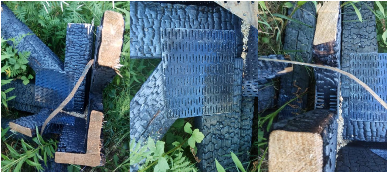
Fot. 22 a-c: Zdjęcie elementu spalonej konstrukcji dachu, porzuconego w pobliżu budynku. Widać konfigurację elementów oraz sposób łączenia. Wykorzystano tu tzw. „płytkę kolczastą”, która doskonale łączy elementy drewniane, jednak poddana oddziaływaniu pożaru może szybko doprowadzić do katastrofy budowlanej!
