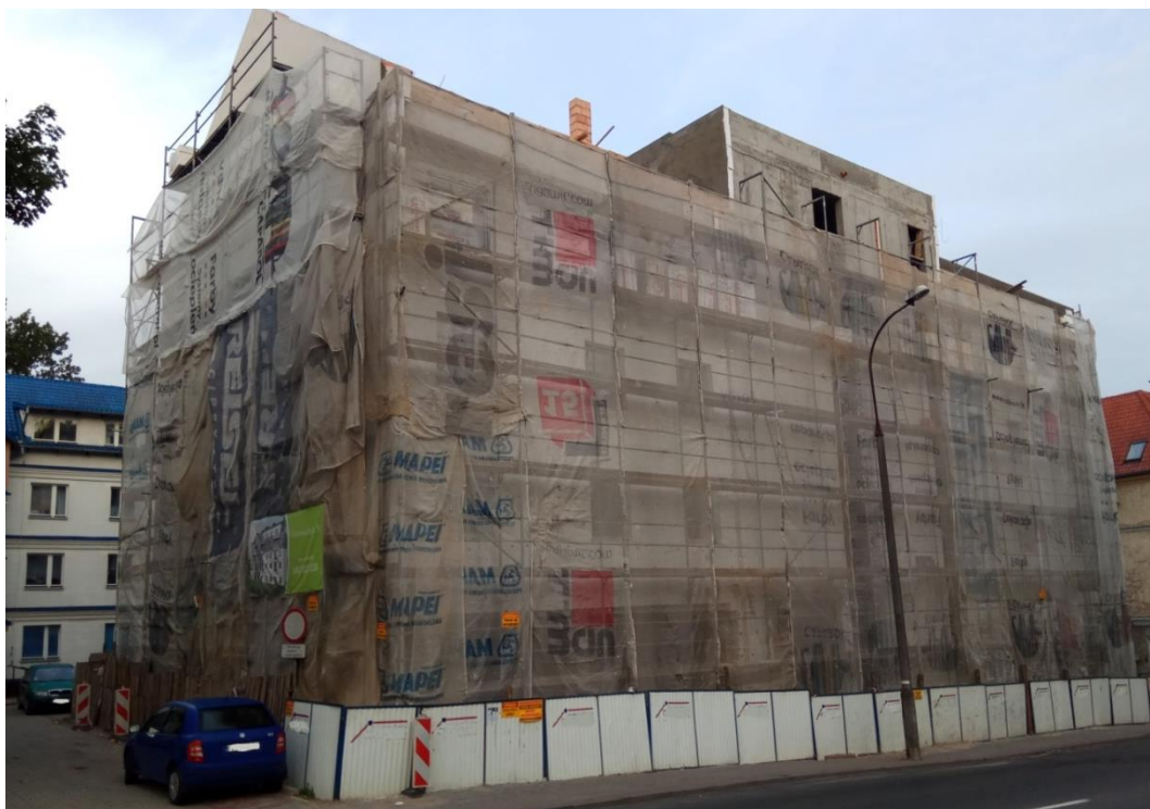
Fot. 34: Rozpoznanie cech charakterystycznych budynku: obiekt w remoncie. Brak dachu oraz okien. Odsonięta drewniana więźba, niestabilne elementy na poziomie dachu (komin murowany). Wokół budynku rusztowanie o częściowo palnej konstrukcji pokryte palnym materiałem (siatki). W pobliżu budynku zaparkowany samochód osobowy dodatkowo ograniczający możliwość manewrowania pojazdom pożarniczym. Obiekt całkowicie ogrodzony, z utrudnionym dostępem.
