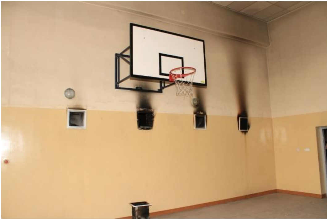
Fot. 54: Widok kanałów wentylacyjnych łączących salę gimnastyczną z pomieszczeniem, w którym powstał pożar. Ślady okopcenia pokazują, którędy gazy z ogniska pożaru wędrowały do sali, tworząc ostatecznie warstwę gorących palnych gazów do około połowy wysokości pomieszczenia.
