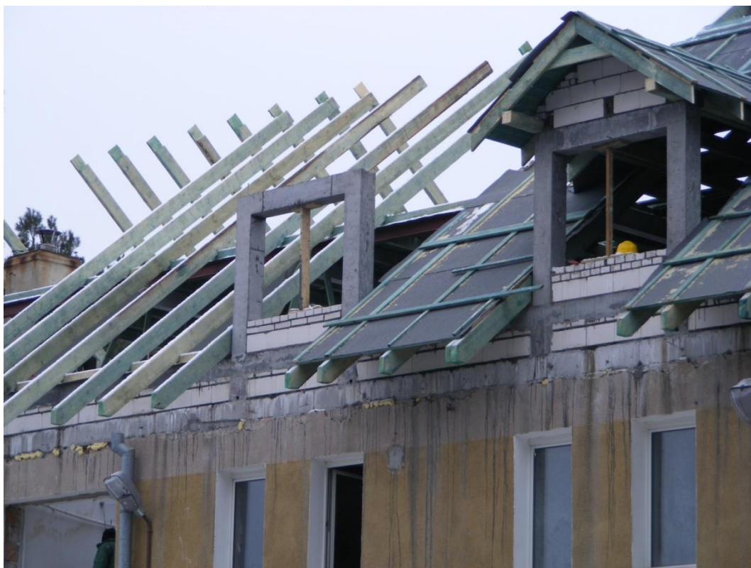
Fot. 23: Spadziste dachy kryją wiele ukrytych przestrzeni, w których może dochodzić do niekontrolowanej migracji dymu lub do pożarów ukrytych. Zdjęcie wykonane w trakcie rozbudowy budynku o dodatkowe piętro (fot. KW PSP w Olsztynie)
