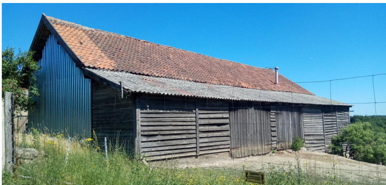
Fot. 35: Obiekt o nieuszczelnej oraz palnej konstrukcji. Duże prawdopodobieństwo przejścia w pożar blokowy, czyli pożar całego obiektu: w środku, na zewnątrz oraz elementów konstrukcyjnych. Obiekt posiada również ścianę z blachy jak w halach przemysłowych. Ten niepalny materiał dobrze przewodzi energię cieplną.
