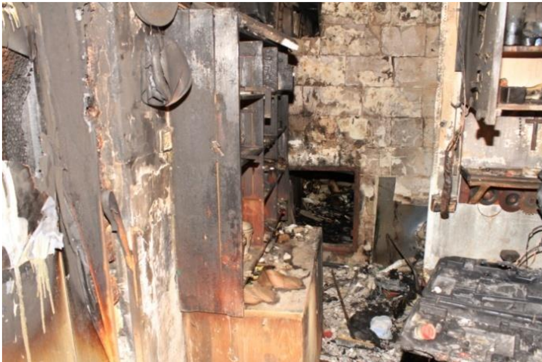
Fot. 55: Ponownie widok na pomieszczenie, w którym powstał pożar. Widać pozostałości materiałów palnych za ścianą na wprost a także inne otwory, którymi dym rozpoczął wędrówkę w oddalone obszary budynku. Znaczna gęstość obciążenia ogniowego sprzyjała wzmożonej produkcji paliw gazowych.
