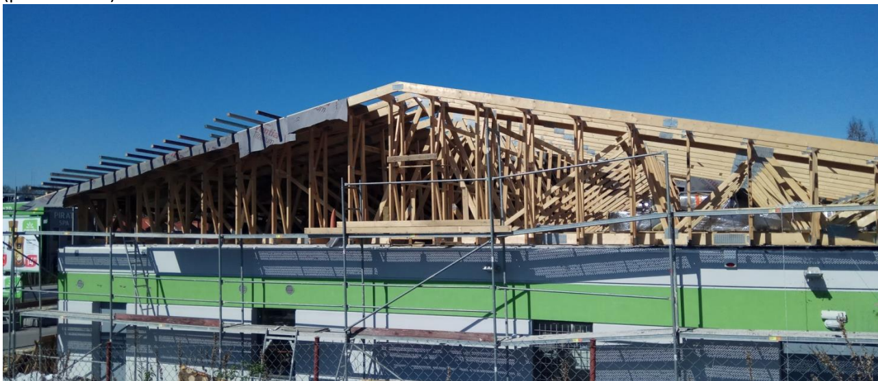
Fot. 14: Puste ukryte przestrzenie w przestrzeni dachowej dyskontu spożywczego. Zdjęcie wykonano w trakcie remontu po pożarze dachu. W momencie przedostania się dymu do przestrzeni pod połacią dachu, jego migracja jest praktycznie nieograniczona i może on rozprzestrzeniać się w bardzo dużej kubaturze. Takie przestrzenie, w których gazy pożarowe mogą się kumulować występują ponadto w różnych obszarach obiektów: szybach i kanałach wentylacyjnych czy technicznych, podwieszanych sufitach i innych obszarach, do których dym może przenikać. Zobacz też fot. 20 oraz fot. 21 .
