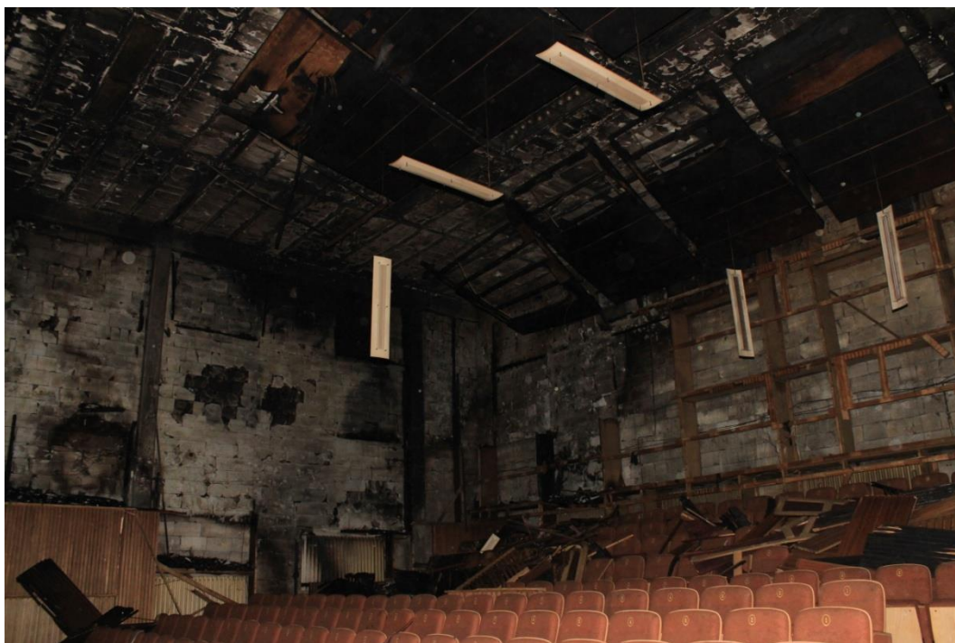
Fot. 25: Skutki pożaru palnej konstrukcji ścian, sufitu i wyposażenia w sali koncertowej budynku Szkoły Muzycznej w Elblągu w dniu 18 stycznia 2014 roku. (fot. KM PSP w Elblągu)
