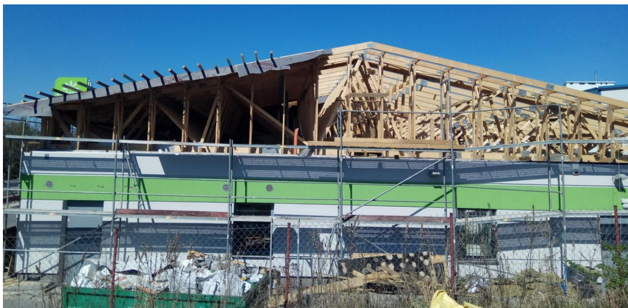
Fot. 20: Palna konstrukcja dachu dyskontu spożywczego: zagrożenie zajęciem się konstrukcji oraz migracją dymu. Zdjęcie wykonano w trakcie remontu wynikającego z pożaru konstrukcji dachowej. Dla porównania, na kolejnym zdjęciu ( Fot. 21 ) pokazano również stan po remoncie. Bez znajomości podstaw konstrukcji obiektów świadomość obecności omawianych zagrożeń może nie być oczywista.
