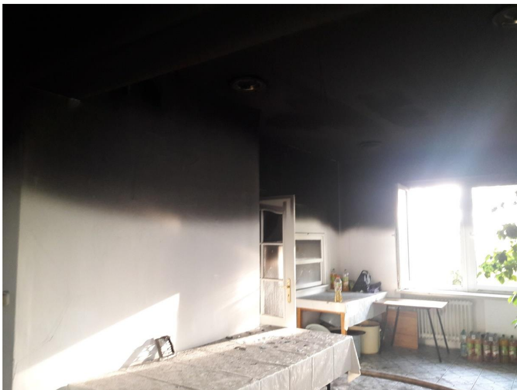
Fot. 50: Zdjęcie po pożarze w lokalu mieszkalnym. Widoczny na ścianie ślad okopcenia wskazuje, na jakiej wysokości znajdowała się płaszczyzna neutralna. W tym pożarze, strażacy przebywający przy ziemi nie mieli ograniczonej przez dym widoczności. Jednocześnie poziom zadymienia umożliwił wydostawanie się dymu przez okno oraz dostarczanie przez nie powietrza do wnętrza (przepływ dwukierunkowy). Duża wysokość linii okopcenia wskazuje na szybkie opanowanie sytuacji przez strażaków (fot. KP PSP w Nowym Tomysłu)
