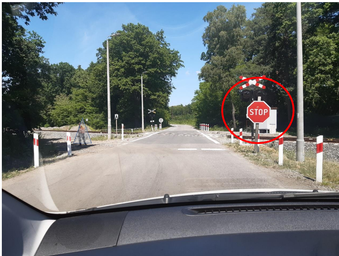
Zdjęcie 8 – Znak B-20 przysłaniający tabliczkę „sygnalizacja nieczynna”
