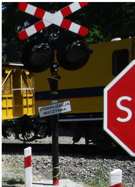
Zdjęcie 7 – Tabliczka „sygnalizacja nieczynna” na sygnalizatorze drogowym
