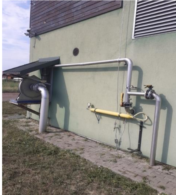
Fot. 2.2. Widok instalacji gazowej na stanowisku sprężania gazu. Sprężarka gazu o max poborze mocy 2,5 kW i wydajności znamionowej 5 m 3 /h (w temp. 15°C i 200 barów, przy ciśnieniu gazu na wlocie 0,1 bara) [materiały własne]
