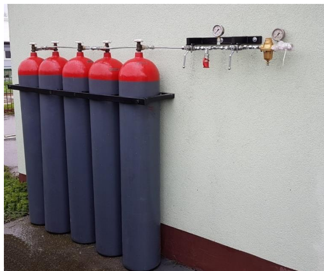
Fot. 2.3. Widok podłączenia butli do zasilania biogazem [materiały własne]
